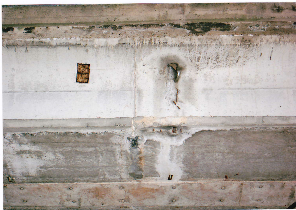
Obr.B45-849 Levá fasáda NK v polovině rozpětí 2. pole. Pohled doprava a vzhůru, - zatékání na fasádu a podhled NK zpod římsy a hlavně z nezapraveného montážního otvoru.
