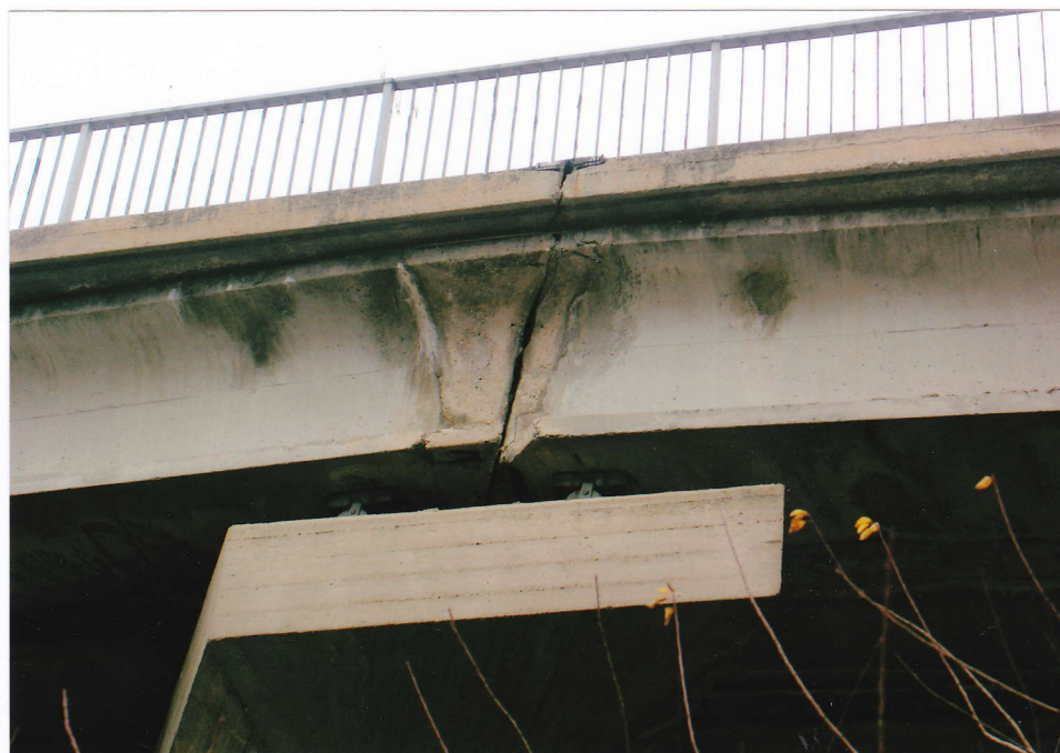
Obr.B45-837 Čela dobetonávek/podporových příčníků na pravé fasádě nad 2. podpěrou. Pohled doleva a vzhůru, - zatékání přes římsu na fasádu a podhled NK. Oddělování dobetonávek/příčníků od čel nosníků, zatékání do nebezpečné oblasti kotev předpjaté výztuže. Trhliny v římsě, inkrustace.
