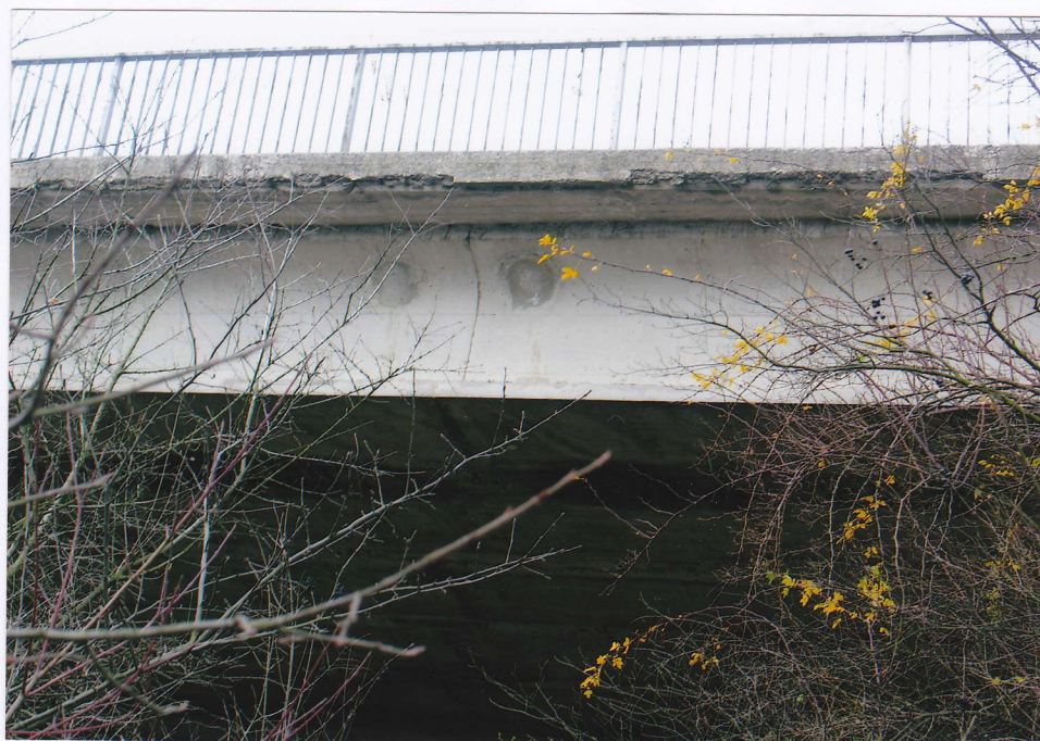
Obr.B45-145 Pravá fasáda NK ve 3. poli. Pohled doleva a vzhůru, - zatékání na fasádu a podhled NK zpod římsy s olámaným okapovýmnosem.
