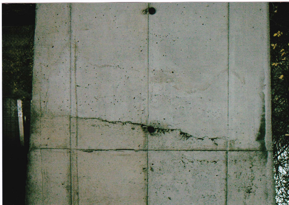
Obr.B45-877 Zadní strana třetího sloupu 4., mezilehlé podpěry. Pohled proti směru staničení, k Černé Hoře, - výrazná vodorovná trhлина souvisí s nezvládnutou pracovní párou v těch místech a se zatékáním shora.
