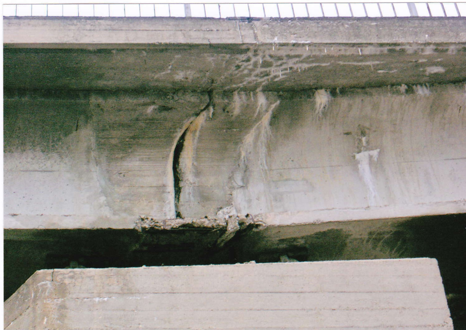
Obr.B45-835 Čela dobetonávek / podporových příčníků na levé fasádě nad 2. podpěrou. Pohled doprava a vzhůru, - zatékání přes římsu na fasádu a podhled NK. Oddělování dobetonávek/příčníků od čel nosníků, zatékání do nebezpečné oblasti kotev předpjaté výztuže. Trhliny v římsě, inkrustace, místy i ve formě krápníků.
