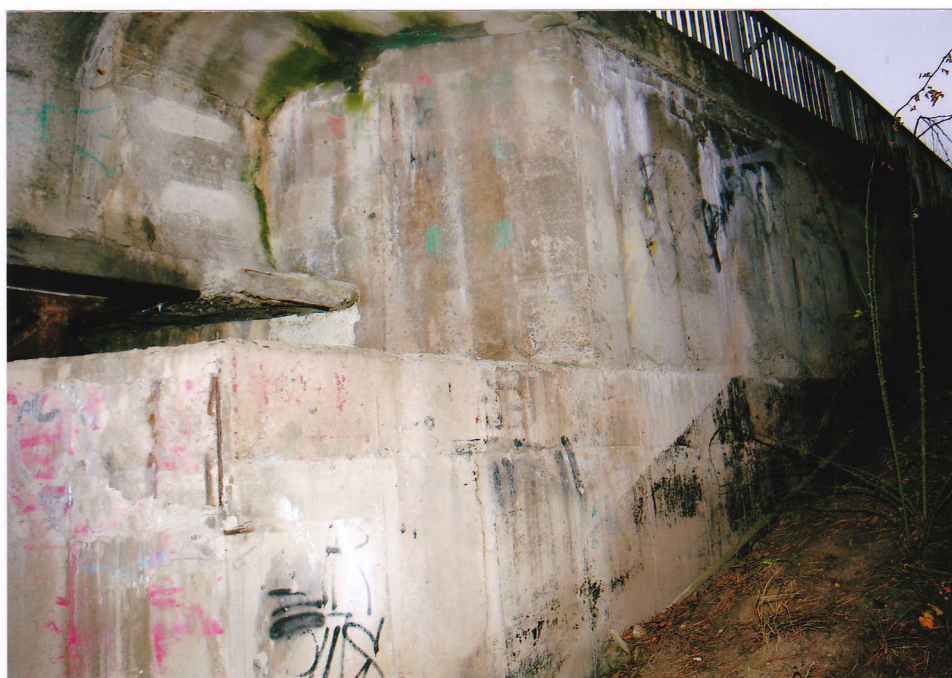
Obr.B45-817 Levé křídlo 1. podpěry, černoohorské opěry. Pohled doprava a k Černé Hoře, - křídlo a levý konec opěry nese stopy po rozsáhlém zatékání přes nadlehlé konstrukce, přes mostní závěr a zpod římsy, - svahový kužel poklesl hlavně díky erozivní činnosti vody která nejprve rozebrala svahový skluz na této nižší polovině vozovky, viz obr. v odstavci odvodnění.
