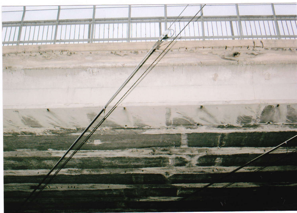
Obr.B45-850 Pravá fasáda NK před polovinou rozpětí 2. pole. Pohled doleva a vzhůru, - zatékání na fasádu a podhled NK zpod římsy s olámaným okapovýmnosem.
