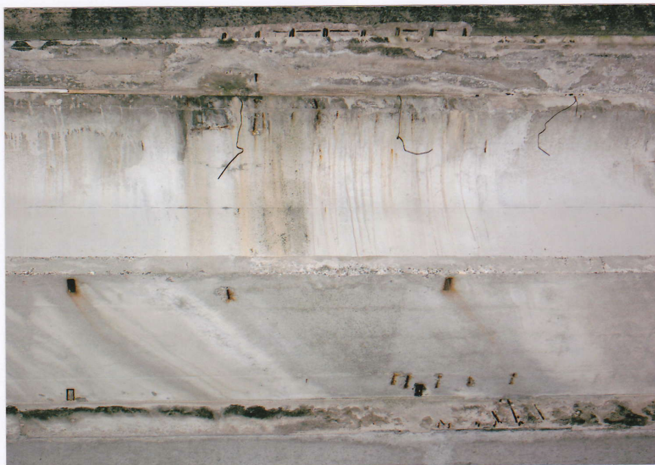
Obr.B45-851 Pravá fasáda NK za polovinou rozpětí 2. pole. Pohled doleva a vzhůru, - zatékání na fasádu a podhled NK zpod římsy s olámaným okapovýmnosem.
