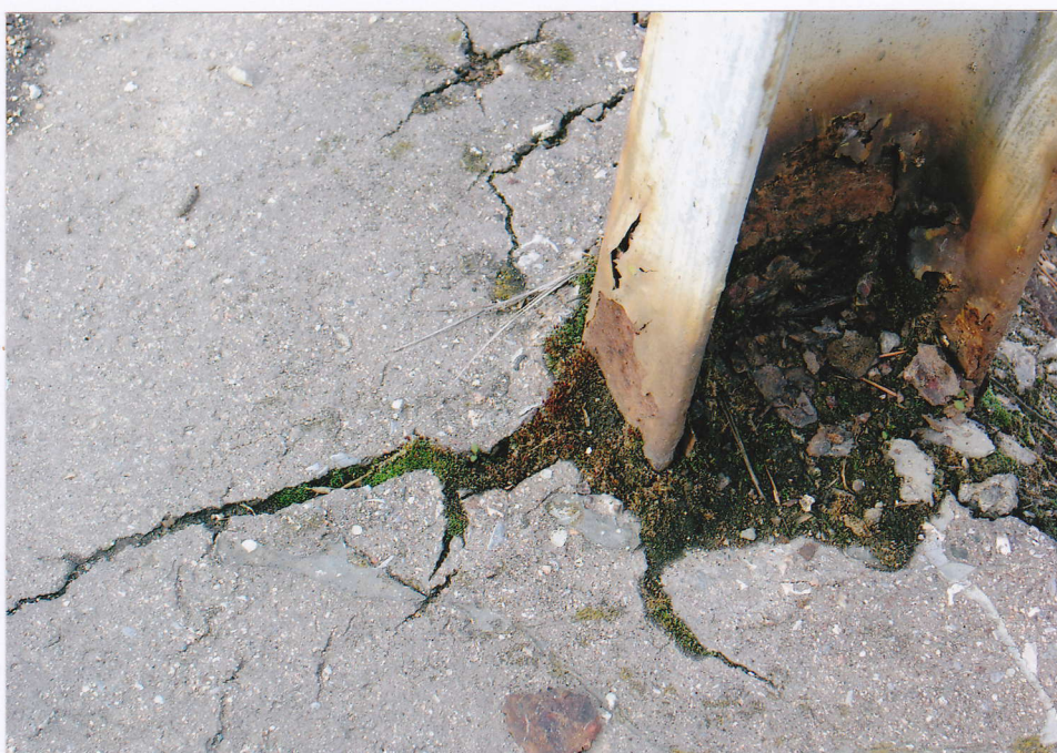
Obr.B45-128 Příklad koroze paty svodidlového sloupku a zvedání krytu chodníku díky pronikání vody do jeho podloží v zimních měsících,
