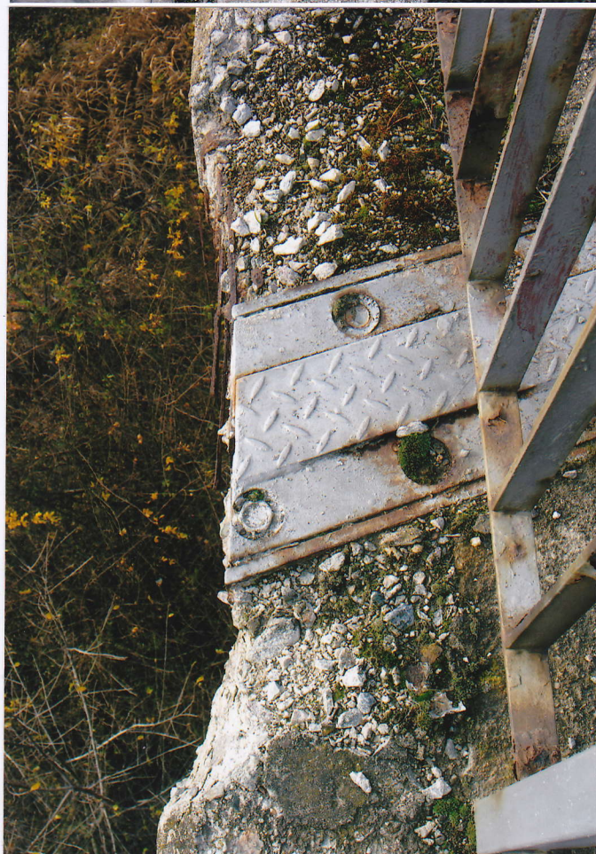
Obr.B45-132 Pravostranná římsa nad 4. podpěrrou. Pohled proti směru staničení k Černé Hoře a dolů,
