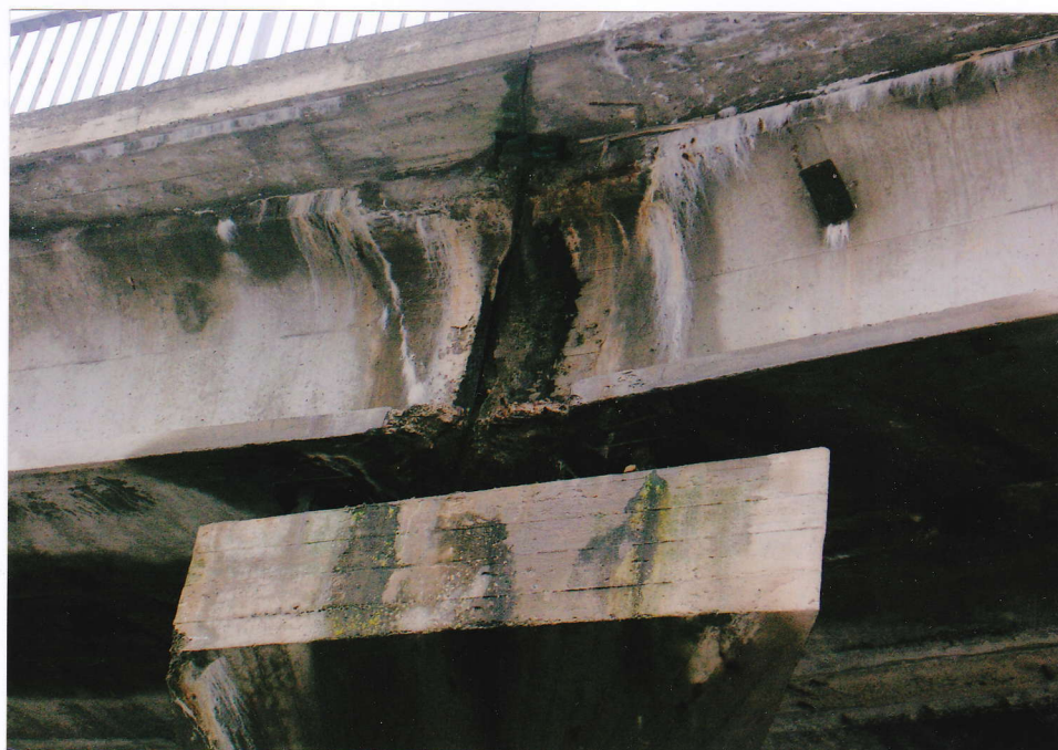
Obr.B45-840 Čela dobetonávek / podporových příčníků na levé fasádě nad 3. podpěrou. Pohled doprava a vzhůru, - zatékání přes římsu na fasádu a podhled NK. Oddělování dobetonávek/příčníků od čel nosníků, zatékání do nebezpečné oblasti kotev předpjaté výztuže. Trhliny v římse, inkrustace, místy i ve formě krápníků, - škody i na konci úložného prahu.
