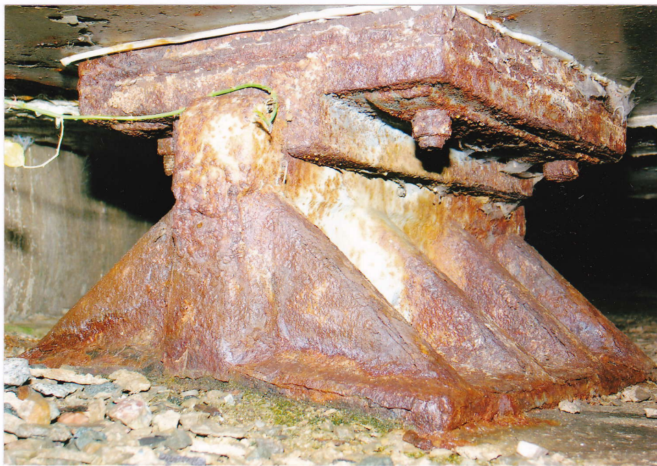
r.B45-881 Pevné ložisko pod 1. nosníkem, na levém konci 5. podpěry. Pohled ke Sloupu a doprava, ložisko je silně korodované s oslabením do 3 mm, podobně jako i další ložiska na této nižší straně mostu, temeno UP je relativně čisté.
