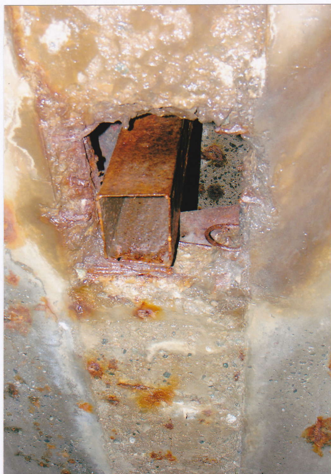
Obr.B45-888 Odpadní trouba posledního mostního ovodňovače (ve 4. poli). Pohled přímo vzhůru, - odpadní trouba není litinová, koroduje, zatím bez rozpadu. Dolní spára mezi nosníky I-73 není v jeho okolí zabetonována.
