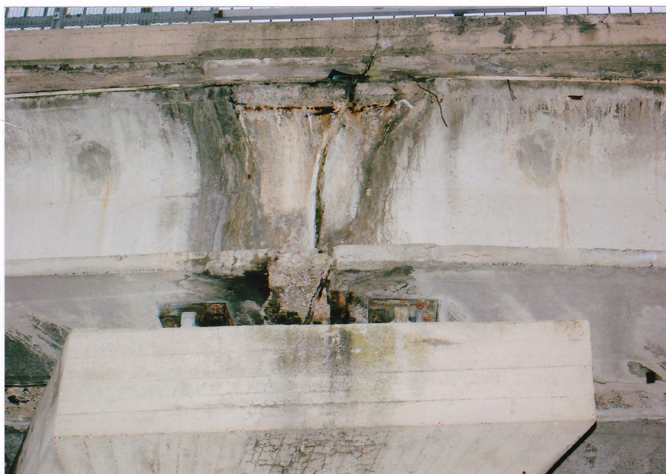
Obr.B45-843 Čela dobetonávek/podporových příčníků na pravé fasádě nad 3. podpěrou. Pohled doleva a vzhůru, - zatékání přes římsu na fasádu a podhled NK. Oddělování dobetonávek/příčníků od čel nosníků, zatékání do nebezpečné oblasti kotev předpjaté výztuže. Trhliny v římse, inkrustace, - škody i na konci úložného prahu.
