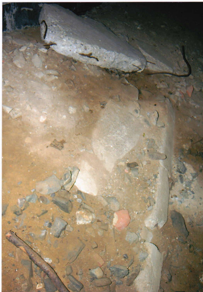
Obr.B45-887 Trosky betonových konstrukcí vysoko ve svahu před 5. podpěrou. Pohled zleva doprava, - svahy při opěrách nejsou zpevněny. Poklesly a před 5. podpěrou se objevily zabudované trosky železobetonu. Představují nebezpečí úrazu.
