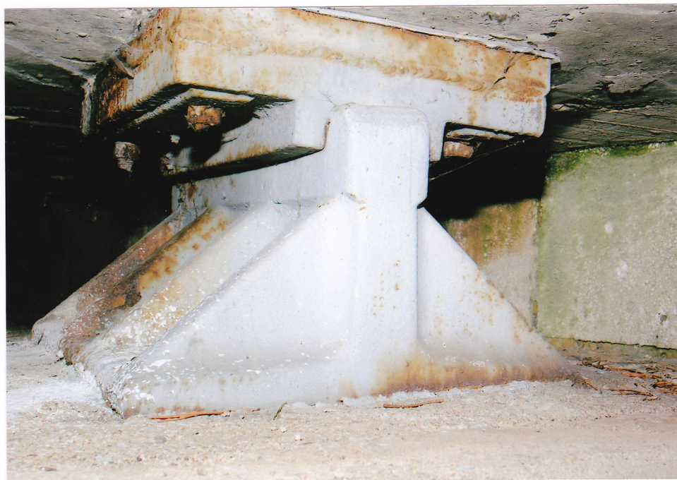
r.B45-883 Pevné ložisko pod 9. nosníkem, na pravém konci 5. podpěry. Pohled doleva a ke Sloupu, ložisko je konzervované šedým nátěrem a jen částečně korodované bez oslabení, podobně jako i další ložiska na této vyšší straně mostu, temeno UP je relativně čisté.
