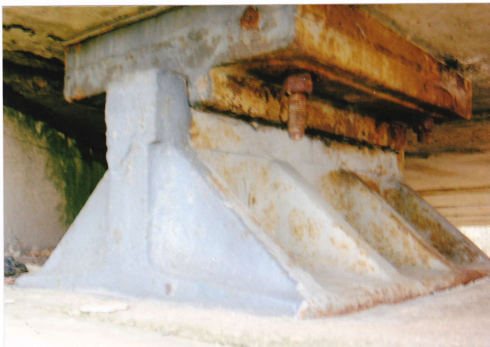
Obr.B45-828 Pevné ložisko pod 9. nosníkem, na pravém konci 1. podpěry. Pohled k Černé Hoře a doleva,
