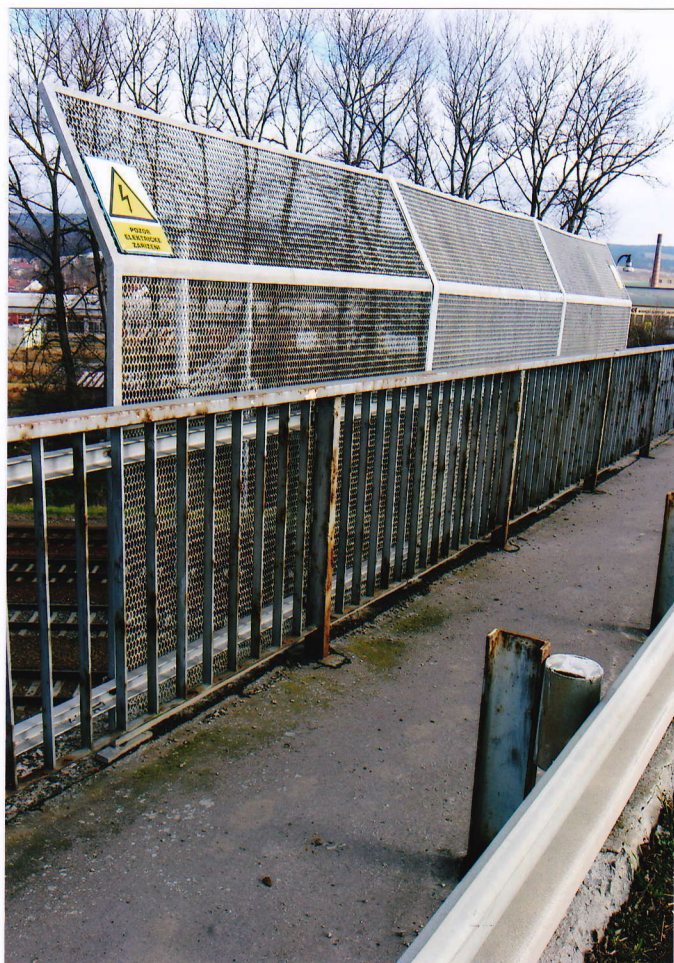
Obr.B45-123 Protidotyková zábrana za levostranným zábradlím nad 1. polem. Pohled doleva a ke Sloupu, - zábrana chrání před do- tykem vedení vysokého napětí procházejícího 1. mostním otvorem.
