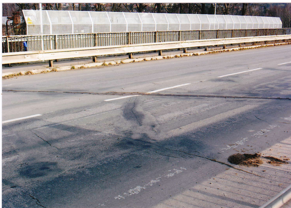
Obr.B45-124 Protidotyková zábrana za levostranným zábradlím nad 2. polem. Pohled doleva a ke Sloupu, - zábrana chrání před dotykem trolejí nad čtyřmi kolejemi trati Česká Třebová - Brno, - dole je patrný další příklad poškození vozovky trhlinami.
