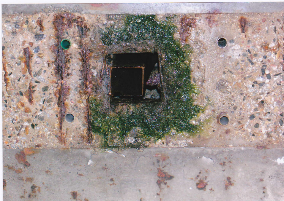
Obr.B45-139 Odpadní trouba prvního mostního ovodňovače (v 1. poli). Pohled přímo vzhůru, - odpadní trouba není litinová, koroduje, zatím bez rozpadu. Dolní spára mezi nosníky I-73 není v jeho okolí zabetonována.
