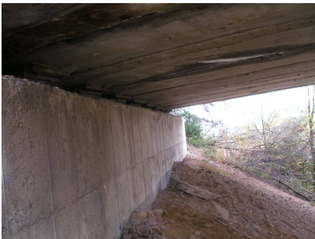
Obr.20, Zatékání v oblasti u opěry 1
