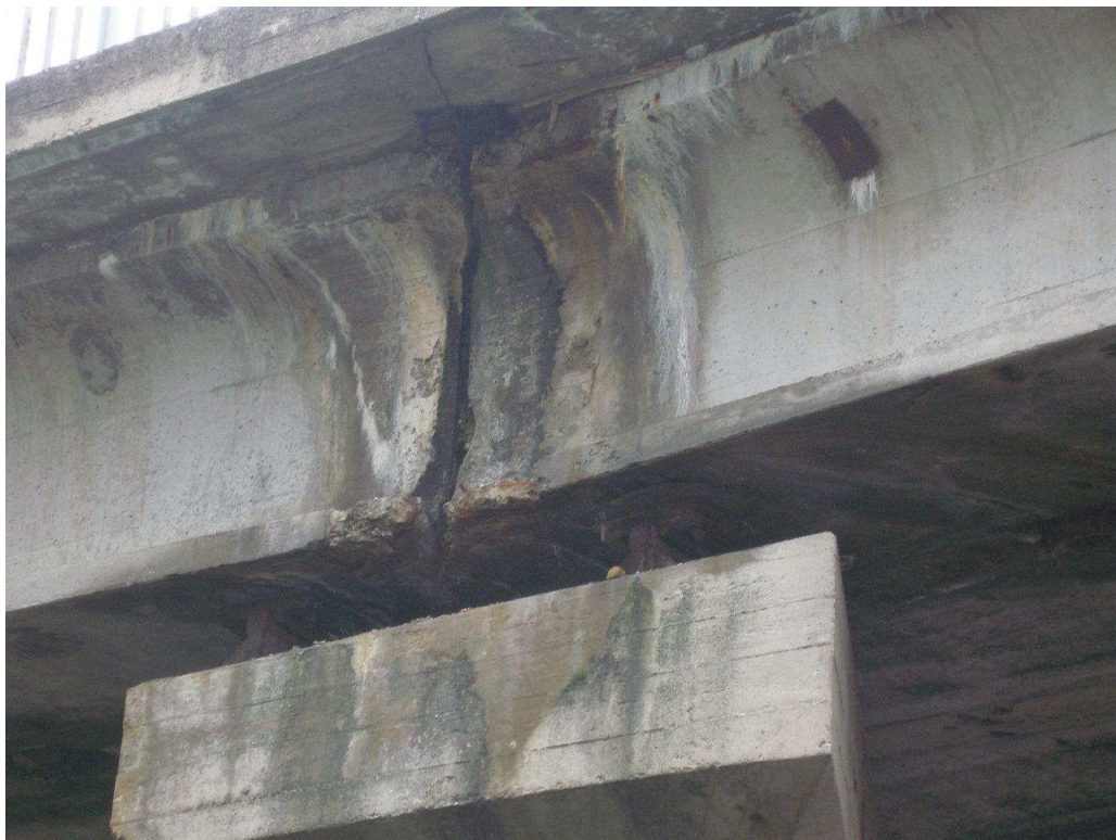
Obr.15, Zatékání skrz příčník nad opěrou 2 ze směru od Svitav
