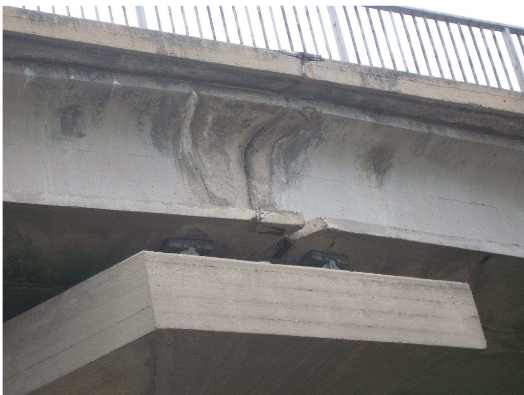
Obr. 10, Zatékání na úložný práh skrz příčník nad podpěrou 3 ze strany od Brna
