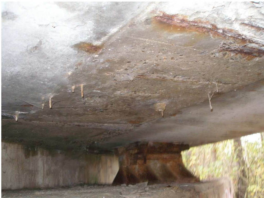
Obr.7, Krajní ložisko opěry 5 a pohled na podhled na zatékání na podhledu nosné konstrukce
