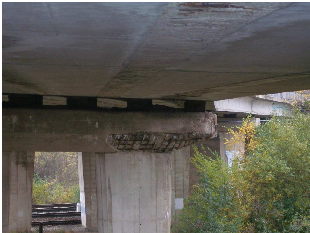
Obr.19, Degradace betonu úložného prahu podpěry 2
