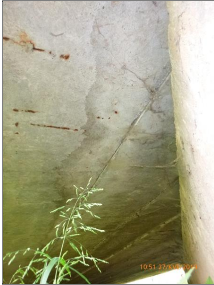
NK - zatékání do spár mezi prefabrikáty
