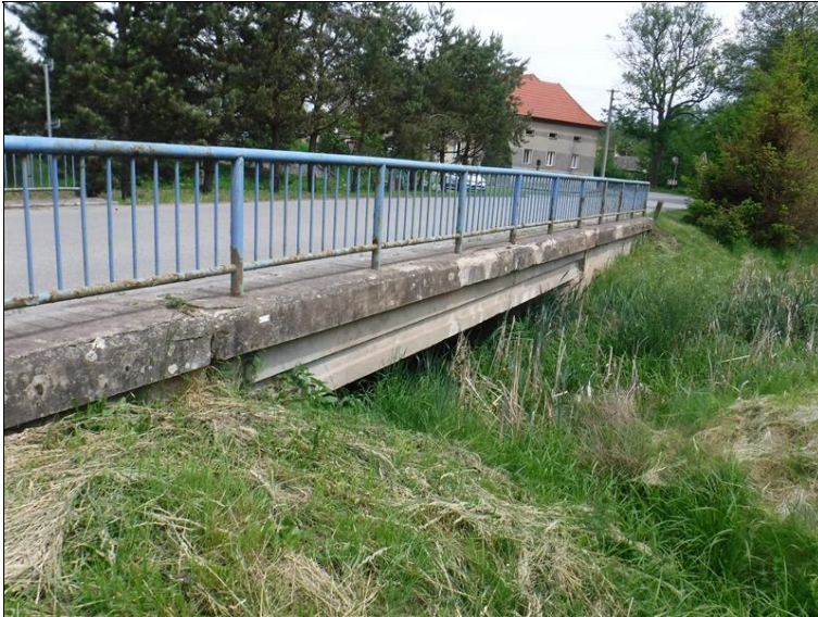
Pravá římsa (pohled z boku) - degradace betonu, koroze zábradlí
