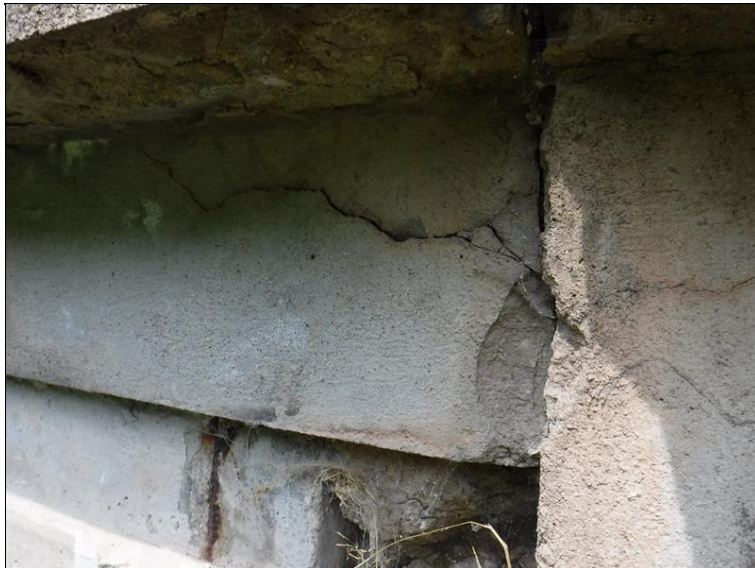
Porušení konce NK zatékáním
