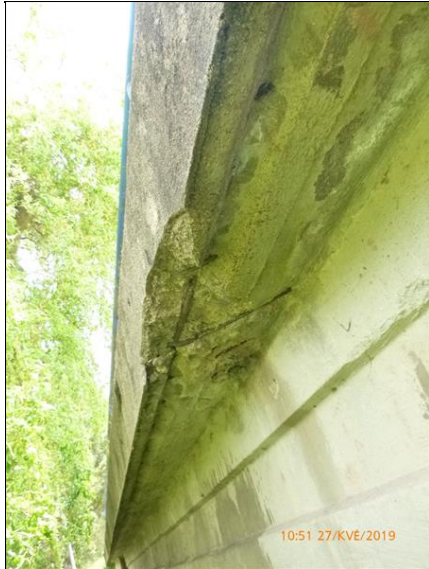
NK pod římsou - odhalená výztuž
