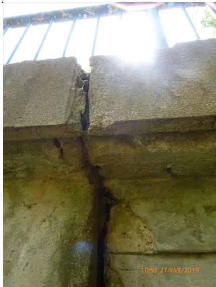
Dilatace římsy - typický detail - degradace betonu, zatékání
