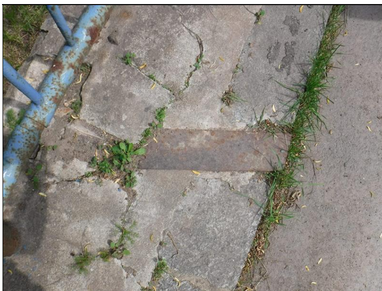
Závěr v římsě - typický detail - koroze, uchycena zelěň
