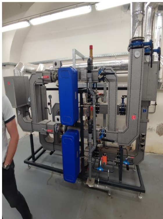
Technická místnost – horkovodní výměňková stanice
