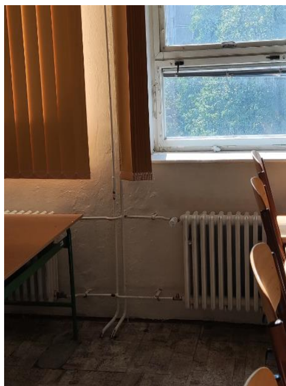
Rozvody a otopná tělesa v učebnách hlavní budovy
