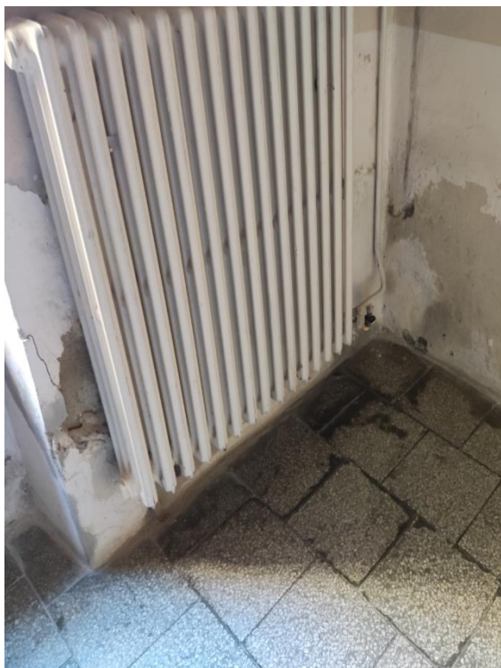
Otopné těleso v budově školy
