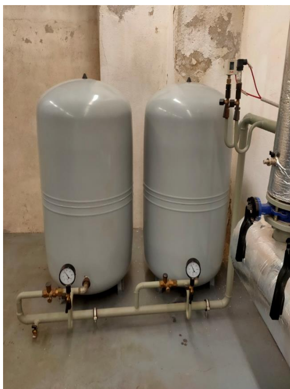
Technická místnost – tlakové nádoby
