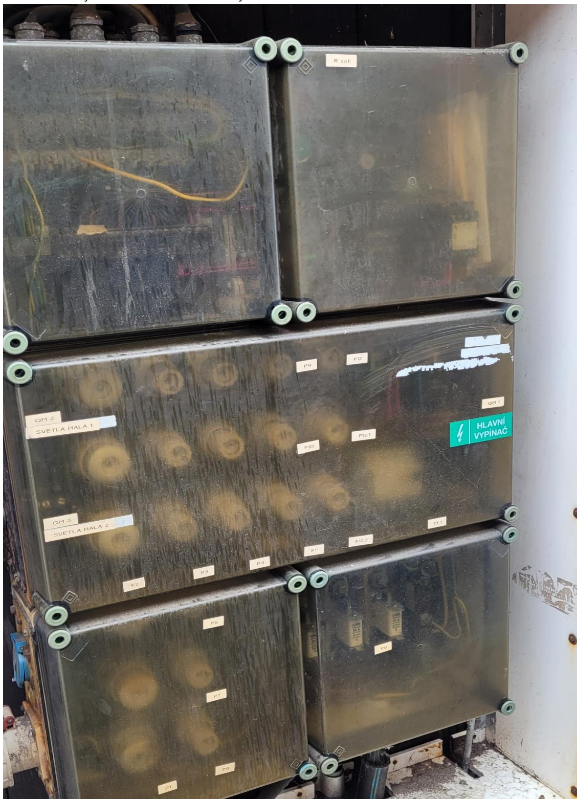
Obr. č. 4.2.5: Pojistková skříň na fasádě budovy č. 6
