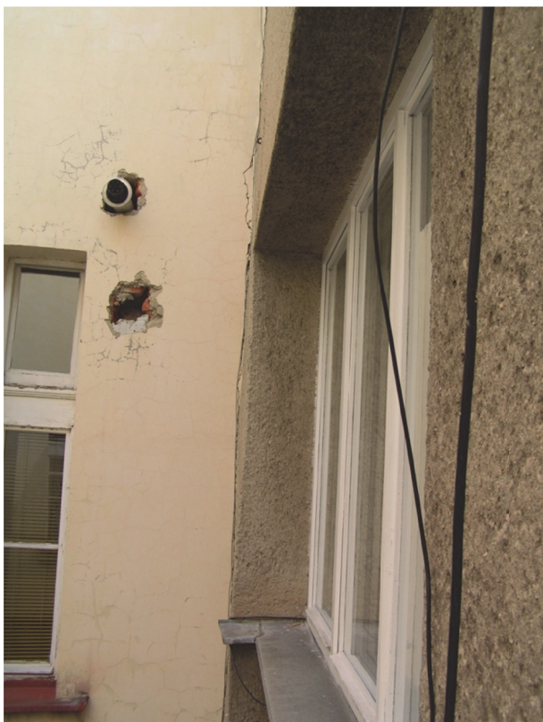
Foto 16: Trhlina v atriu na styku dvou sousedních domů (4.NP)
