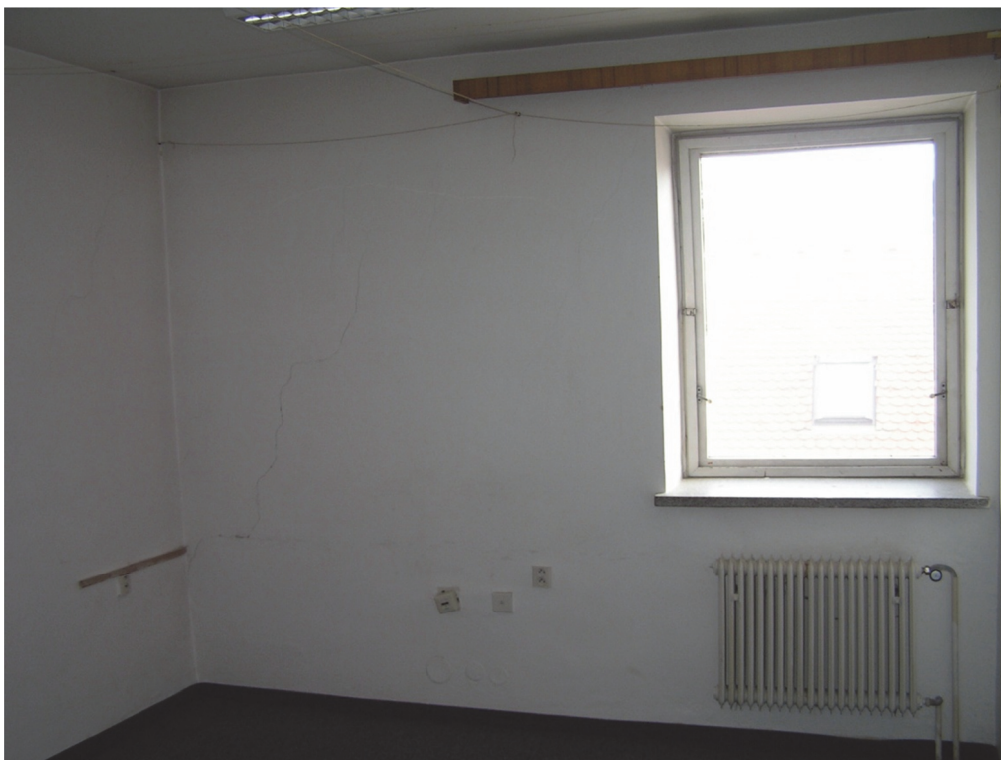
Foto 13: Trhlina v obvodové stěně 4.NP (místnost 402)
