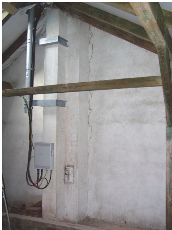
Foto 17: Trhlina na styku komínového tělesa a štítové stěny (5.NP)
