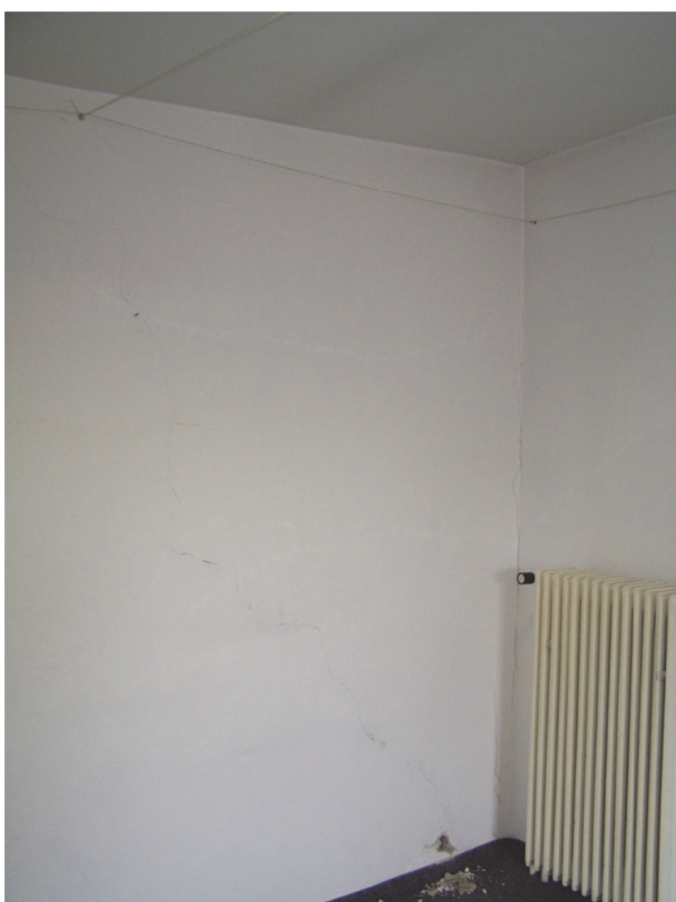
Foto 14: Trhlina ve vnitřní stěně 4.NP (místnost 402)
