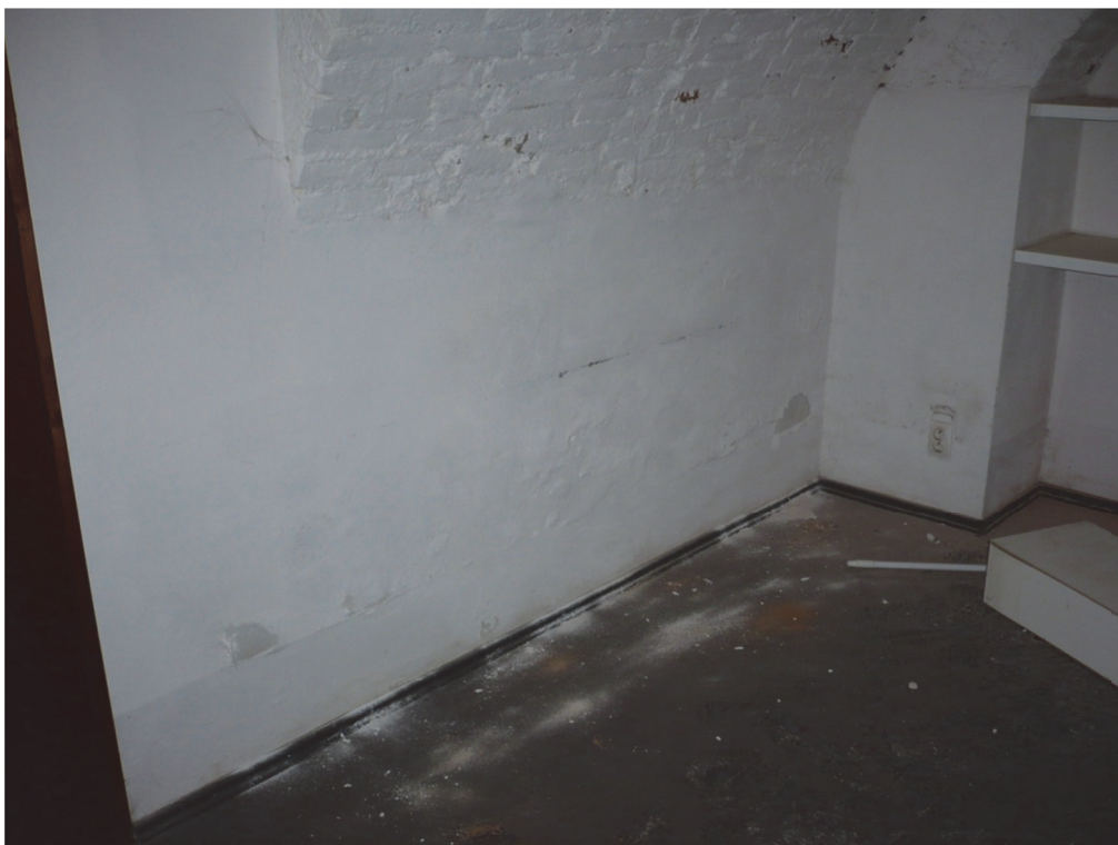
Foto 5: Sklepní prostory, na stěně je viditelná linka, způsobená při posledním zatopení sklepa vodou (zhruba do poloviny zásuvky)
