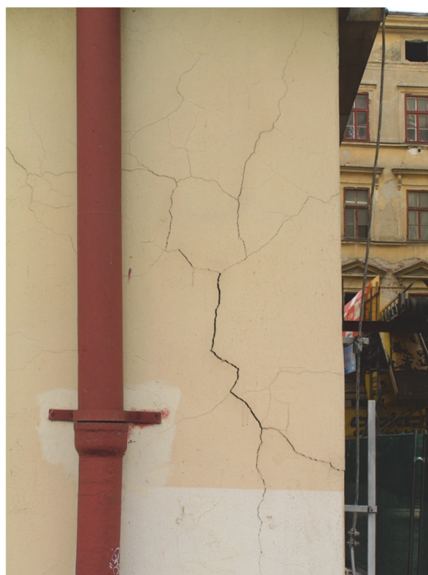
Foto 8: Trhlina na vnějším rohu fasády - roh ulic Skrytá a Veselá
