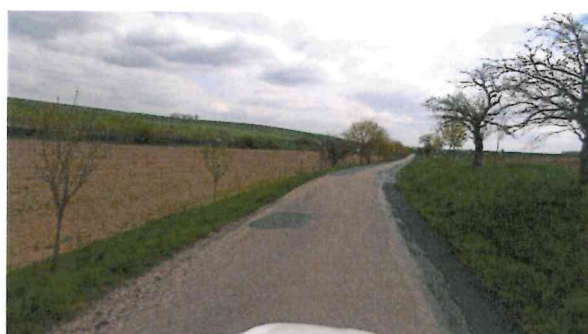
Síťové trhliny, vysprávky, olamování okraje vozovky
