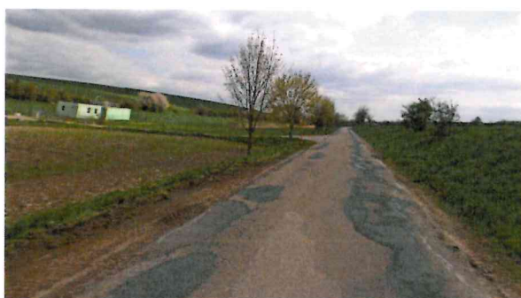
Mozaikové trhliny, vysprávky
