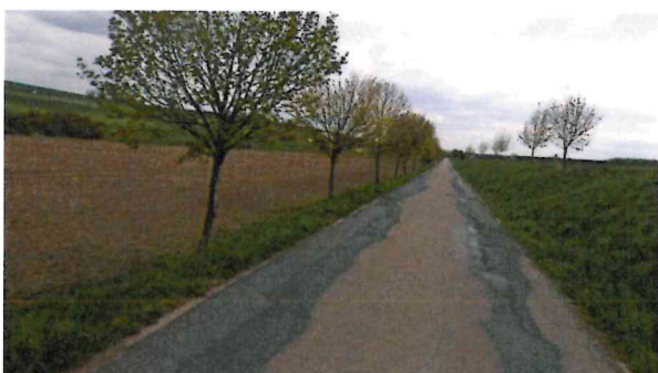
Vysprávky, podélné trhliny, ztráta asf. tmelu
