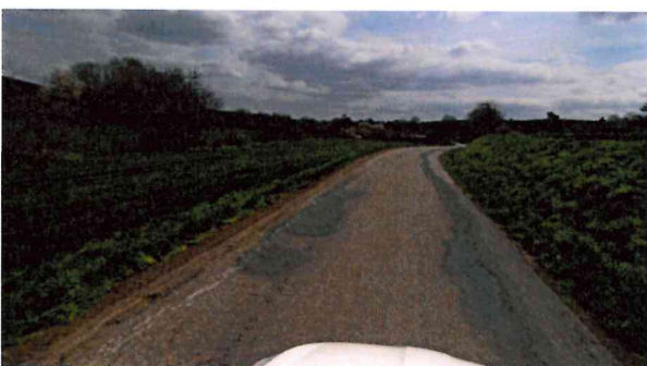
Síťové trhliny, vysprávky
