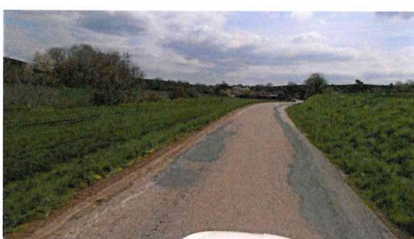
Mozaikové trhliny, olam. okrajů vozovky, vysprávky
