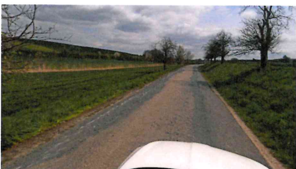
Ztráta asfaltového tmelu, vysprávky
