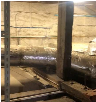
Stávající potrubní rozvody
