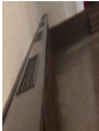
Přívodní výústky v obkladu stěn
