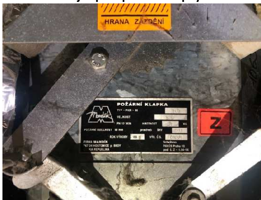
Stávající protipožární klapky
