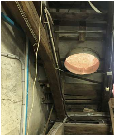
Stávající přípojně místo pro sání čerstvého vzduchu
