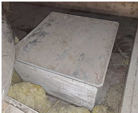
Demontované rekuperační výměníky
