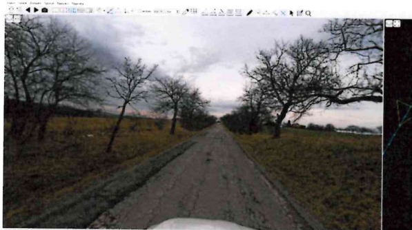
Síťové trhliny, výtluky, vysprávký
