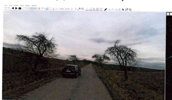
Síťové trhliny, podélné trhliny, vysprávký
