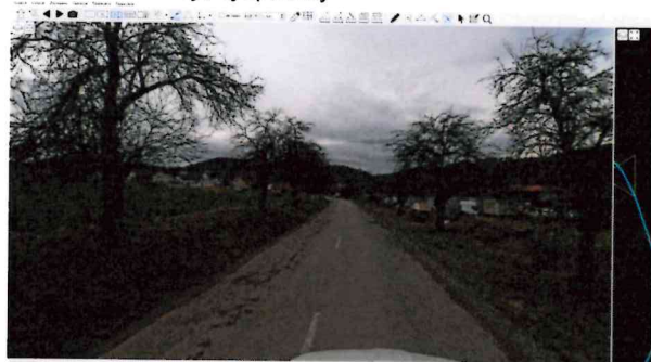
Výtluky, mozaikové trhliny, vysprávký
