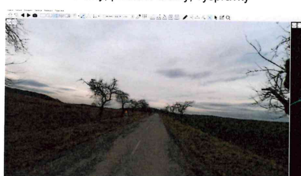
Mozaikové trhliny, vysprávký
