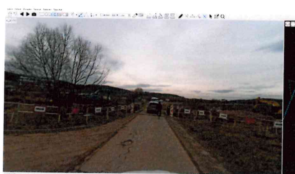
Mozaikové trhliny, výtluk
