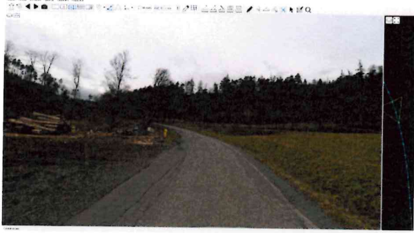
Sítivé trhliny, mozaikové trhliny, vysprávky
