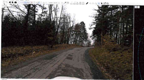
Síťové trhliny, výtluky, vysprávký
