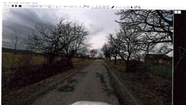
Síťové trhliny, vysprávký
