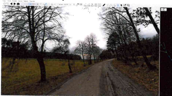
Sítivé trhliny, výtlučky, mozaikové trhliny
