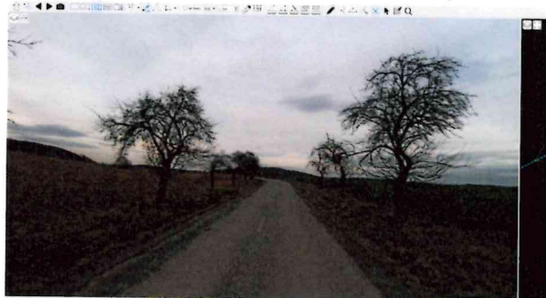
Síťové trhliny, podélné trhliny, vysprávký
