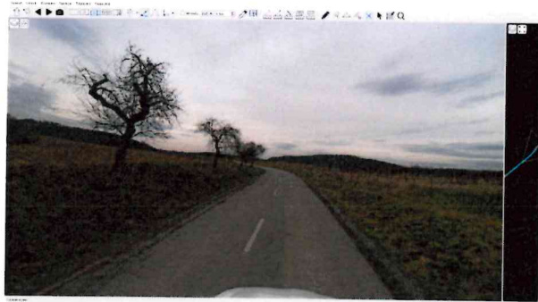
Mozaikové trhliny, pod. a příč. trhliny, vysprávký
