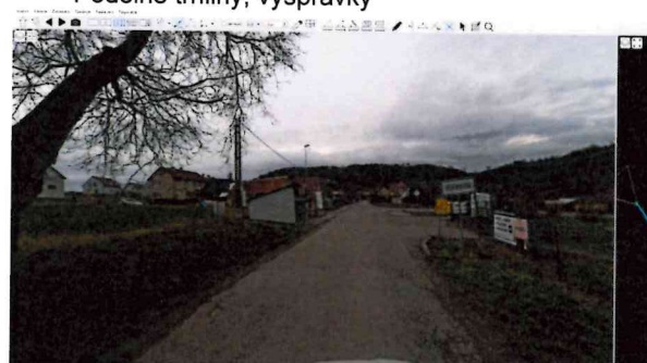
Síťové trhliny, vysprávký
