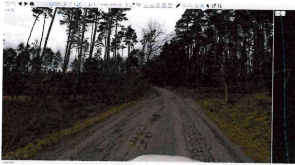
Síťové trhliny, výtluky
