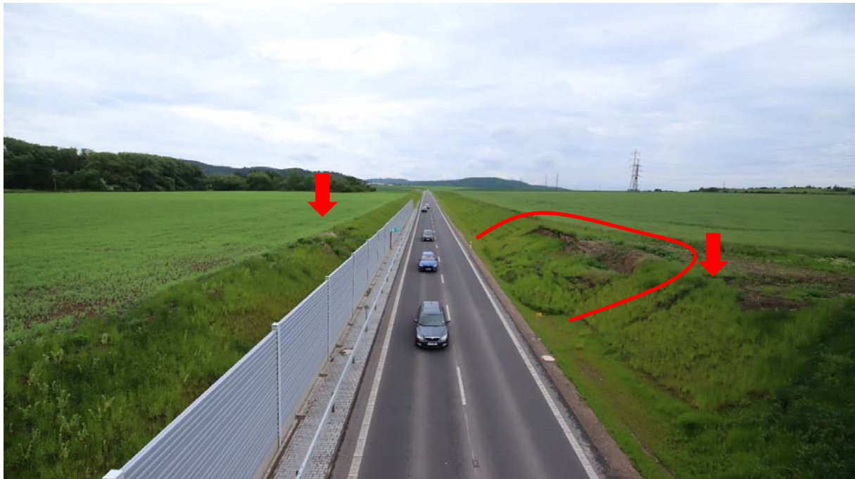
Obrázek 6: celkový pohled ze silničního nadjezdu na svahovou poruchu 1, pohled směr Kuřim, Brno, vpravo je hlavní porucha s vyznačeným rozsahem a erozní rýhou ve svahu, vlevo za PHS je aktivovaná podružná porucha
