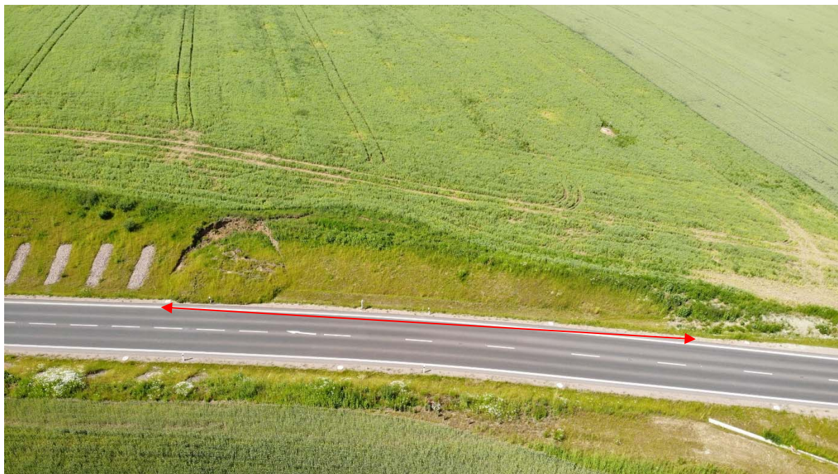
Obrázek 20: vymezení celkového rozsahu svahové poruchy 2 v pravostranném svahu zářezu
