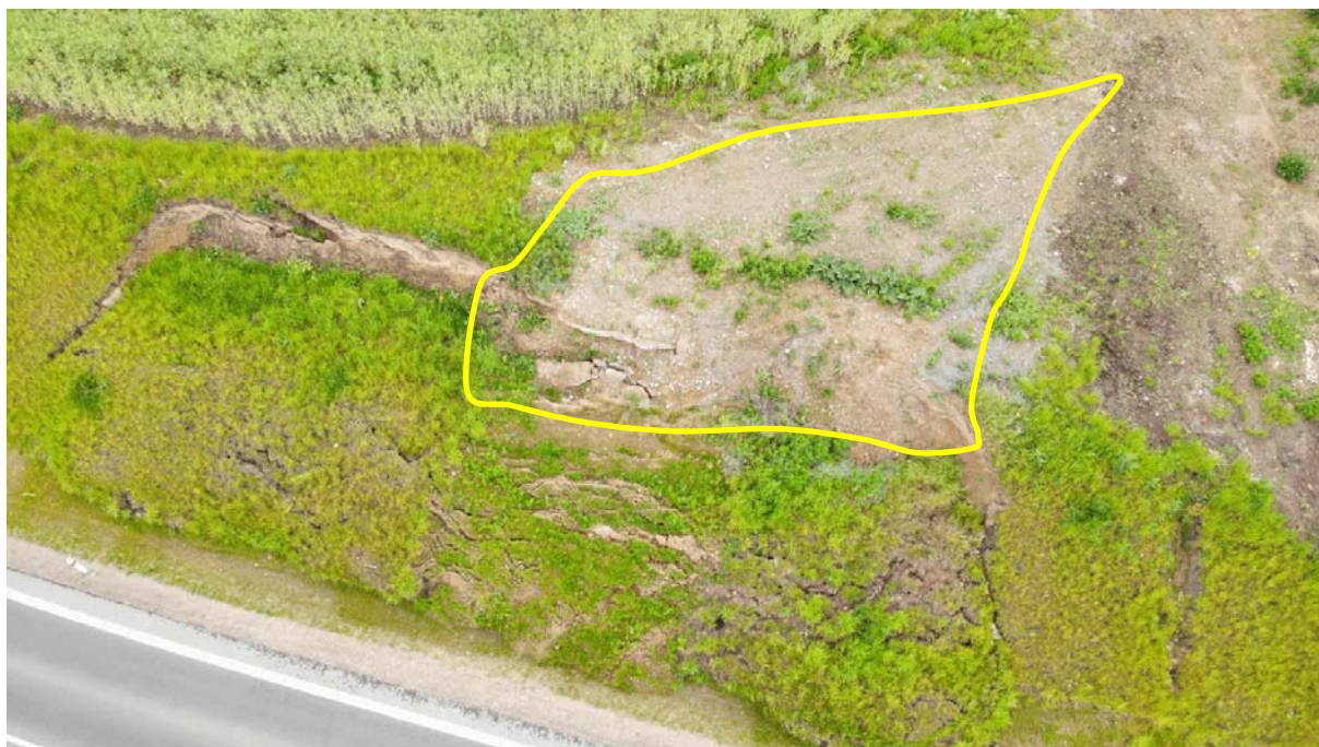
Obrázek 10: pohled na poruchu 1 s vyznačenou oblastí předchozí stavební výstavby a činnosti nadjezdu, místo hlavních poruch struktury svahu a podloží, díky kterým došlo s infiltraci vody do tělesa zářezu
