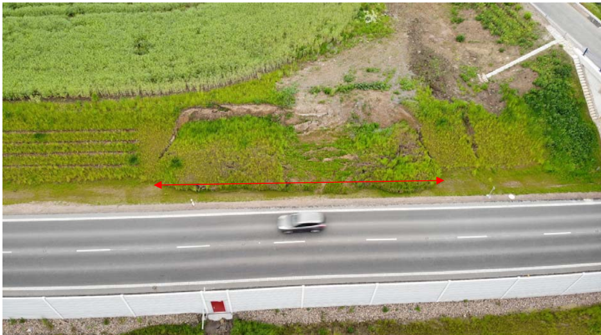
Obrázek 7: čelní pohled na svahovou poruchu 1, místo mimo svahové vegetační úpravy, místo svedení vod z účelové komunikace a mostu, svedení vod z přístupové cesty a polí, erozní narušení a relikty stavební činnosti v horní hraně zářezu svahu, svahová porucha je vymezena do nebezpečné krajnice komunikace, vyznačená délka 23 m
