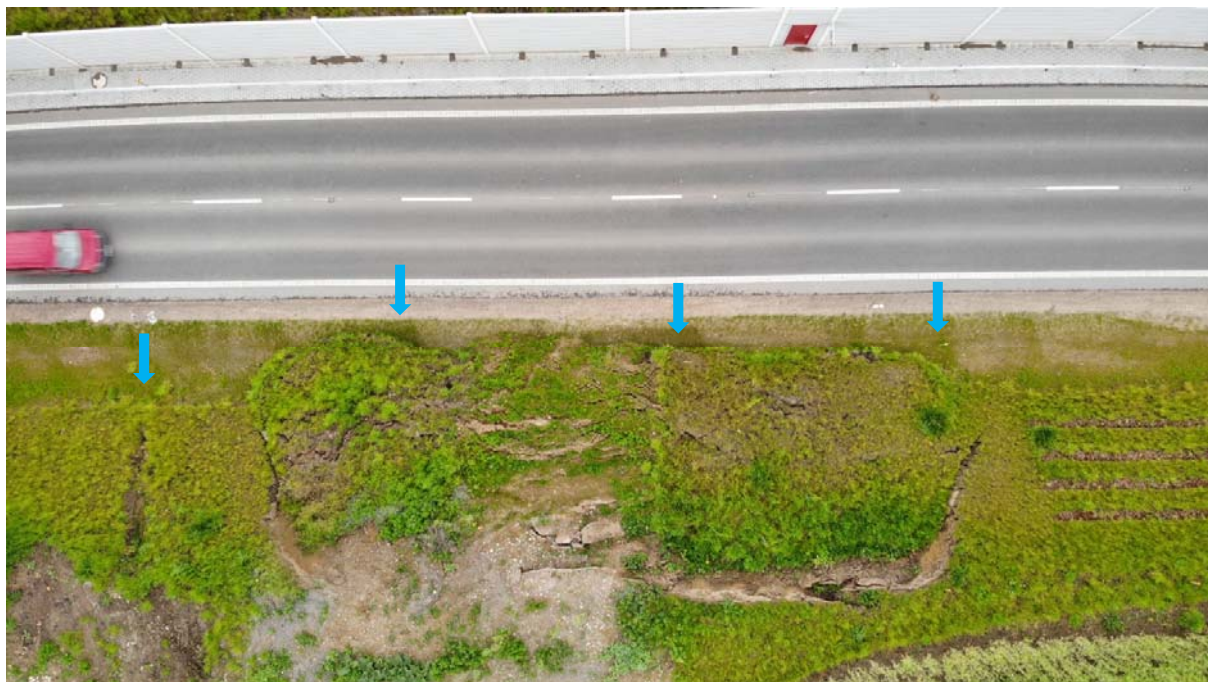
Obrázek 8: horní pohled na svahovou poruchu 1 vpravo, včetně okolních vazeb, vyznačena místa eroziho narušení svahu a vyšší saturace zemin v patě svahu,
