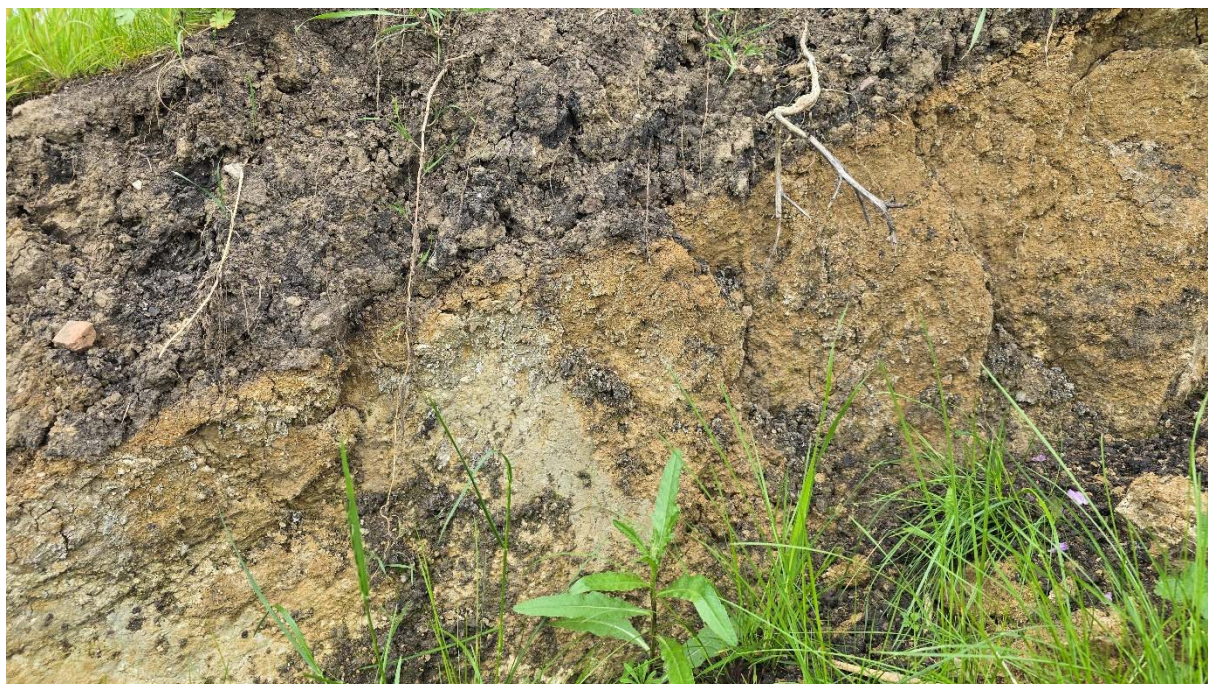
Obrázek 27: detail krajní partie sesuvu s výchozem původních sprašových hlín, které jsou kryty vegetační úpravou svahu v rámci stavby v mocnosti 0,15- 0,2 m
