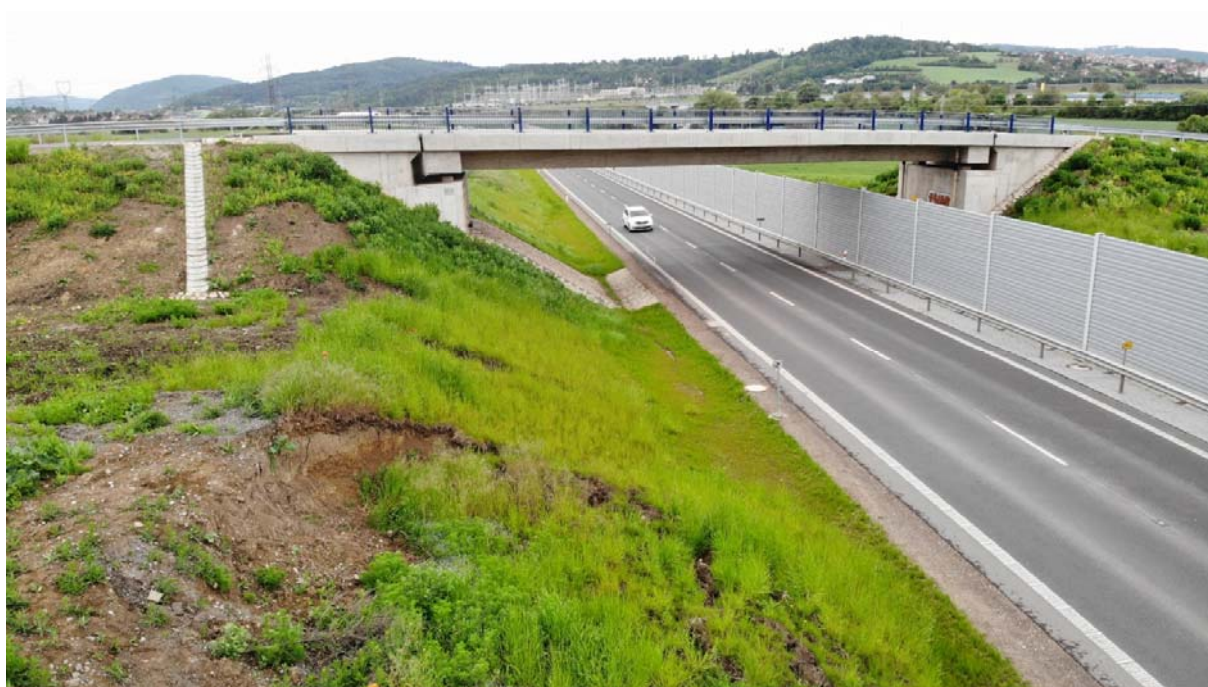
Obrázek 12: uspořádání okolních vazeb na svahovou deformaci 1, nový silniční nadjezd s odvodněním ro prostoru zářezu, bez svedení vod řízeně, erozní narušení svahu a krajní partie sesuvu svahu
