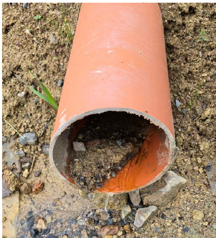
Obrázek 33: detail vyústění drenáže zářezu, vyústění není vhodné pro dlouhodobou údržbu a trubka je až do hloubky 0,6 m zanesena
