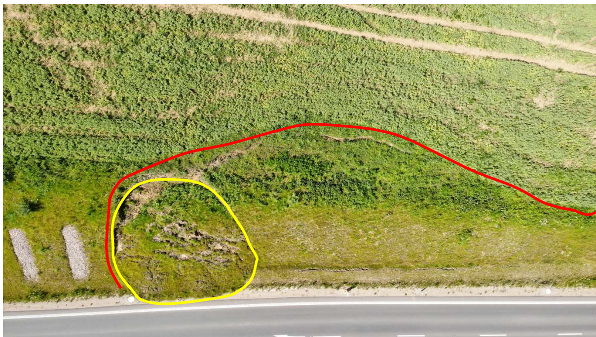
Obrázek 19: horní pohled na vymezení hlavní poruchy a druhotně aktivované, druhotná porucha zasáhla do blízkosti krajnice komunikac
