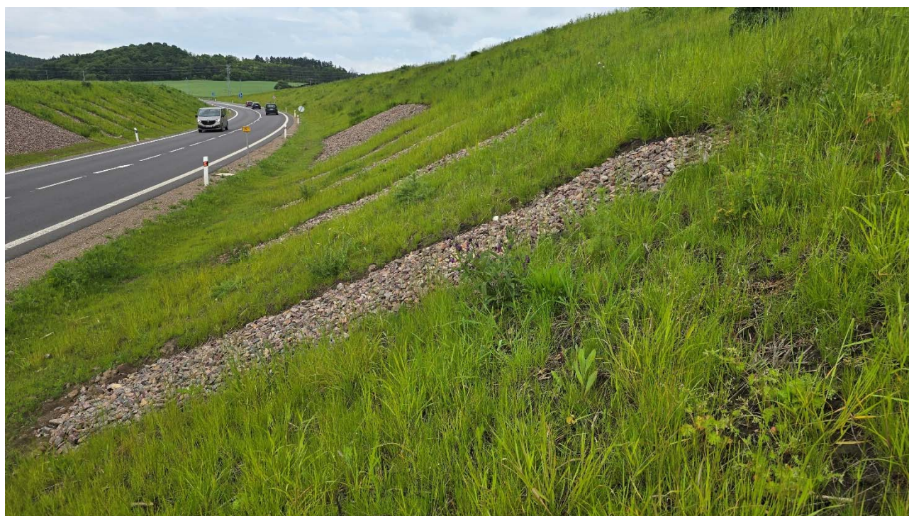
Obrázek 29: přímo navazující partie zářezu, které byly dle PD stabilizovány štěrkovými žebry a plombami, vyjma oblast, která je postižena sesuvem
