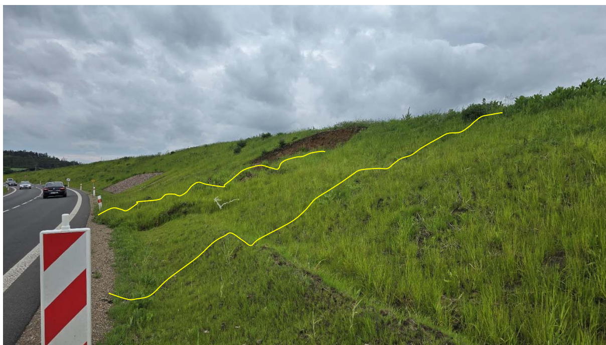
Obrázek 21: pohled na charakter poruchy v nejvyšších místech svahu s vyznačenou linií svahu po ukončení svahových pohybů hlavní poruchy a v pozadí druhotné poruchy
