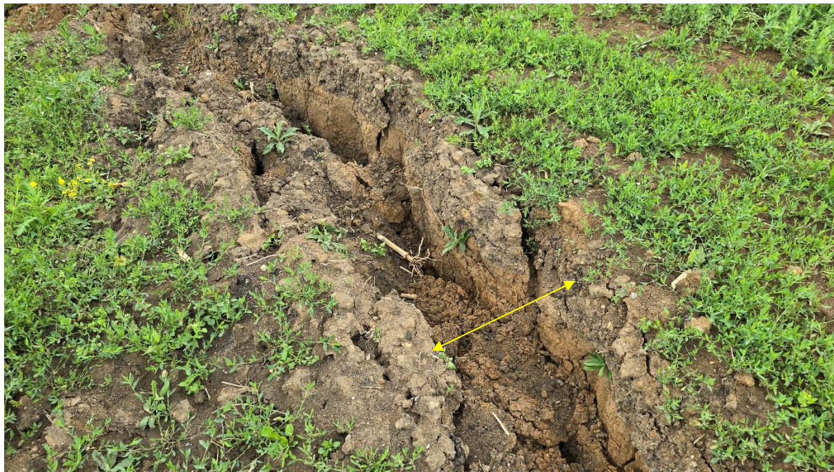
Obrázek 26: detail místa nejširší trhlinou ve vyznačeném místě 0,30 m
