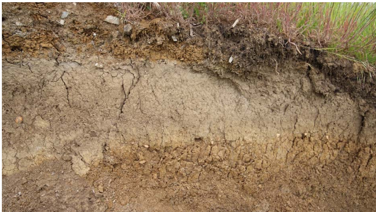
Obrázek 14: zeminy tvořící horní partii zářezu a pohled na horní odtrhovou hranu sesuvu, jílovité zeminy v pevné až tvrdé konzistenci, svrchní kryt humózní hlíny a navážky
