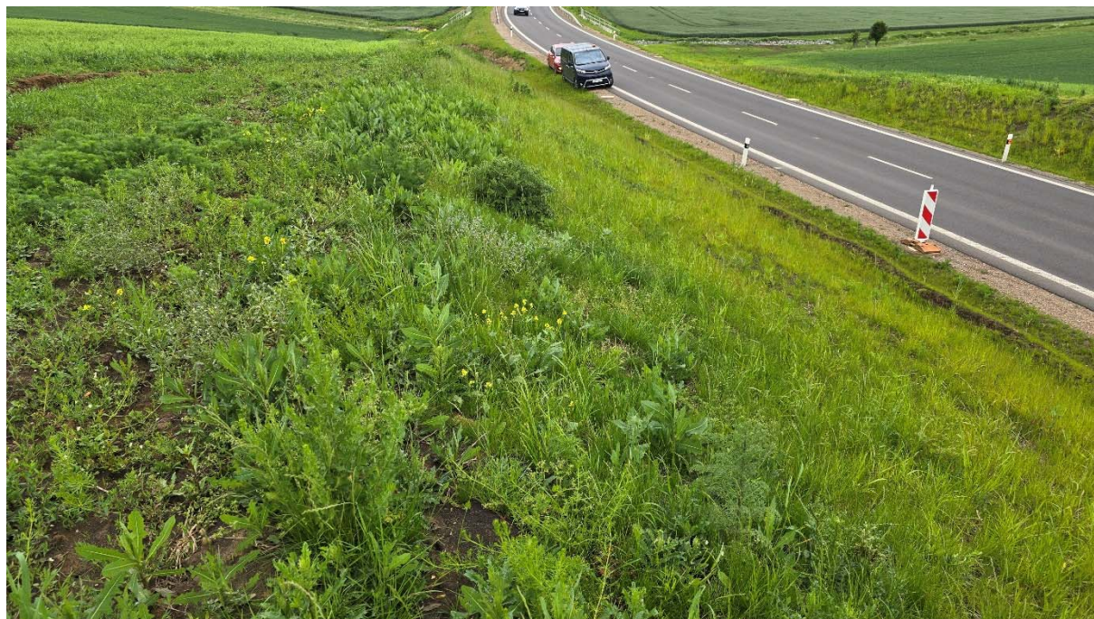
Obrázek 25: pohled na svahovou poruchu se snižující se výškou svahu zářezu, v patě je zřejmá linie nasunutí a deformace paty vlivem sesuvu
