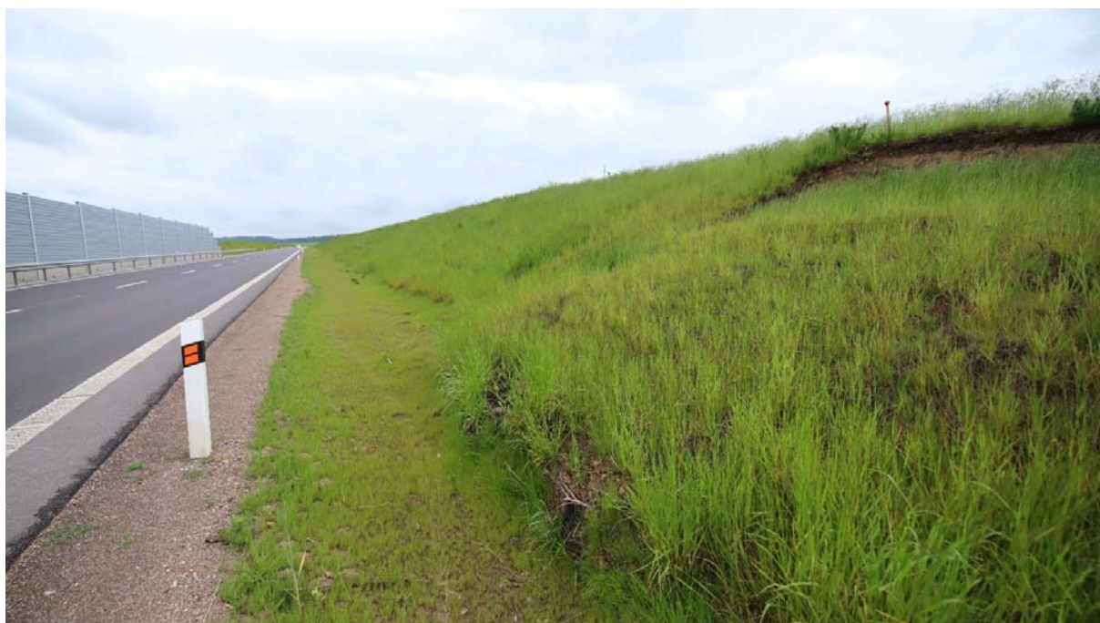
Obrázek 13: pata svahové poruchy 1 s akumulací do blízkosti nezpevněné krajnice silnice II/385
