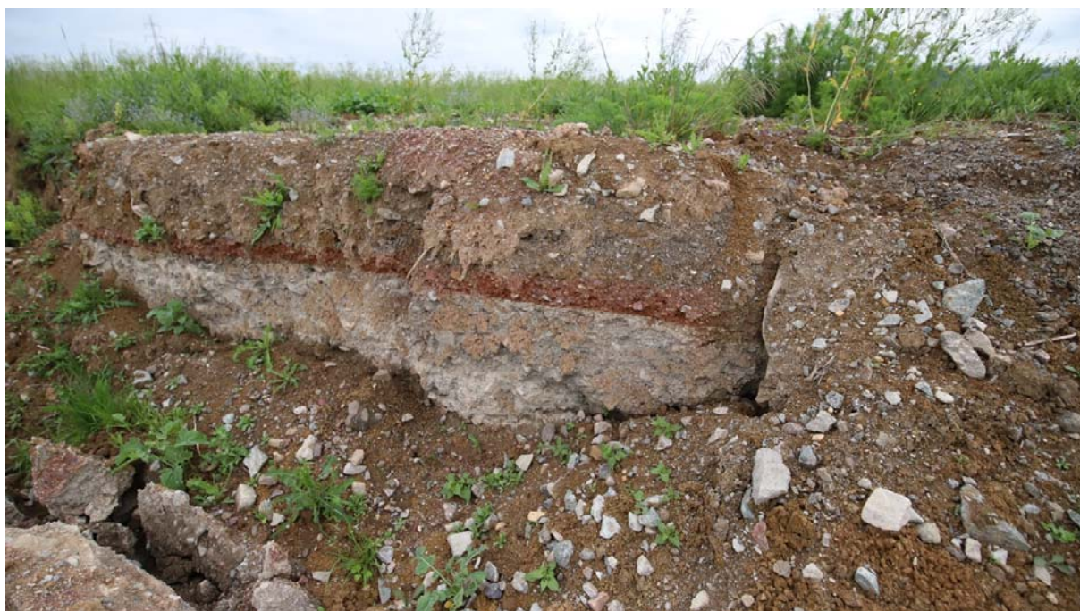
Obrázek 15: detail narušeného betonového fundamentu s navážkami ve střední části sesuvu poruchy 1
