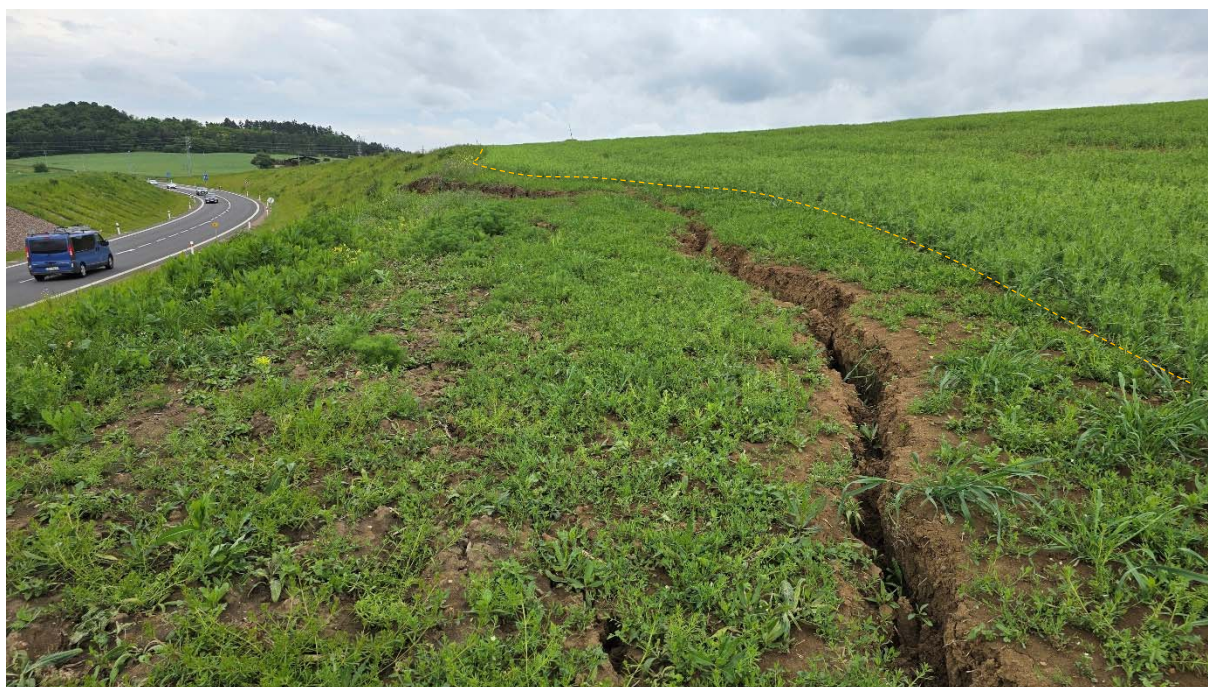
Obrázek 22: detail horní narušené části svahu s výrazně rozevřenými trhlinami, známka že k aktivaci svahové poruchy docházelo postupně je i stav provedení jarního osetí již za linií aktivované poruchy svahu,
