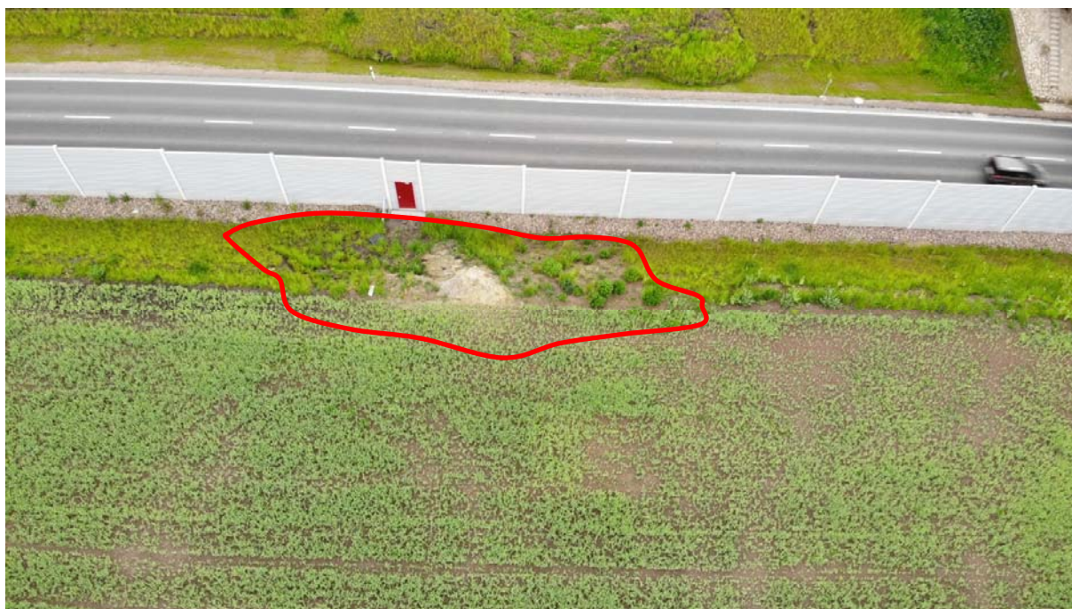
Obrázek 9: pohled na podružnou svahovou poruchu 1 vlevo za PHS s její lokalizací a rozsahem, v pozadí hlavní porucha vpravo silnice II/385
