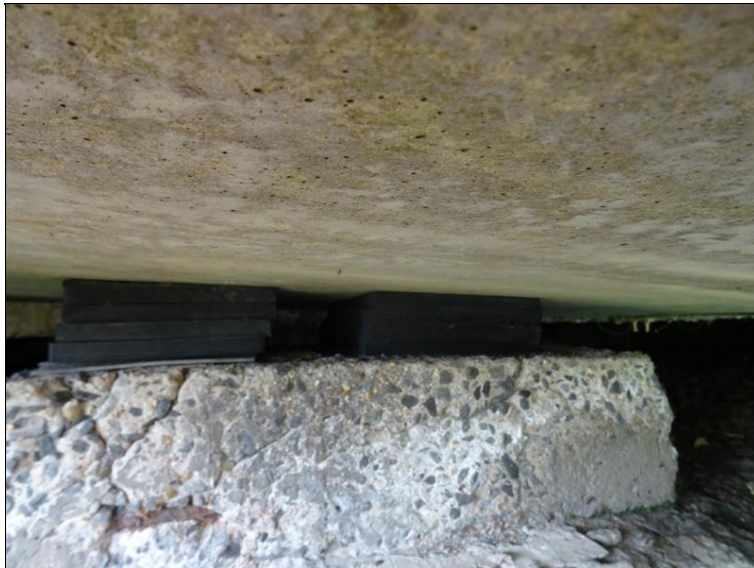
62.JPG Čelní pohled na podložiskový blok se zdvojenou rovinou 2x4 ložisek pod pravým hl. nosníkem. Trhliny pod pravou rovinou ložisek, celková degradace betonu s lokál. obnaženou výztuží.
