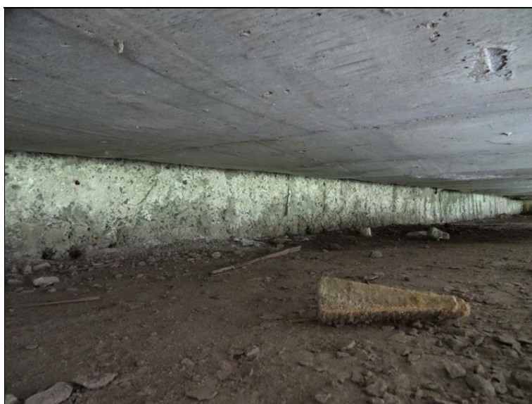
48.JPG Úložný práh Op1 v pohledu od 2. podložiskového bločku směrem k levému Hl. nosníku. Úl. práh je zanesený, se stopami zatékání přes MZ.
