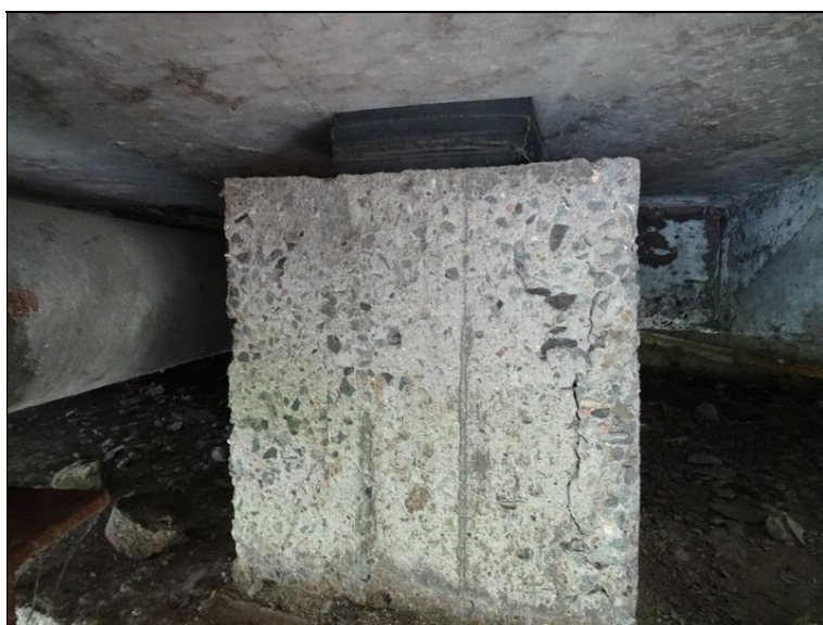
54.JPG Čelní pohled na 4. (mostovkový) podložiskový blok s rovnaninou 4 ložisek. Povrchová degradace bločku se svislou trhlinou v souběhu s jeho levou čelní hranou.
