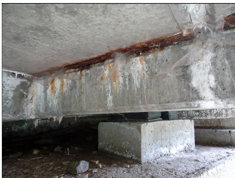
39.JPG Vnitřní strana levého hl. nosníku v místě před koncovým příčnickem nad OP1. Zátoky přes ložnou spáru mostovkového prefabrikátu osazeného na přírubě hl. nosníku.
