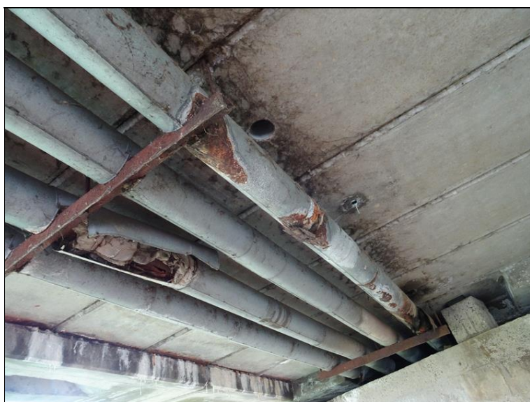
66.JPG Podhled NK v místě zavěšeného potrubí na pravé straně mostu ve směru k Op1. Inkrustace průsaků na vnitřní přírubě hl. nosníku. Lokální koroze a odpad opláštění potrubí. Odkrytá místa s poruchou nebo ztrátou tepelné izolace. 2. trubní vedení zprava, v místě poruchy opláštění, s korozní perforací.
