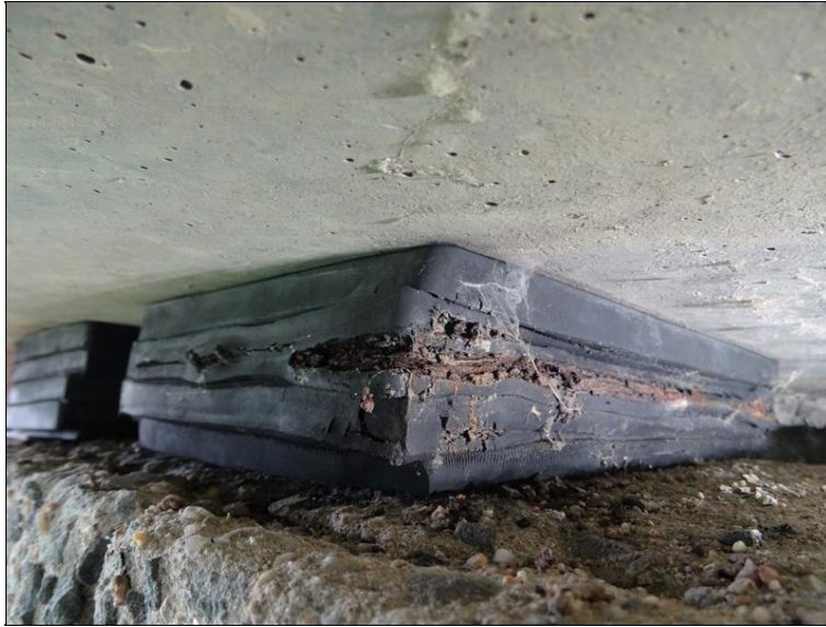
61.JPG Vyhřezlá silně zkorodovaná ocel. vložka elastomerového ložiska v 1. rovině (zleva) z 4 ložisek pod pravým hl. nosníkem.
