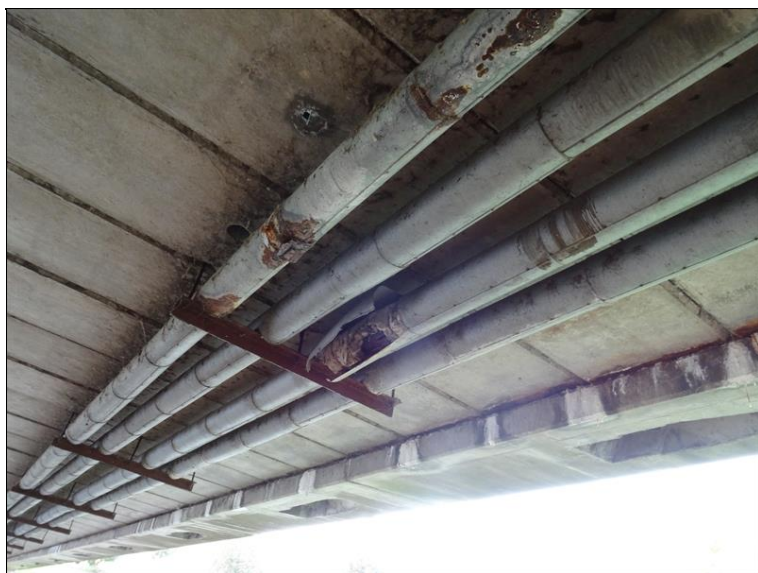
67.JPG Podhled NK v místě zavěšeného potrubí na pravé straně mostu ve směru k Op2. Inkrustace prúsaků na vnitřní stěně spodní příruby hl. nosníku. Lokální koroze a odpad opláštění potrubí. Odkrytá místa s poruchou nebo ztrátou tepelné izolace.
