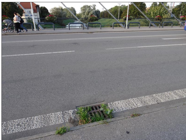
71.JPG Vtok odvodňovače vozovky na levé straně mostu uprostřed. Uchycená vegetace.
