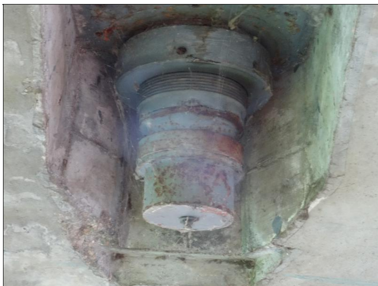
38.JPG Kotva 8. závěsu na podhledu pravého hl. nosníku. Drobné poruchy PKO kotvy.
