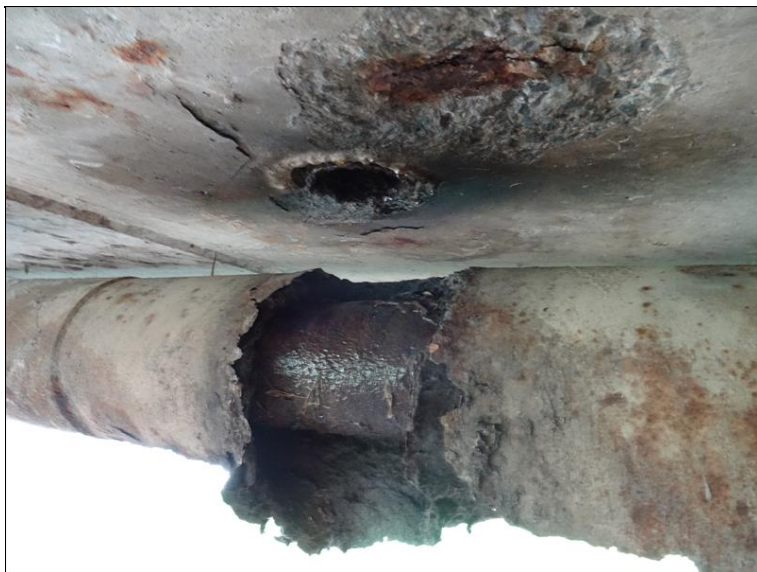
58.JPG Vyústění odvodňovače nad zavěšeným potrubím. Porušené opláštění a izolace potrubí v detail. pohledu.
