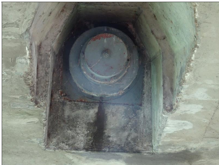
37.JPG Kotevní kapsa 1. závěsu na podhledu levého hl. nosníku. Průsak vody
