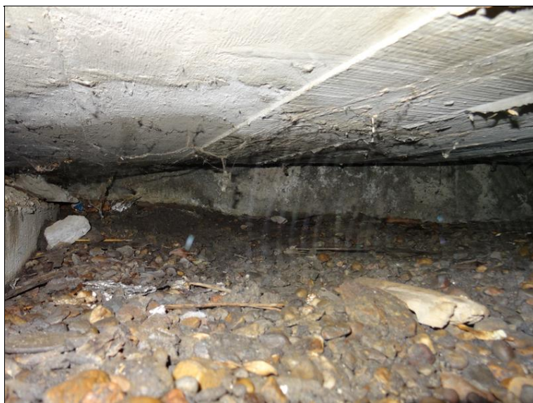
65.JPG Prostor úlož. prahu na pravém konci Op1. Prostor je zanesený, vlivem zatékání shora trvale vlhký.
