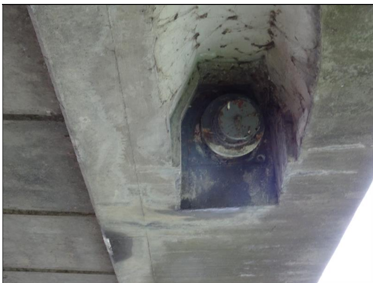
36.JPG Kotevní kapsa 2. závěsu na pravém hl. nosníku. Povrchová koroze kotvy, průsak vody.
