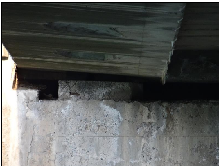
63.JPG Uložení pravého hl. nosníku na Op1. Stoční hl. nosníku, stopy silného zatékání.
