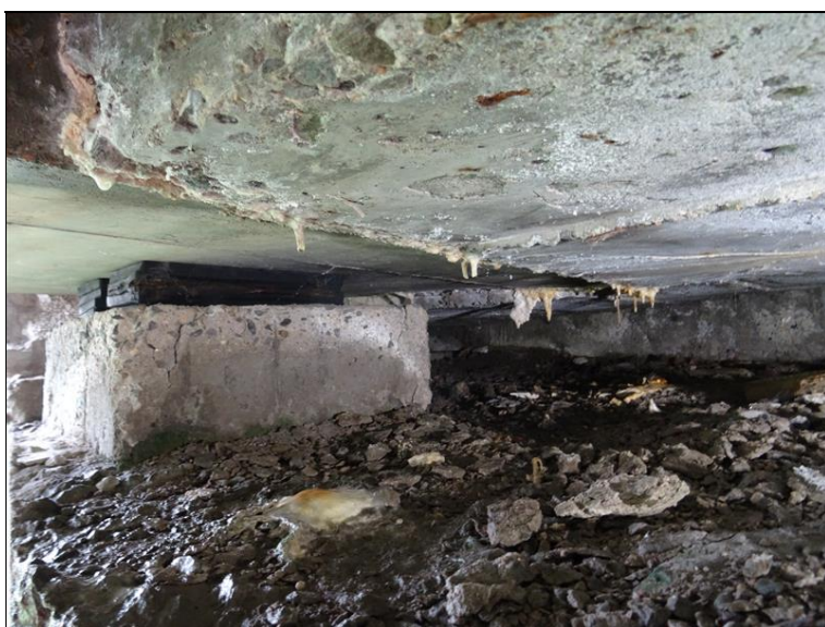
60.JPG Stav v oblasti uložení pravého hl. nosníku na Op1. Průsaky v místě zmonolitnění hl. nosníku s příčnickem, celá oblast mokrá, podložkový blok s degradovaným betonem a trhlinami.
