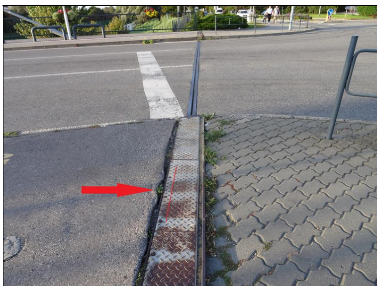
69.jpg MZ v levém chodníku. Na obr. zvýrazněná oblast je otevřená - zřejmě hl. příčina zátoků do Op1 v tomto místě.
