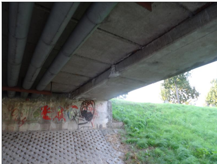
13.JPG Pravý hl. nosník před Op2. Spodní příruba hl. nosníku s inkrustrací výluh pod spárami mezi mostovkovými prefabrikáty.
