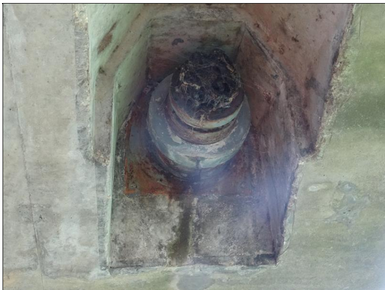
35.JPG Chybějící kryt konců předpínacích lan na kotvě 1. závěsu pravého hl. nosníku. Lokální koroze kotva. Průsak vody.
