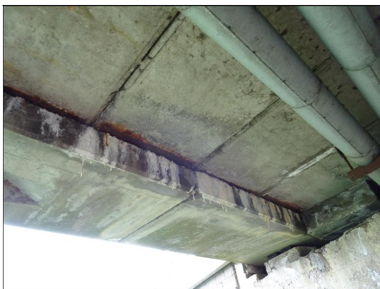
12.JPG Pravý hl. nosník před Op1. Masivní zatékání přes spáru s mostovkovými prefabrikáty, lokálně i mezi prefabrikáty samotnými.
