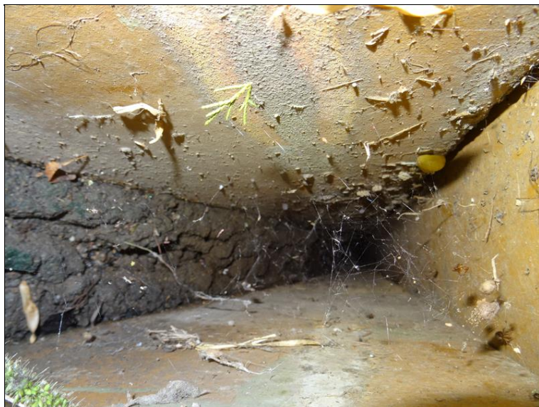
70.JPG Pohled do kryté části MZ v místě pravého chodníku. Těsnící profil je zanesený. Správná orientace snímku - 90° vlevo.
