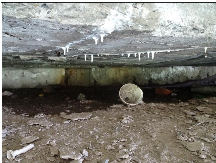
41.JPG Podhled koncov. příčniku nad Op1 před vetknutím do levého hl. nosníku. Průsaky vlhkosti trhlinami s tvorbou inkrustací. Úlož. práh Op1 vlhky, stopy zátoků přes oblast MZ v levém chodníku.
