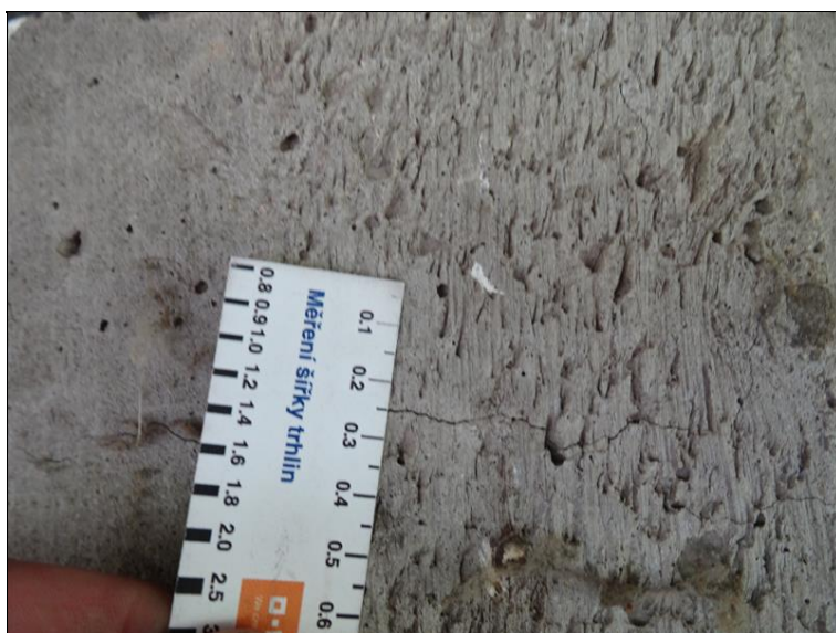
44.JPG Lokální trhlinka vodorovného směru v čele 1.podložiskové bločku mostovky.
