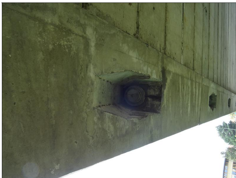
11.JPG Podhled levého hl. nosníku. Průnik vody průchodem 1. závěsu nosníkem.
