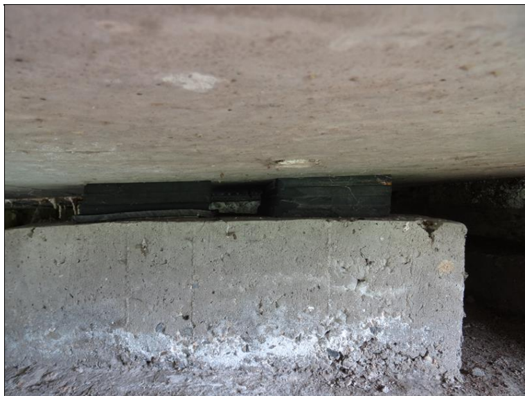
40.JPG Čelní pohled na podložiskový blok se zdvojenou rovinaninou 2x4 ložisek na Op1 pod levým hl. nosníkem. Spodní část bloku se špatně zpracovaným betonem.
