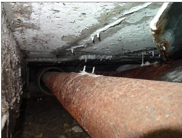
59.JPG Podhled mostovky nad Op1 v místě před průchodem pravého krajního potrubí (vedle pravého hl. nosníku) závěr. zídka. Na podhledu zvodněná trhlina s inkrustací, potrubí bez opláštění s korozi.
