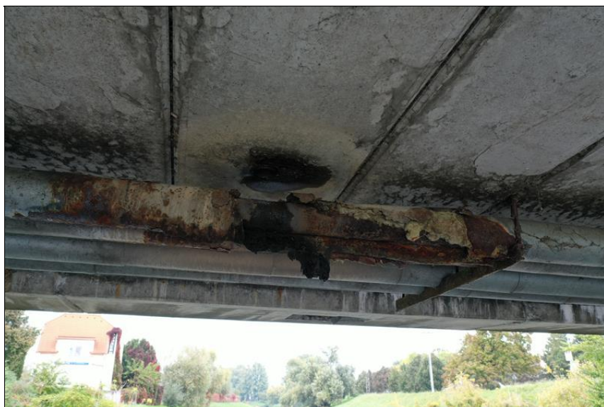
68.JPG Porucha opláštění potrubí pod středovým odvodňovačem na pravé straně mostu.
