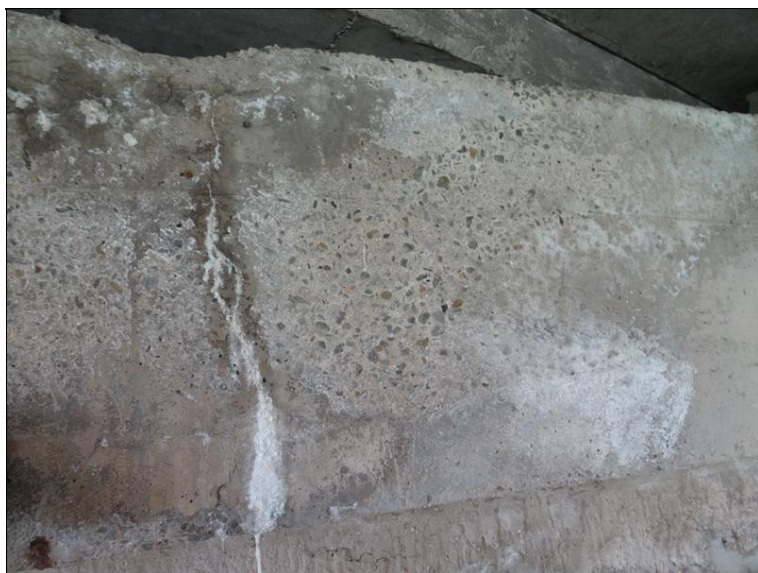
53.JPG Detail čelní plochy ú. prahu Op1 v místě před 4. podložiskovým blokem zleva. Degradace betonu v horní hraně ú. prahu, pod ní svislá zvodnělá trhlina.
