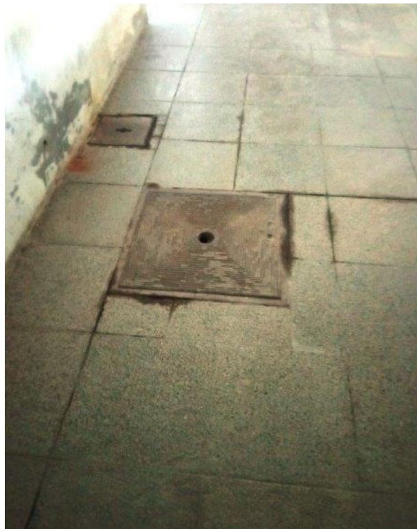
Foto 42: Kanalizační šachta v 1.PP, viditelně zavlhlé spáry dlažby a intenzivní negativní vlhkostní projevy na přilehlé zdi. Pravděpodobná značná netěsnost ležaté kanalizace
