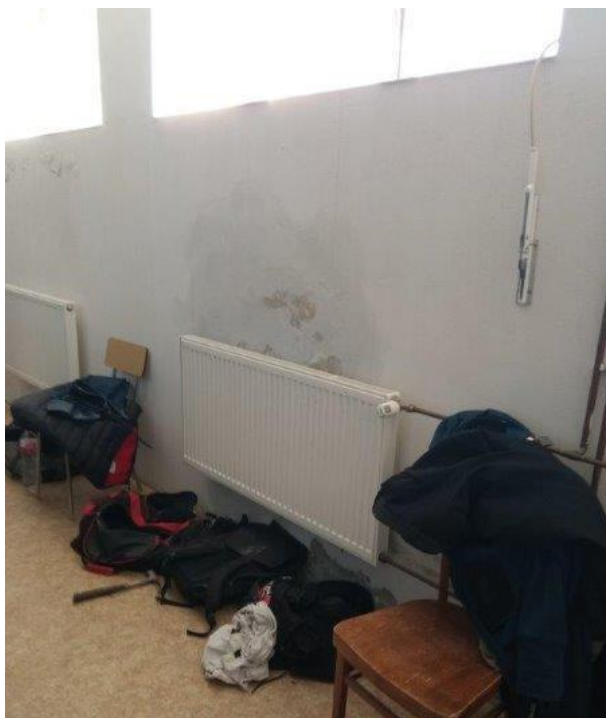
Foto 45: Stav sanačních omítek na obvodové zdi v místnosti šaten personálu.
