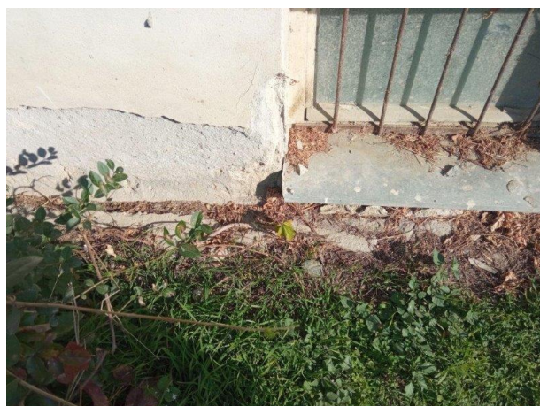
Foto 19: Detail stavu soklové části fasády zadního traktu v podsklepené části
