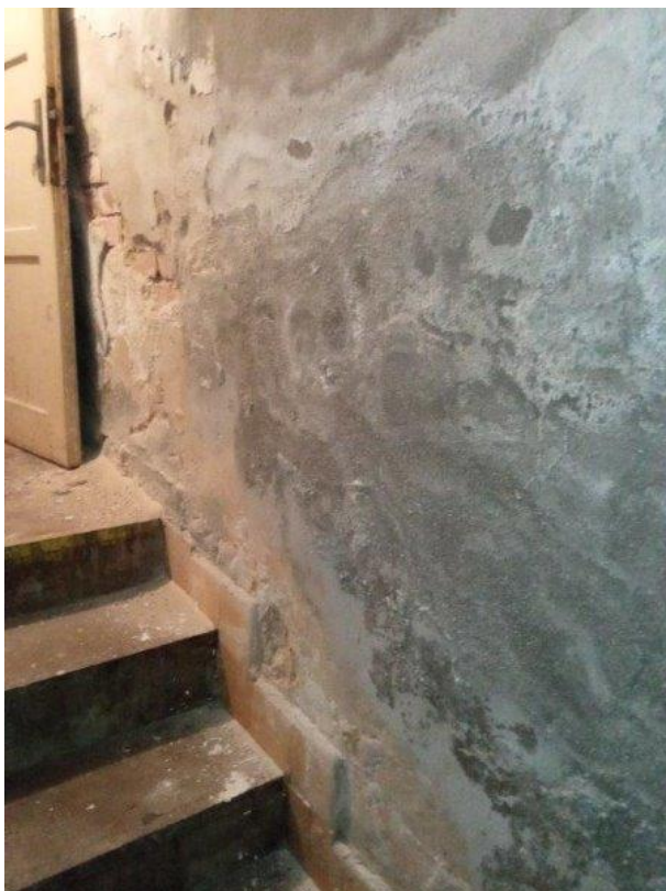
Foto 39: Stav omítek v 1.PP. Viditelný výskyt solných výkvětů
