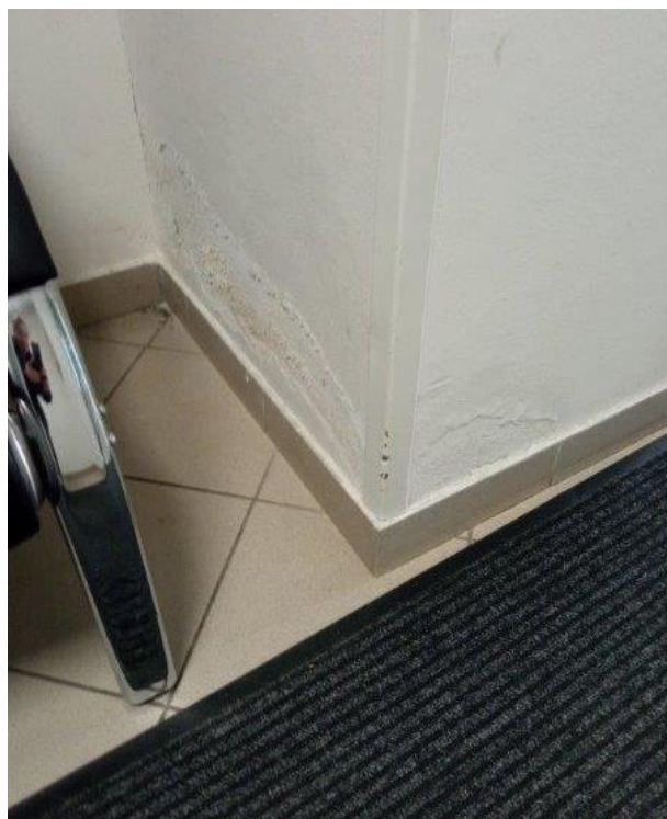
Foto 36: Vlhkostní projev na zdivu v chodbě 1.NP nemocnice.
