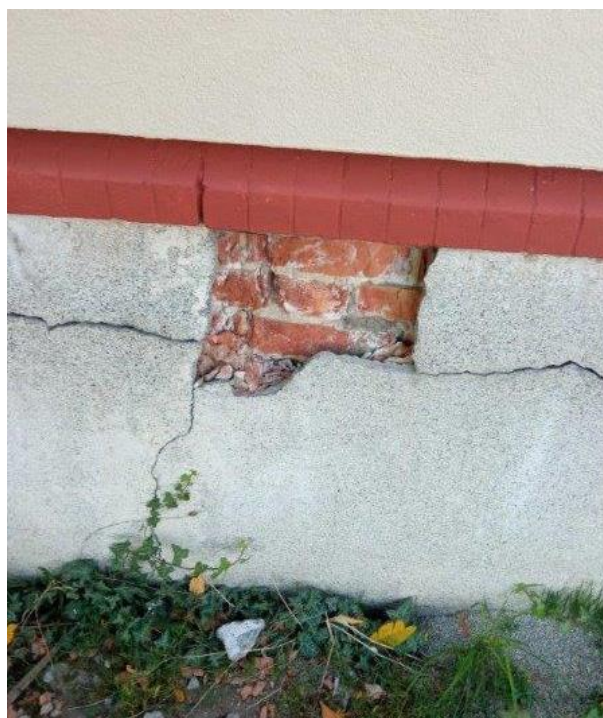
Foto 14: Detail poškození fasádního soklu z umělého kamene
