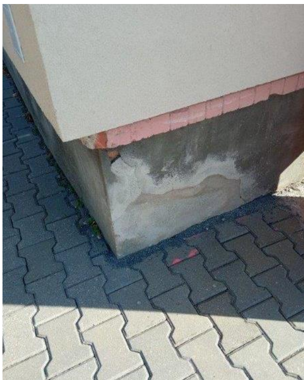
Foto 27: Vlhkostní poškození soklové omítky v podsklepené části budovy laboratoří a vedení nemocnice.
