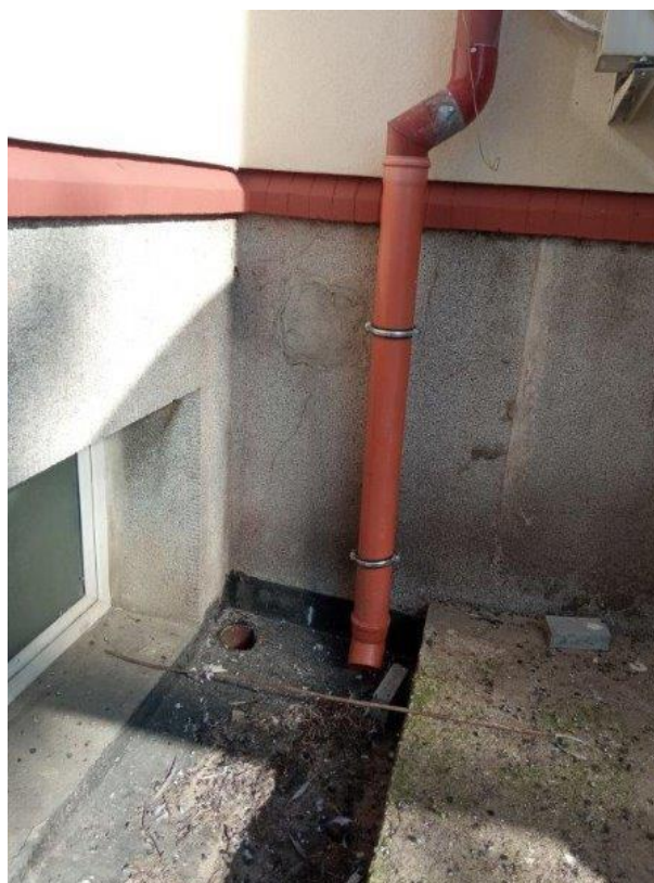
Foto 16: Vyústění okapového svodu do anglického dvorku – naprosto nevhodné řešení
