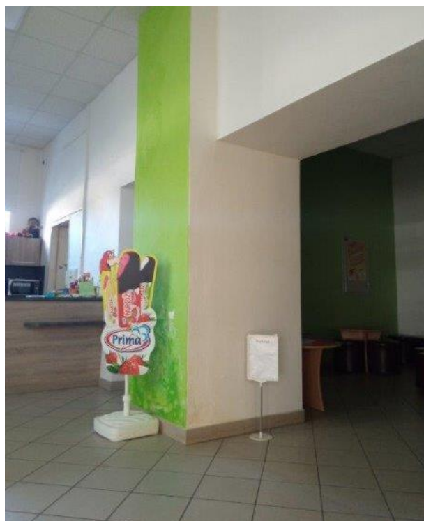
Foto 35: Negativní vlhkostní projevy na dolní části pilíře v 1.nnp v místě napojení přístavby vstupu na původní objekt. Pravděpodobně dochází k zatékání ze střechy
