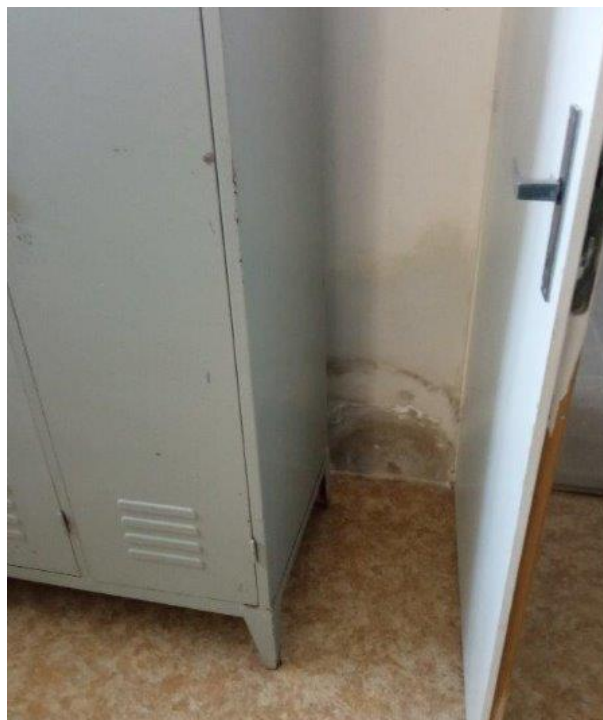
Foto 46: Stav sanačních omítek na obvodové zdi v místnosti šaten personálu
