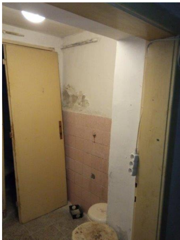
Foto 34: Viditelné stopy poruch kanalizace v neprovozovaných místnostech sociálek v budově laboratoře a vedení nemocnice.
