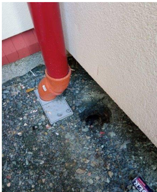
Foto 22: Zaústění jednoho ze střešních svodů, viditelná původní kanalizační roura, kterou může do suterénu zatékat srážková voda z povrchu terénu
