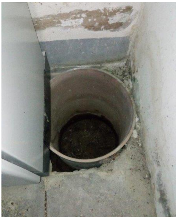
Foto 43: Provizorní kontrolní šachta pro monitoring hladiny podzemní vody
