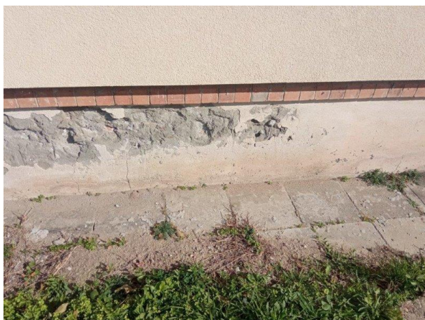
Foto 21: Detail poškozené cementové soklové omítky v nepodsklepené části zadního traktu.
