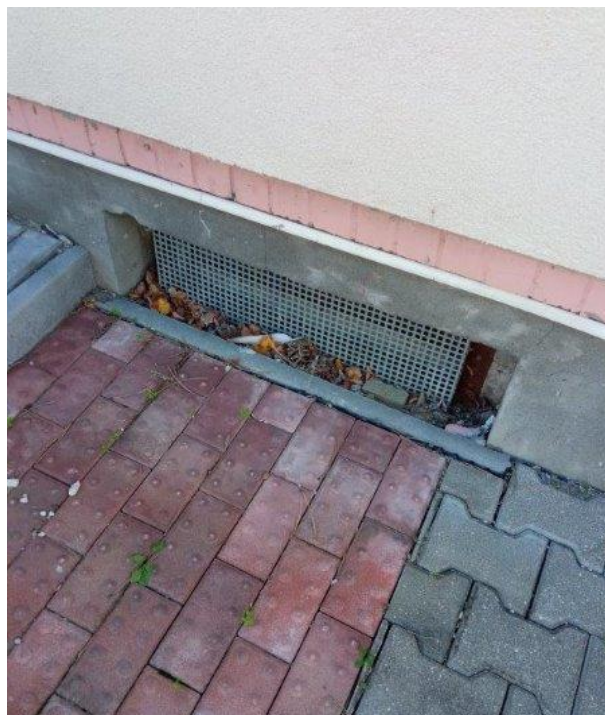
Foto 26: Pohled na nesprávné řešení parapetu sklepního okénka v budově laboratoře a vedení nemocnice. Srážková voda může z povrchu chodníku volně zatékat do okenního otvoru a následně do 1.PP
