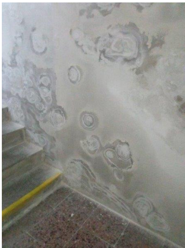
Foto 29: Stav sanačních omítek na obvodové zdi suterénu v budově laboratoří a vedení nemocnice. Viditelný výskyt solných výkvětů.
