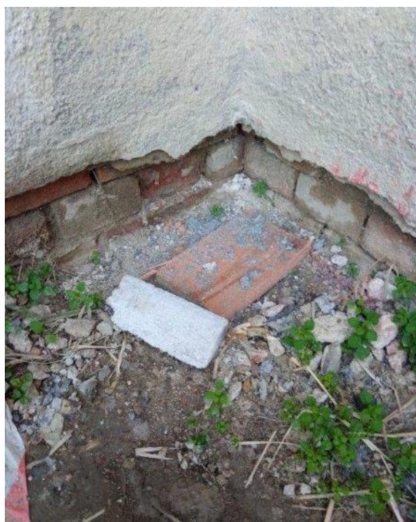
Foto 24: Detail provedení paty zdi ve volném terénu v místě viz foto 6. Je evidentní, že v tomto místě neexistuje svislá Hl obvodové zdi a srážková voda z povrchu terénu volně zatéká do zdiva
