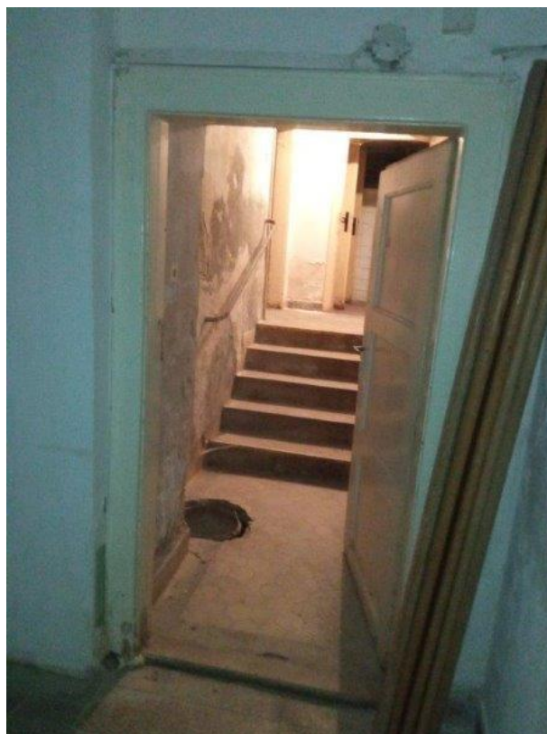
Foto 38: Pohled do prostor nepoužívaného sociálního zařízení v suterénu
