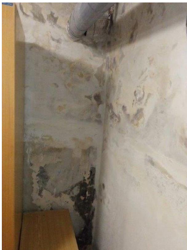
Foto 33: Stav omítek v místnosti šatny personálu laboratoře v 1.PP budovy laboratoře a vedení nemocnice
