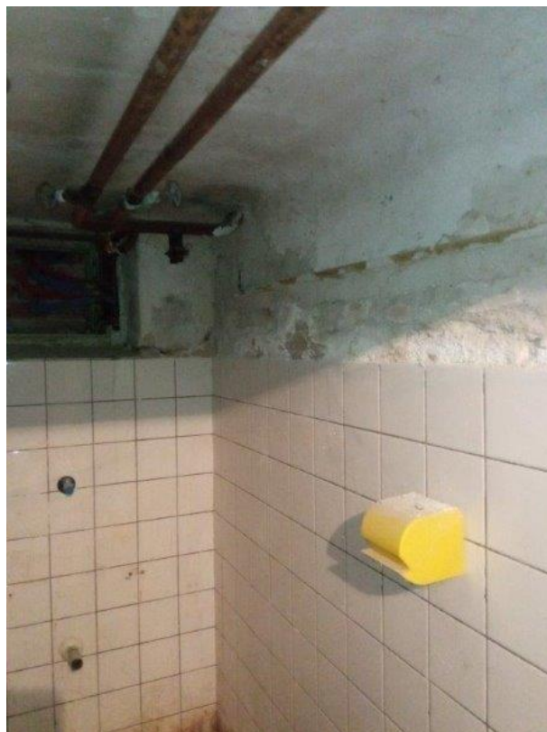
Foto 40: Stav omítek v 1.PP
