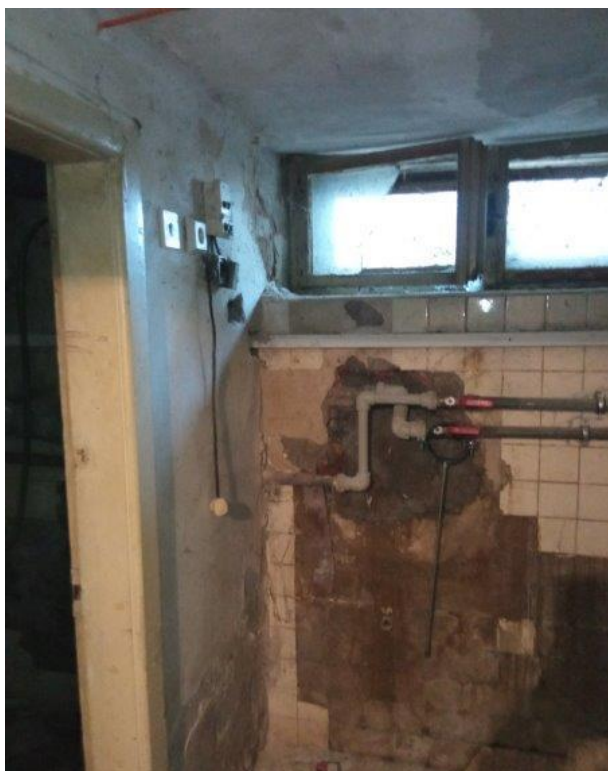
Foto 41: Stav omítek v 1.PP
