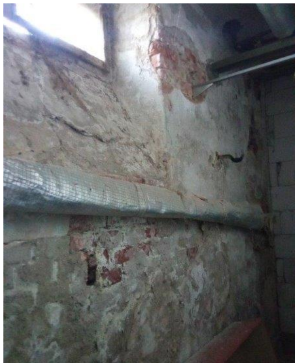
Foto 44: Stav omítek na obvodovém zdivu v 1.PP
