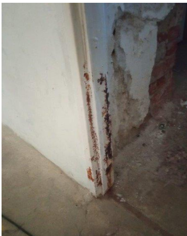
Foto 47: Stav omítek na vnitřním zdivu v suterénu, viditelná koroze kovových stavebních prvků způsobená vysokou vlhkostí, solemi a také následnou kondenzací vzdušné vlhkosti na povrchu konstrukcí
