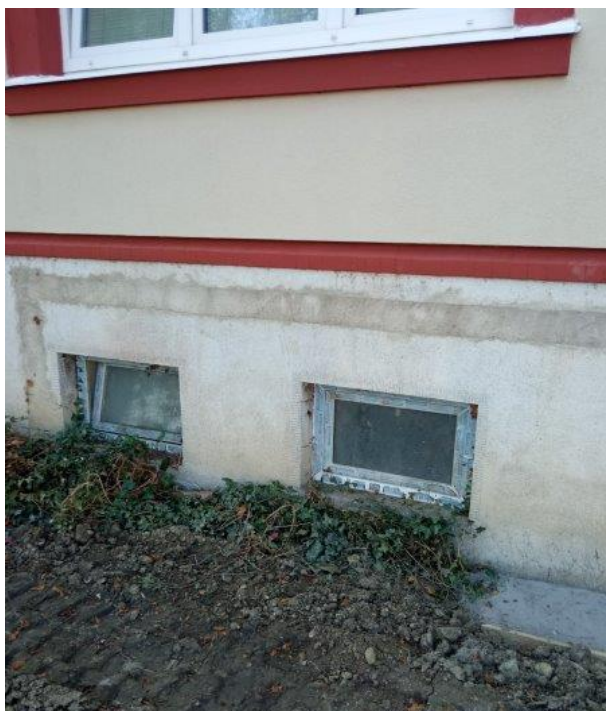
Foto 25: Detailní soklové části fasády směřem do ulice, výskyt vegetace jasně svědčí o netěsnosti spáry na styku povrchu terénu a obvodové zdi.
