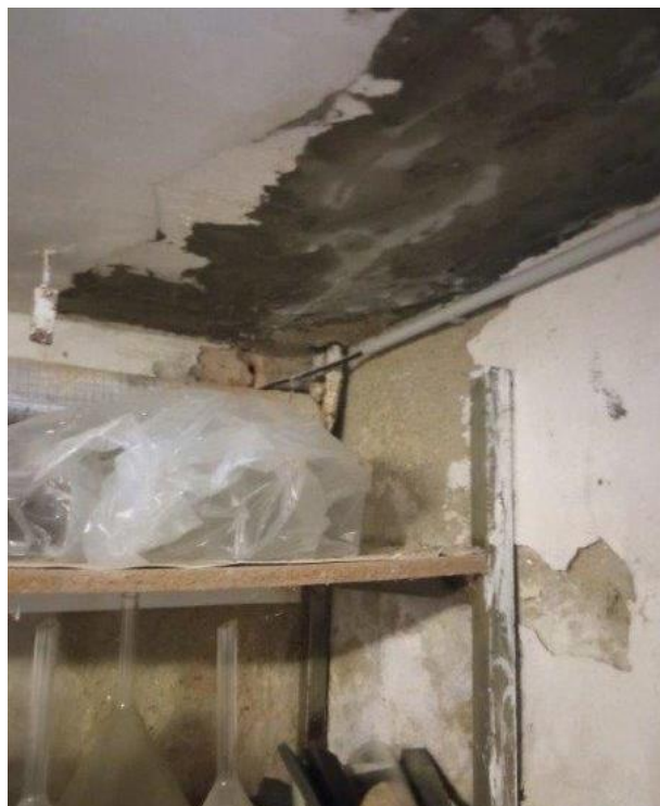
Foto 31: V minulosti provedená oprava omítky stropu, pravděpodobně po poruše kanalizace. 1.PP budovy laboratoří a vedení nemocnice
