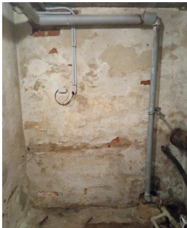
Foto 32: Stav omítek na zdi mezi podsklepenou a nepodsklepenou částí budovy laboratoří a vedení nemocnice, s viditelnými negativními projevy vlhkosti
