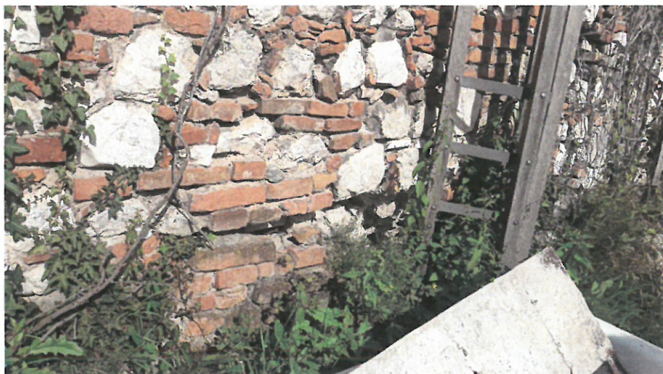
Obr. 4 – pohled na zdivo, ve spodní části jsou dutiny a kaverny, zvětralá malta mezi kamenem a cihlami
