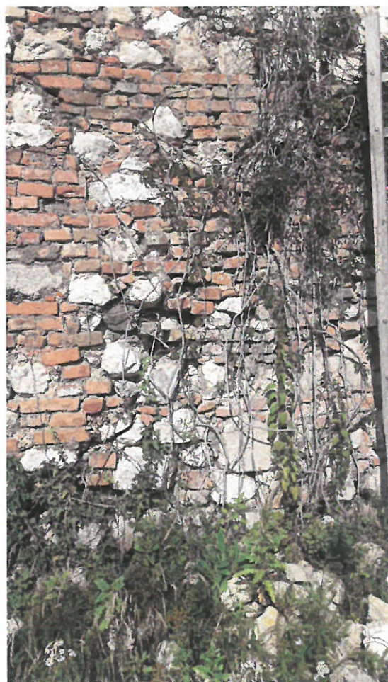
Obr. 6 – pohled na zdivo, ve spodní části jsou dutiny a kaverny, zvětralá malta mezi kamenem a cihlami
