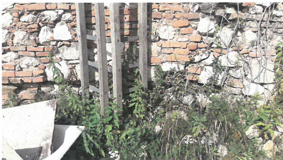
Obr. 5 – pohled na zdivo, ve spodní části jsou dutiny a kaverny, zvětralá malta mezi kamenem a cihlami
