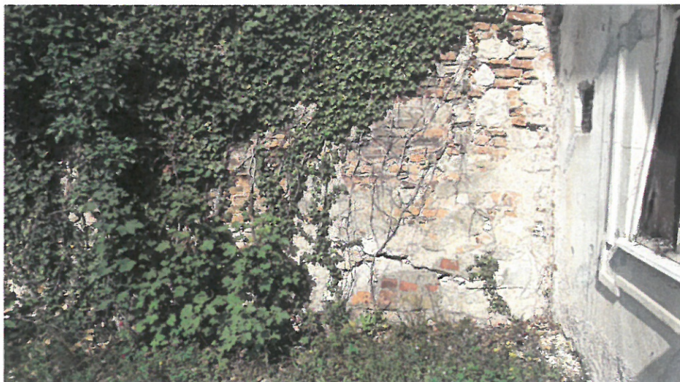
Obr. 7 – pohled na zdivo, ve spodní části jsou dutiny a kaverny, zvětralá malta mezi kamenem a cihlami
