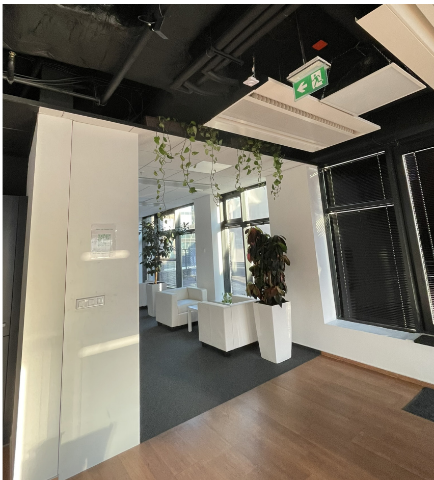
Návaznost zvýšeného stropu na podhledy, zavěšené prvky
