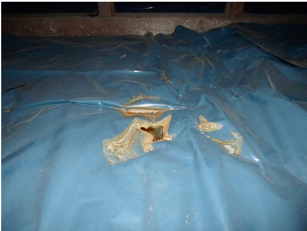
Foto 44 – porucha A: Pohled na kaluž se stojící vodou
