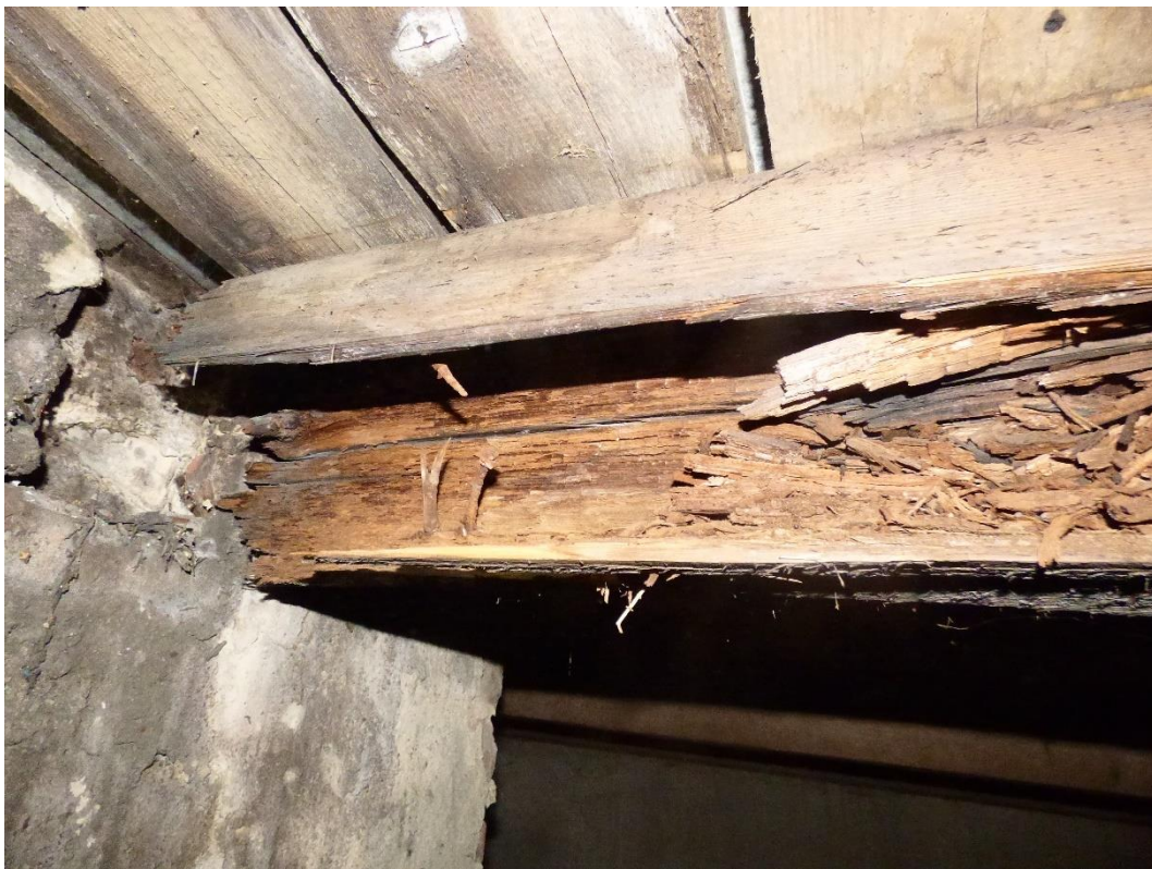
Foto 46 – porucha B: Pohled na shnilou krokev.
