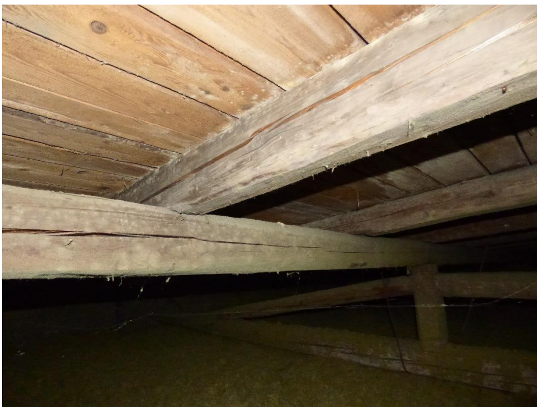
Foto 25 – porucha D: Plíseň na krokvi, vaznici a bednění.
