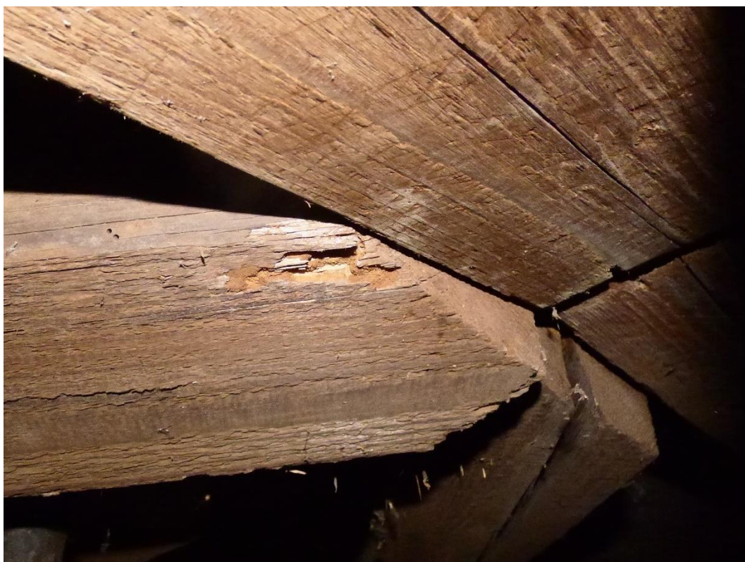
Foto 71 – porucha A: Napadení dřevokazným hmyzem.
