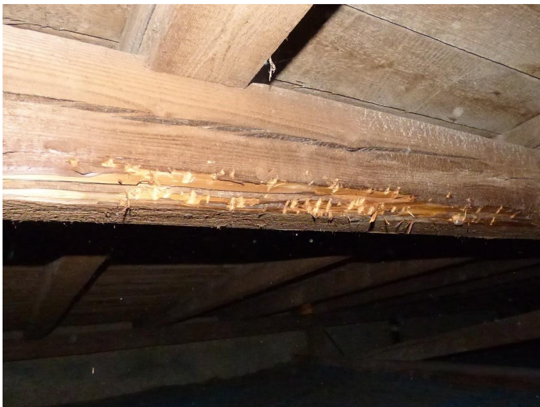
Foto 73 – porucha C: Poškození vaznice.
