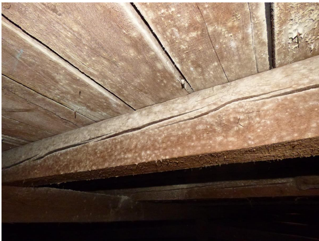
Foto 61 – porucha A: Plíseň na krokvi a bednění.
