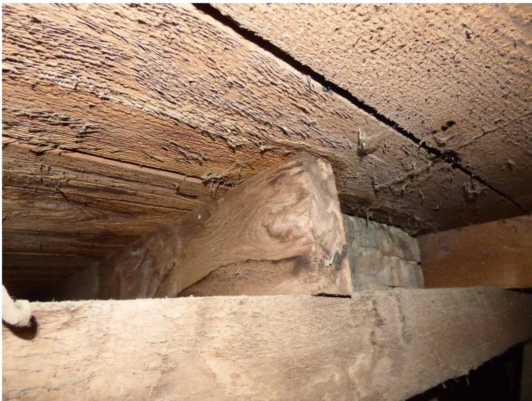
Foto 12 – porucha A: Historické stopy po zatečení na bednění a vazniče.
