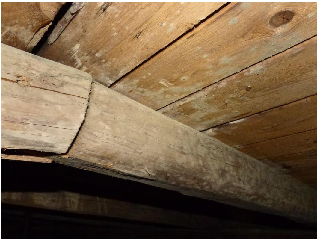
Foto 24 – porucha D: Plíseň na krokvi a bednění.
