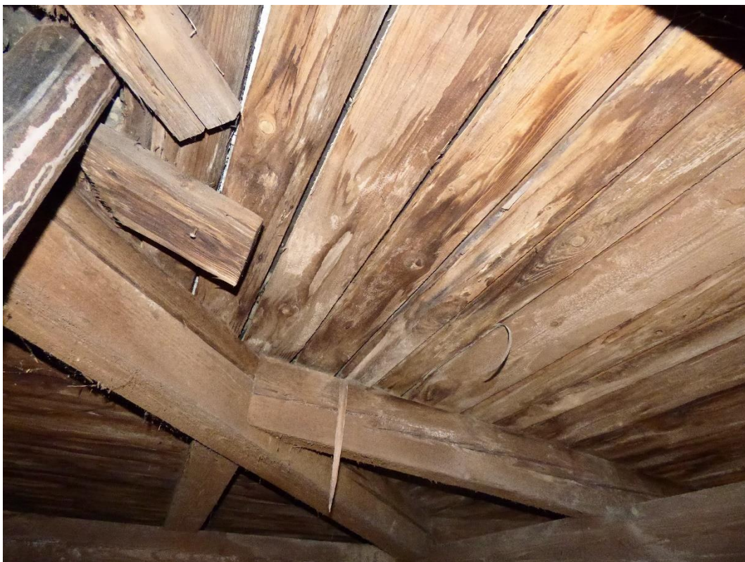
Foto 43 – porucha A: Pohled na stopy po zatečení.
