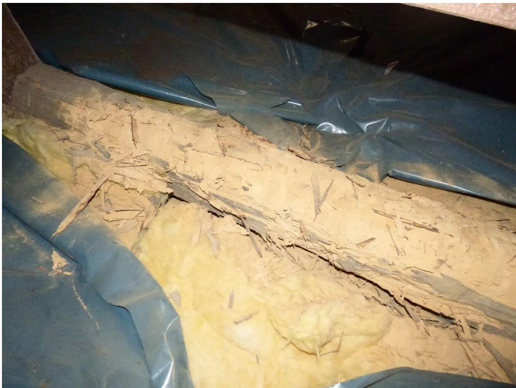
Foto 75 – porucha E: Napadení dřevokazným hmyzem.
