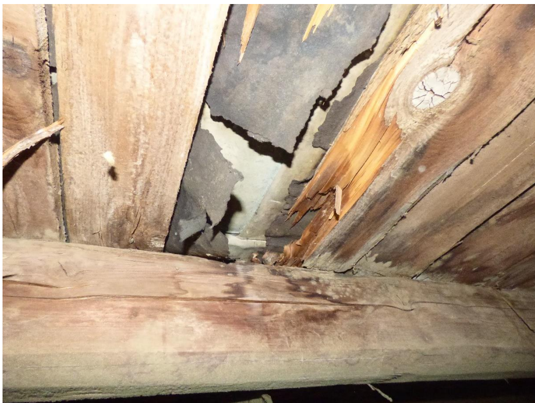
Foto 22 – porucha B: Hniloba bednění a krokve včetně chybějícího prkna bednění.
