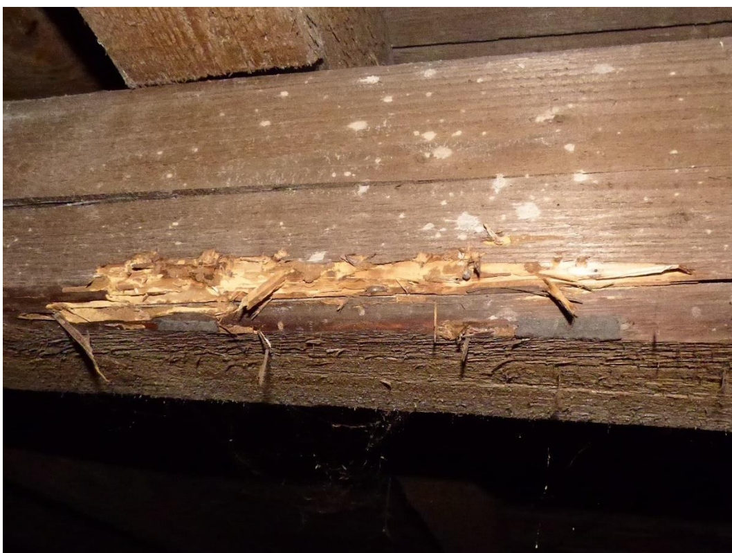
Foto 76 – porucha F: Napadení dřevokazným hmyzem.
