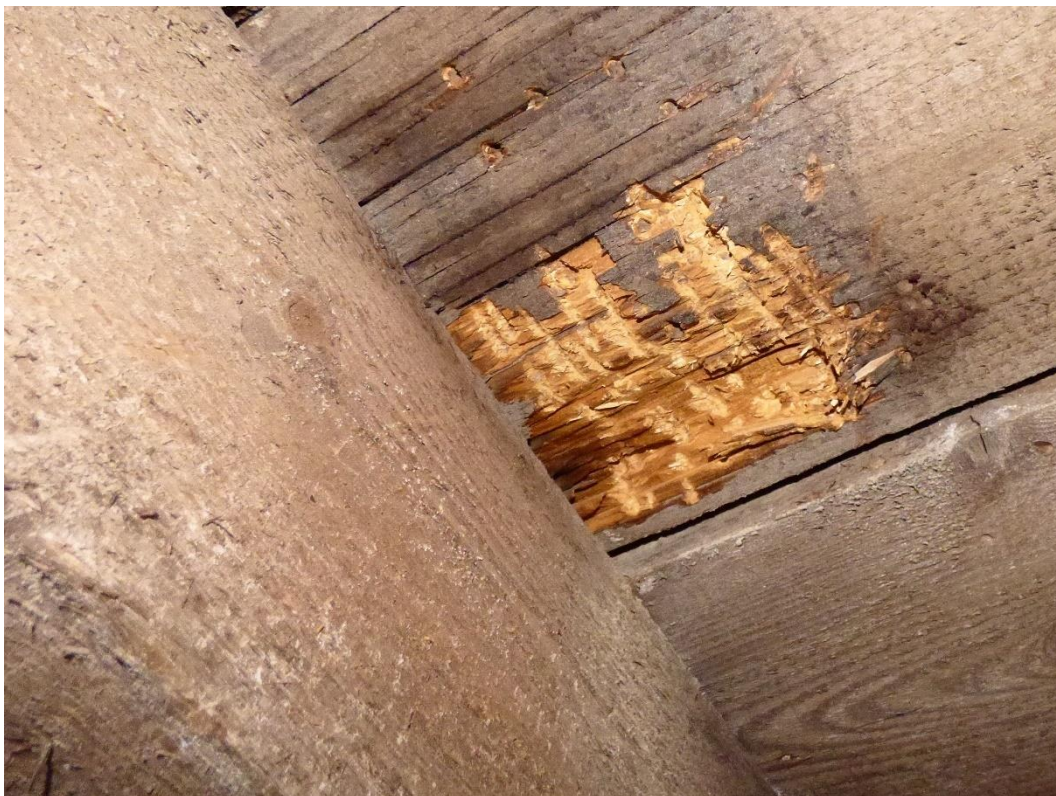
Foto 77 – porucha G: Shnilé prkno bednění.
