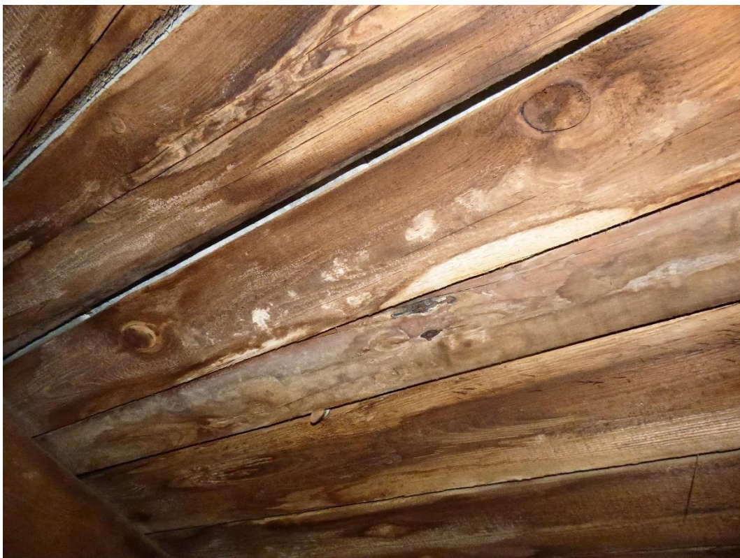
Foto 42 – porucha A: Pohled na stopy po zatečení.
