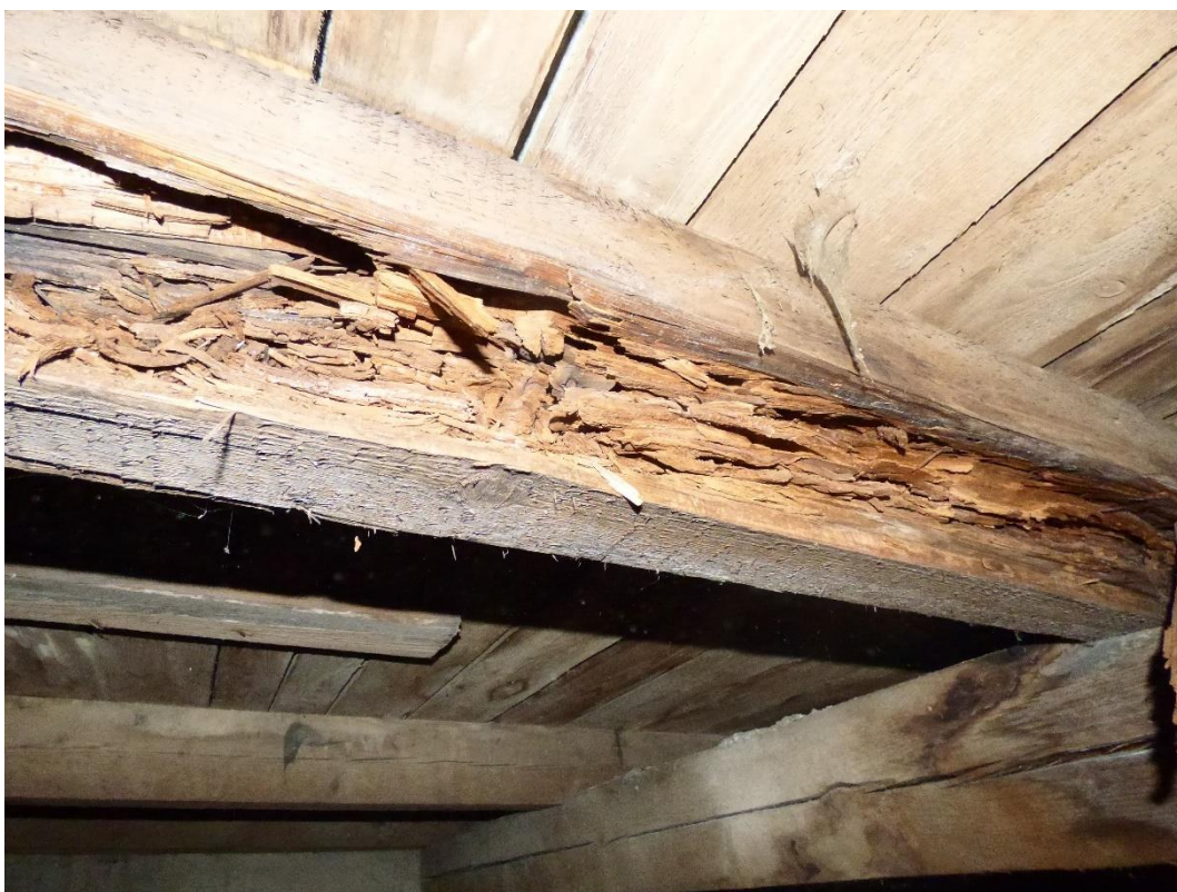
Foto 47 – porucha B: Pohled na shnilou krokev.
