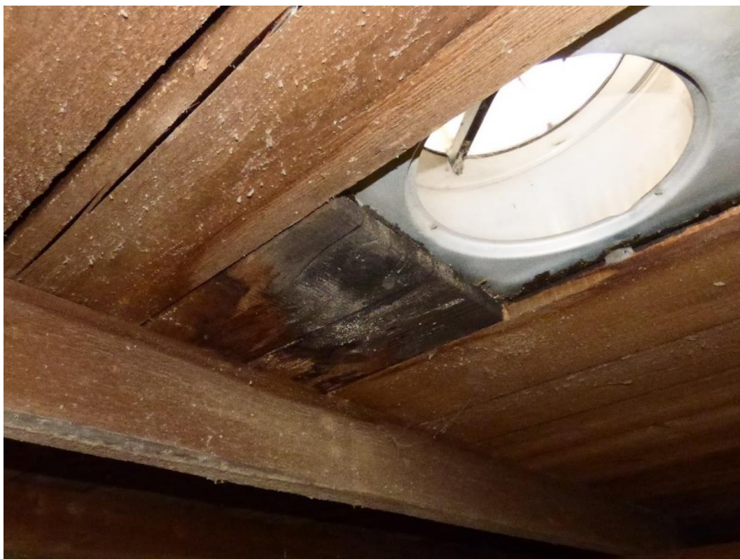
Foto 14 – porucha B: Detailní pohled na poškození bednění vlivem kondenzace par na bednění.
