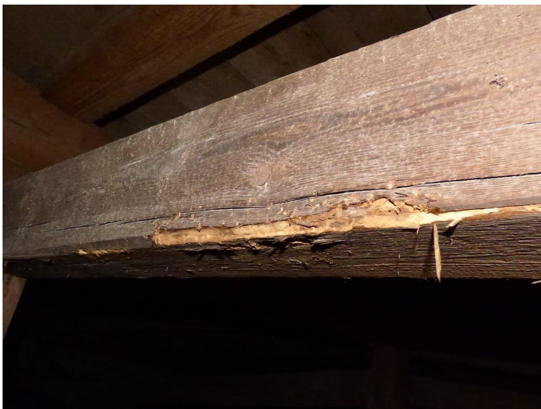
Foto 72 – porucha B: Napadení dřevokazným hmyzem.
