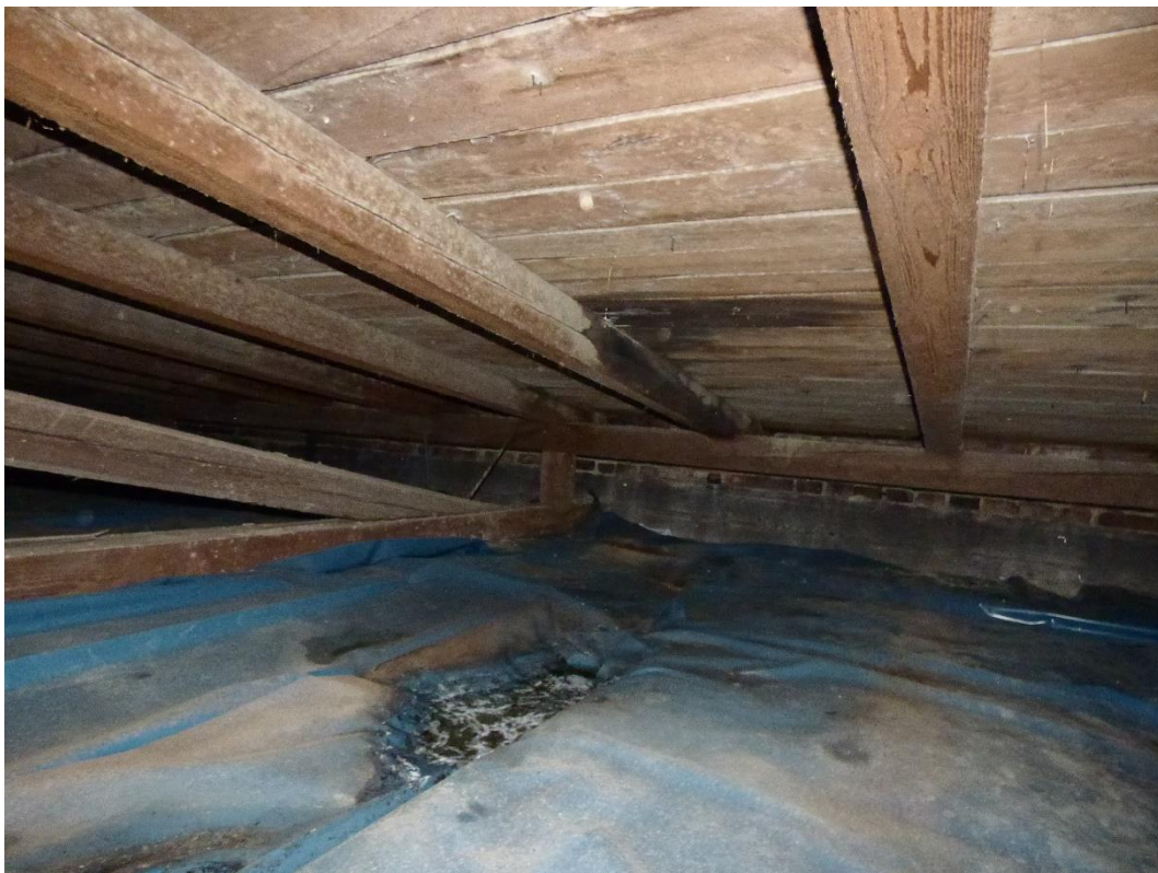
Foto 62 – porucha B: Čerstvé stopy po zatečení na bednění a krokvi, včetně kaluží na fólii.
