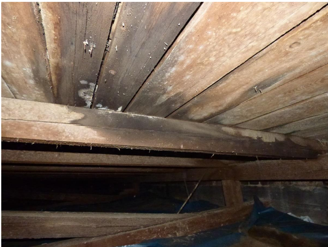
Foto 64 – porucha B: Čerstvé stopy po zatečení na bednění a krokvi.
