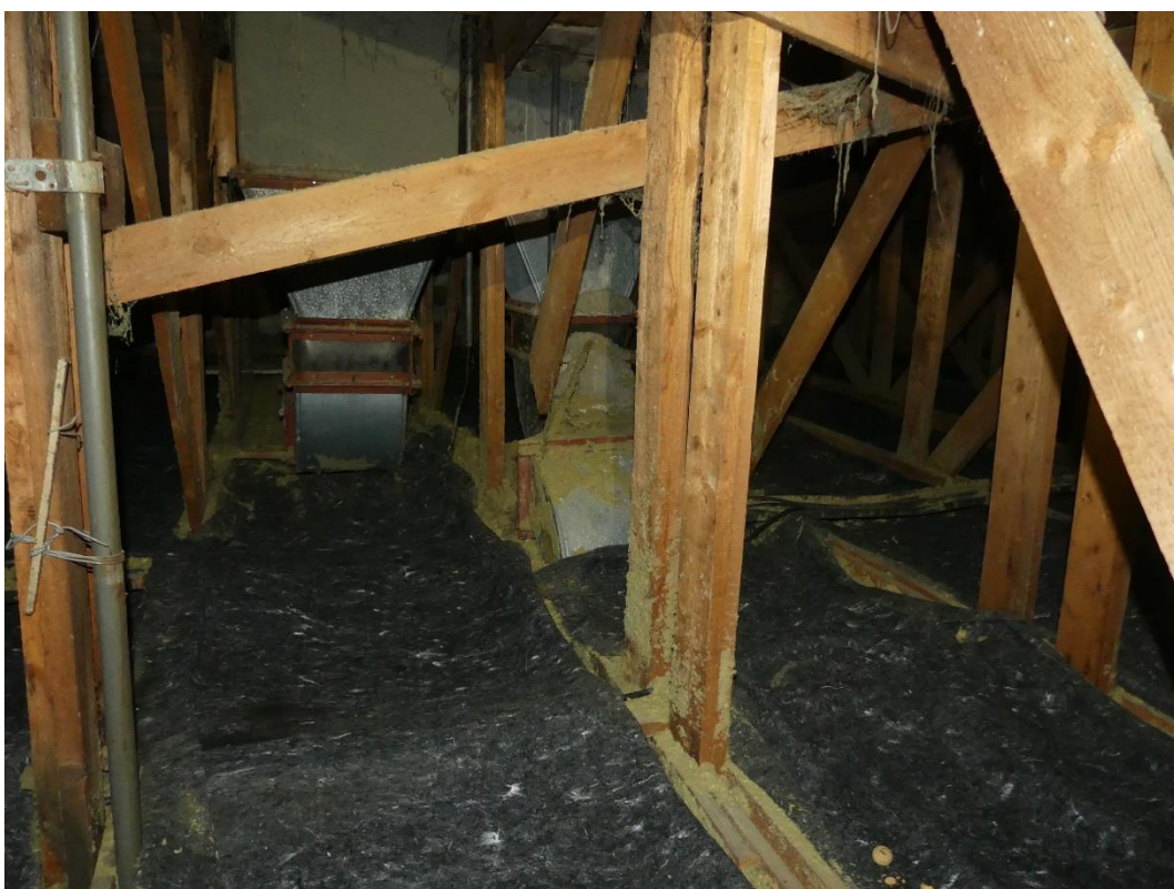
Foto 81 – porucha C: Uříznutý spodní pás z důvodu vedení potrubí vzduchotechniky.
