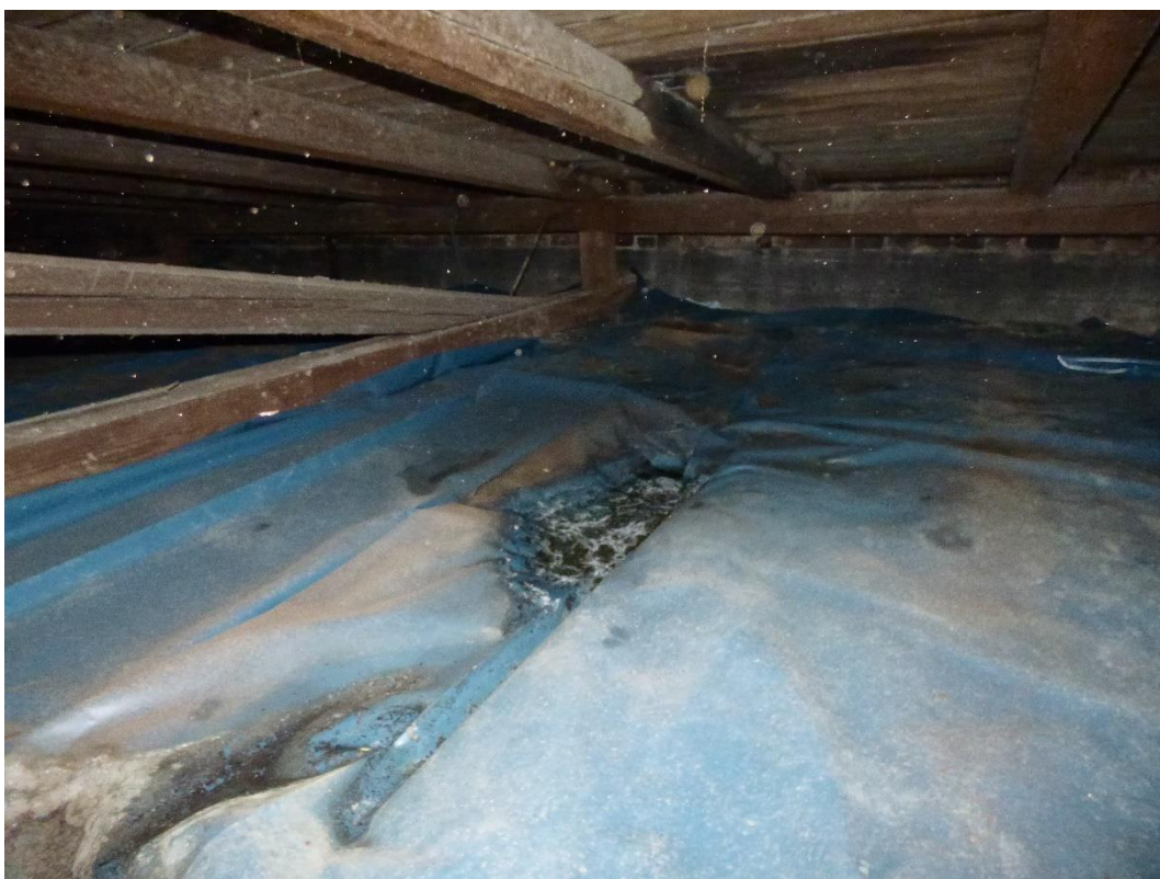
Foto 63 – porucha B: Čerstvé stopy po zatečení na bednění a krokvi, včetně kaluží na fólii.
