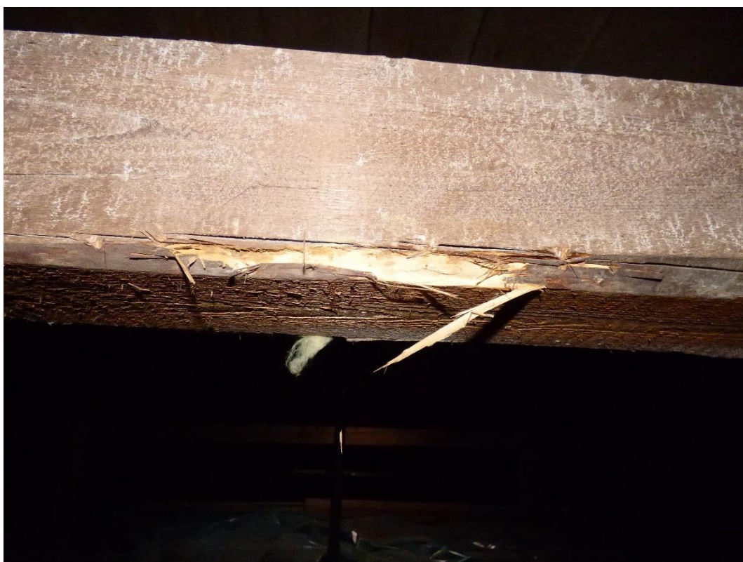
Foto 74 – porucha D: Napadení dřevokazným hmyzem.
