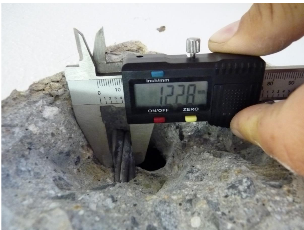
Foto 3: Pohled na obnažené lano železobetonového dutinového panelu. Průměr lana 12 mm.
