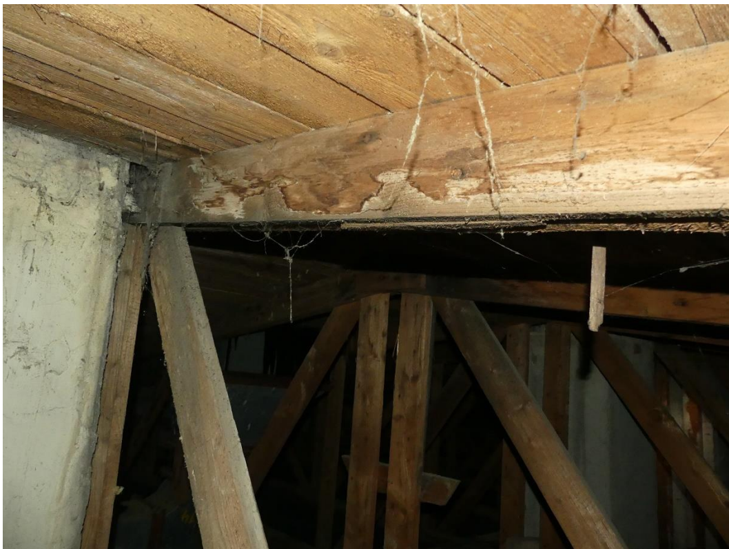
Foto 78 – porucha A: Stopy po zatečení na horním pásu.
