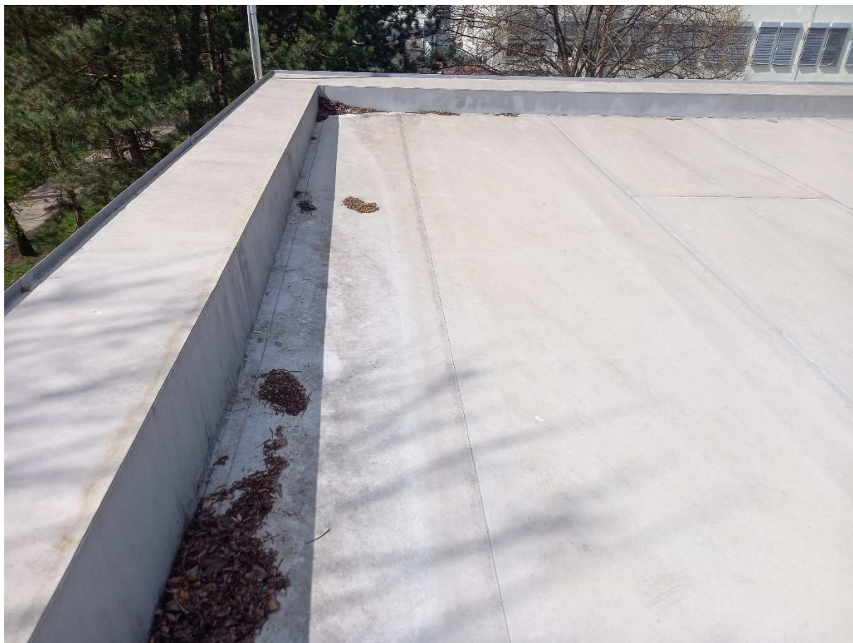
Fotografie 6 – Pořízena autorem zprávy – Nános listí svědčí o absenci údržby. Norma ČSN 731901 předpokládá kontrolu a údržbu minimálně každých 6 měsíců.
