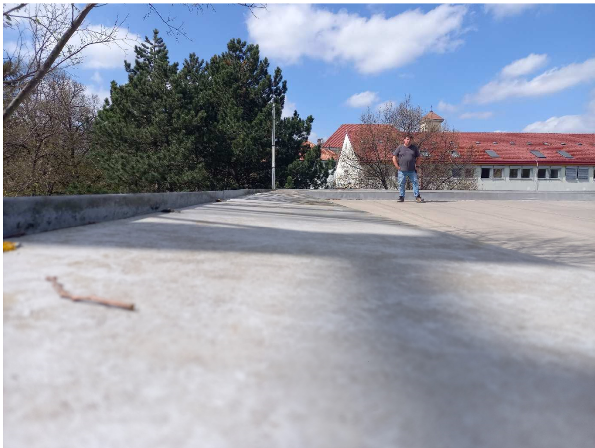
Fotografie 7 – Pořízena autorem zprávy – Spád atiky je znatelný, ale v celé délce nedosahuje požadovaného sklonu 3°.
