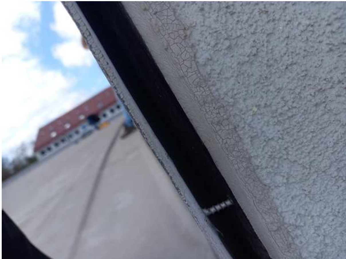
Fotografie 11 – Pořízena autorem zprávy – I na levé straně (při pohledu od okapové hrany) je stěnová lišta na svislé části odtržena.
