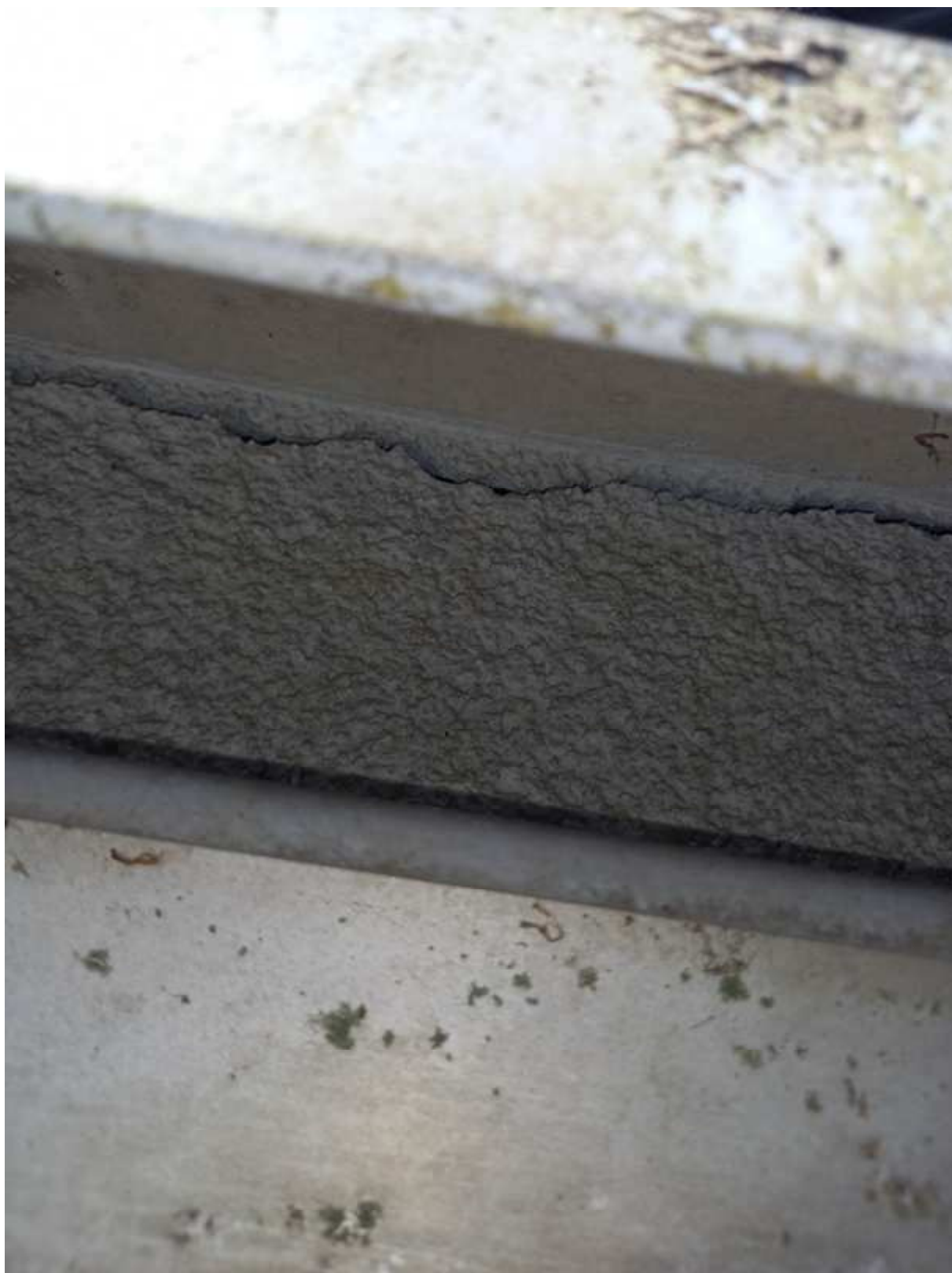
Fotografie 8 – Pořízena autorem zprávy – Prasklina fasádního systému pod okapovým plechem. Ke vnikání vody do konstrukce ale může dojít jen díky vodě odstříkující ze žlabu.
