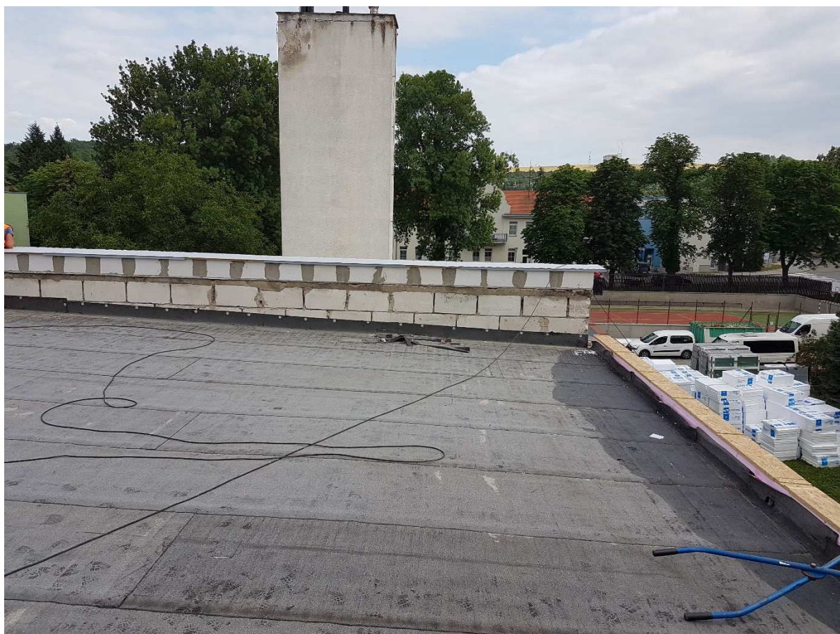
Fotografie 17 – Poskytnuto objednatelem zprávy – Pořízeno při dříve prováděné rekonstrukci. Na tomto snímku je ještě nedokonale provedená parozábrana vůči atice a okapové hraně. Předpokládám, že bylo dořešeno při realizaci.
