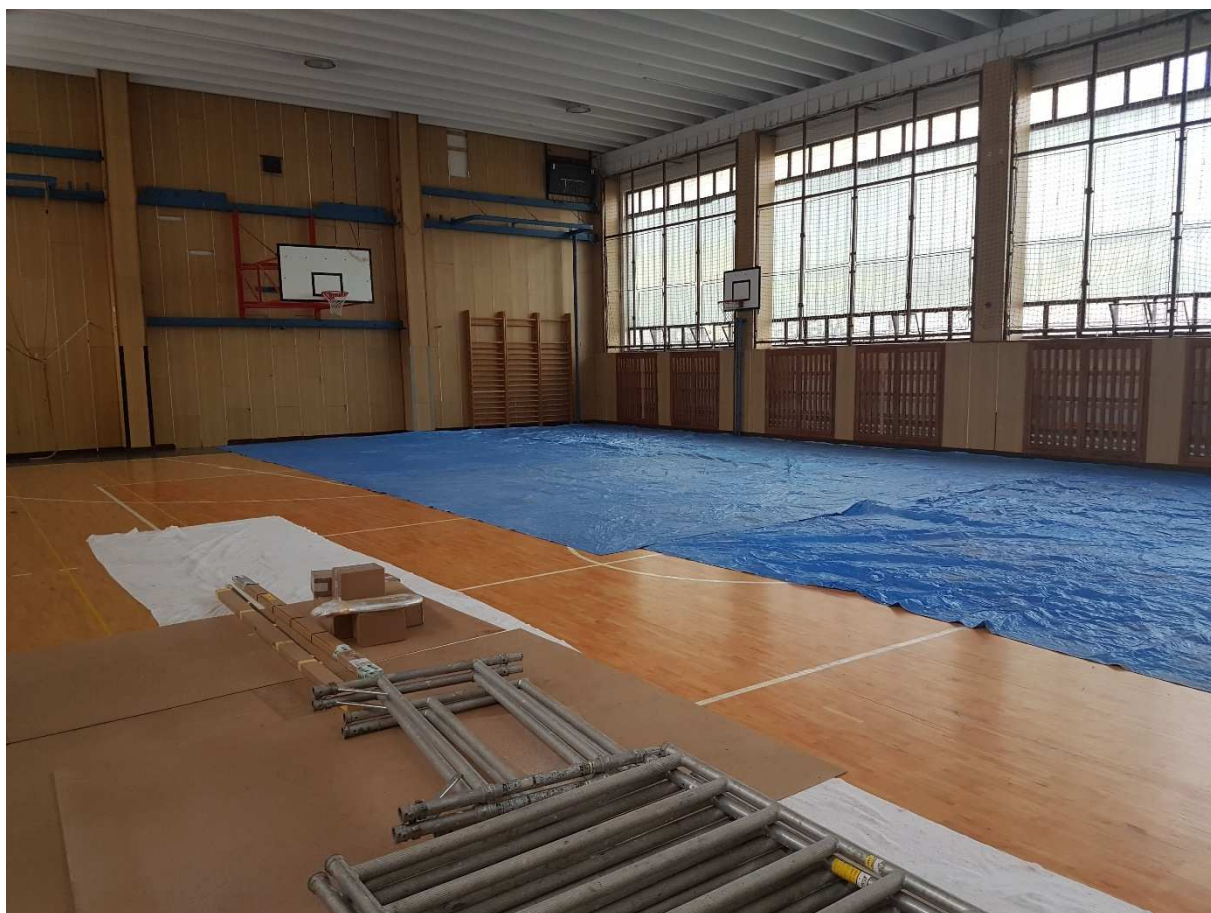
Fotografie 12 – Poskytnuto objednatelem zprávy – Pořízeno při dříve prováděné rekonstrukci. Pohled z interiéru.
