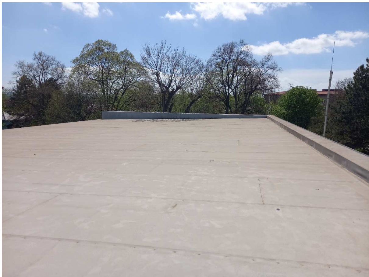
Fotografie 2 – Pořízena autorem zprávy – I u hrany pultu střechy je drobná deformace díky posunu koutové lišty, ale je mnohem menší, než u boční atiky.
