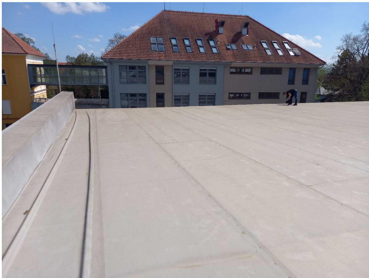
Fotografie 1 – Pořízena autorem zprávy – Pohled na střechu a deformace hydroizolace díky posunu koutové lišty.
