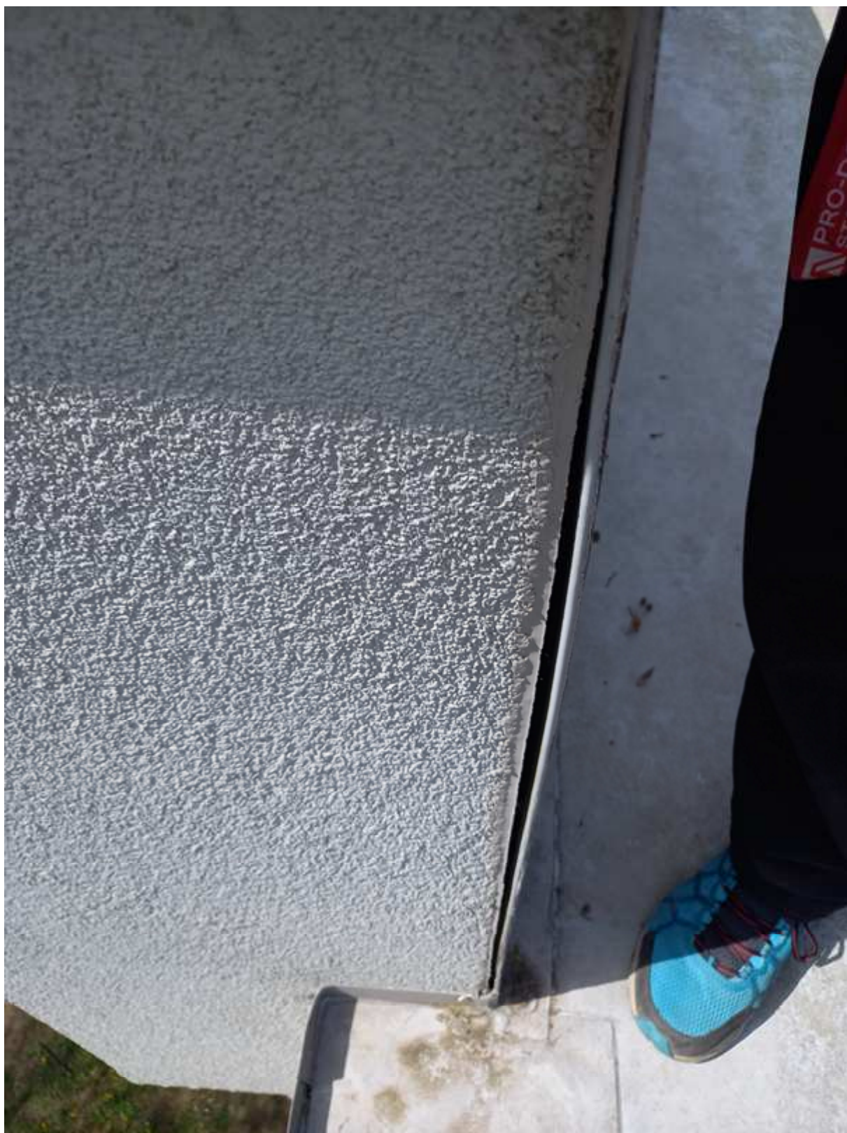
Fotografie 9 – Pořízena autorem zprávy – Nedostatečně stabilizovaná a těsněná stěnová lišta v čele atiky. Zde nepochybně ke vnikání vody při určitém směru deště dochází.
