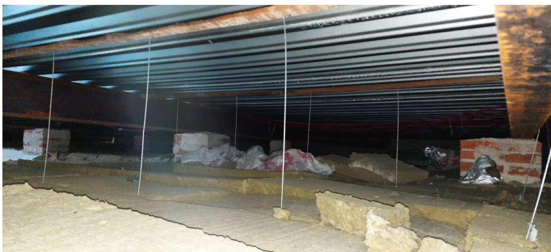
Uložení na střední nosnou stěnu a příčku nad chodbou, chybějící závěsy.
