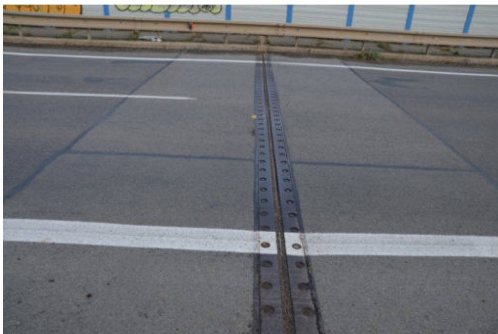
Obr.F78-44 Vozovka v místě MZ nad třetí mezilehlou podpěrrou. Pohled zprava doleva a dolů, - v okolí MZ byla v minulosti znovu provedena obrusný vrstva vozovky, - vyjeté mírné koleje, - zanesený těsnicí profil MZ posypovým materiálem a dalšími splaveninami.
