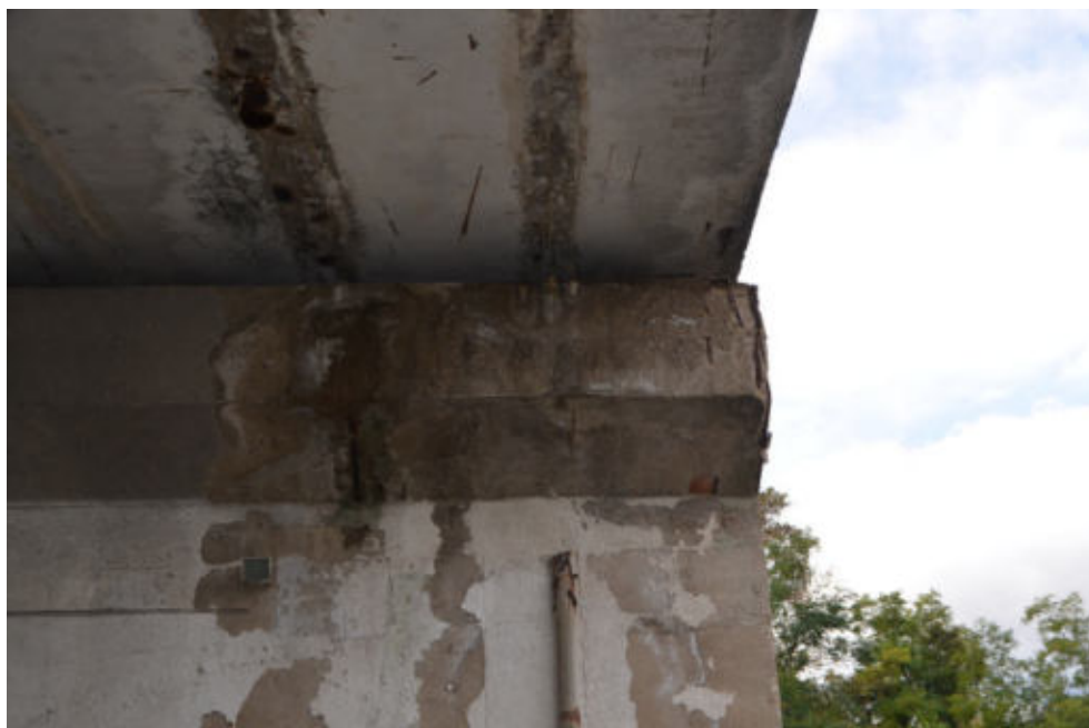
Obr.F78-13 Detail úložného prahu na pravé straně druhé, mezilehlé podpěry. Pohled proti směru staničení a vzhůru,
