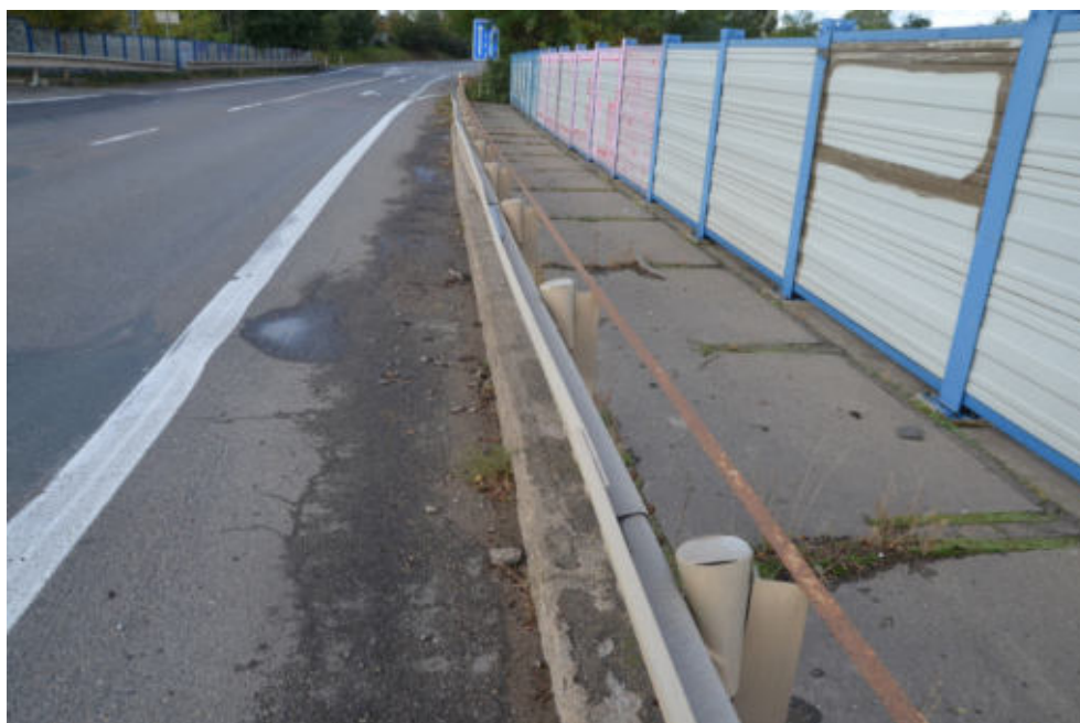
Obr.F78-52 Průhled levým okrajem za první podpěrou, znojenskou opěrou. Pohled proti směru staničení a dolů, - mechanicky deformovaná svodnice silničního svodidla, - větrání betonu chodníkového obrubníku, - lokální vysprávkky na vozovce.
