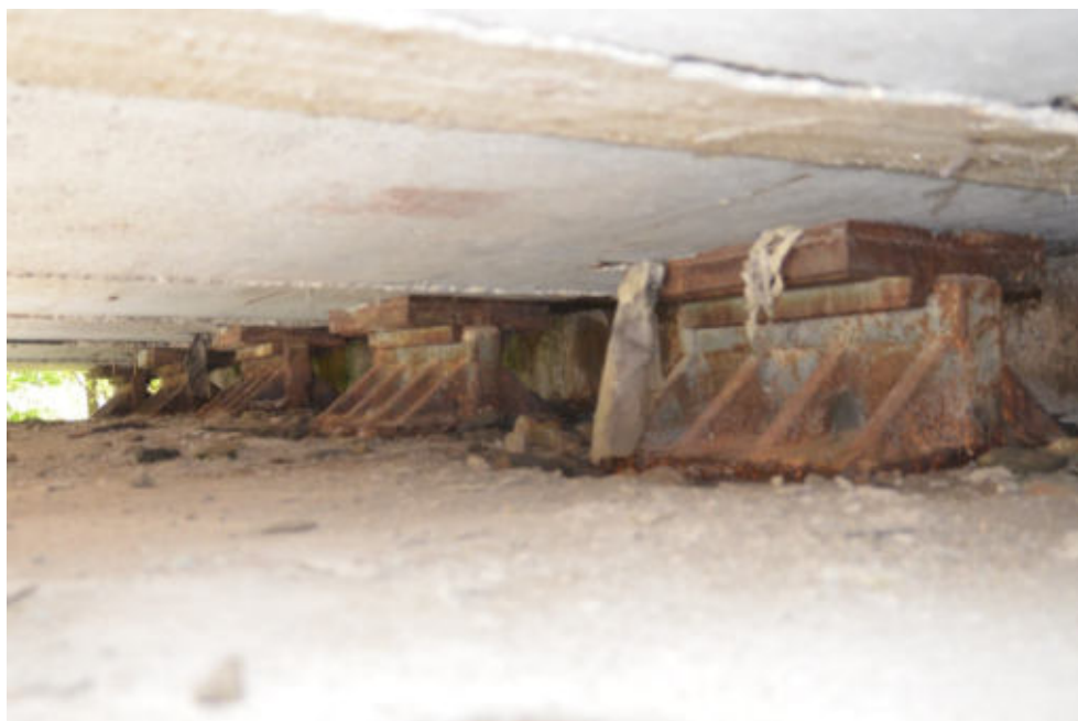
Obr.F78-37 Pevné ložiska č.7 až č.11 na první podpěře, znojemské opěře. Pohled proti směru staničení a zleva doprava, - nálitky (podložiskové bloky) nejsou provedeny, na horní ploše UP se po dešti zdržuje voda, která přispívá ke korozi ložisek, - nečistoty na horní ploše úložného prahu zadržují vlhkost, která přispívá ke korozi ložisek.
