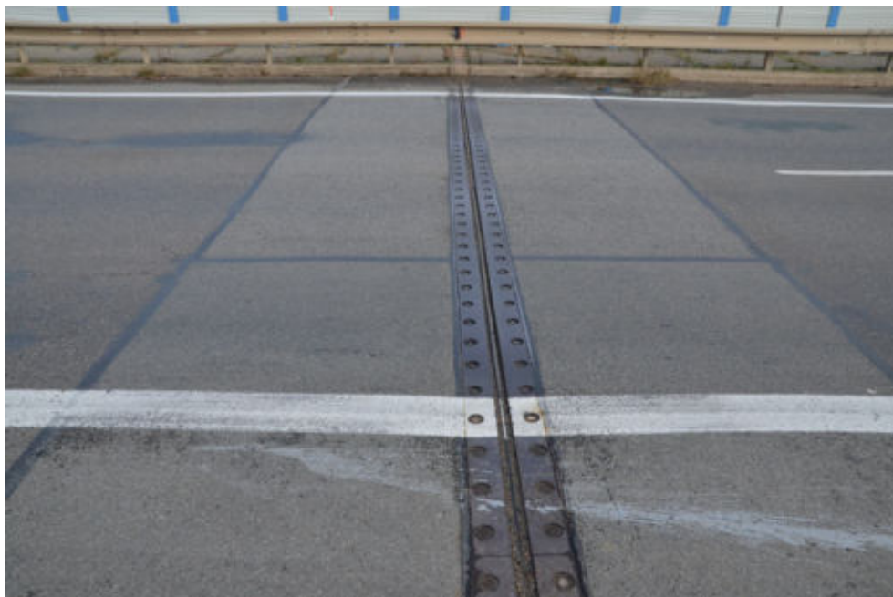
Obr.F78-41 Vozovka v místě MZ nad druhou mezilehlou podpěrrou. Pohled zprava doleva a dolů,
