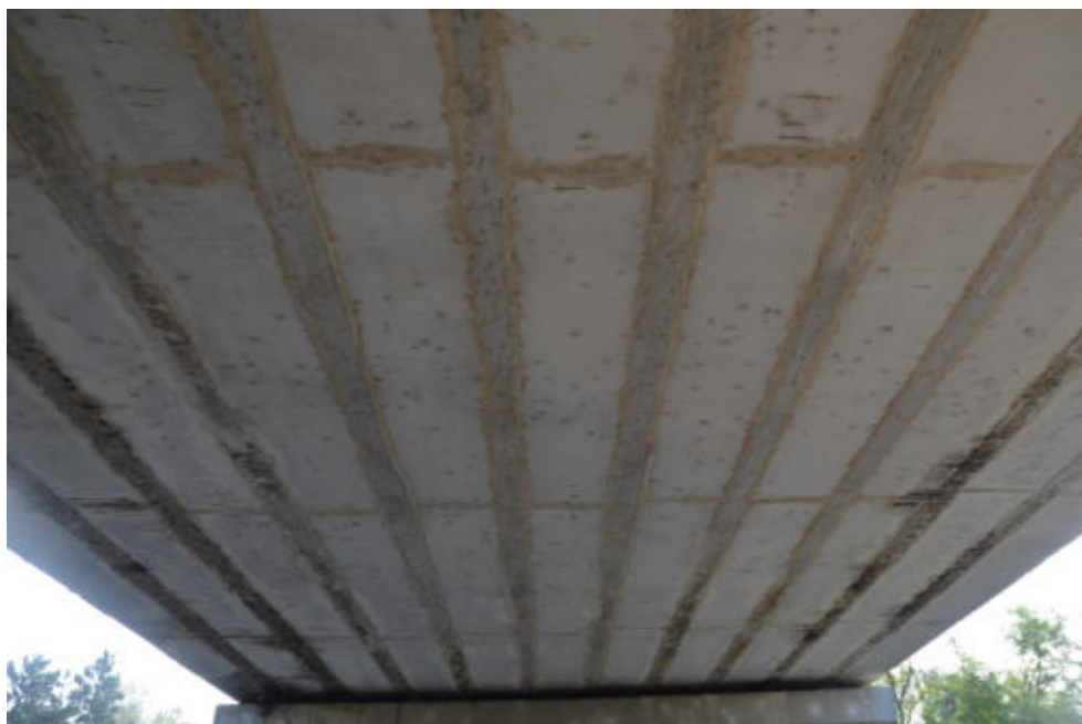
Obr.F78-29 Podhled druhé poloviny NK prvního pole mostu (zcela vlevo nosník č.1). Pohled od 1. opěry, ve směru staničení a vzhůru,
