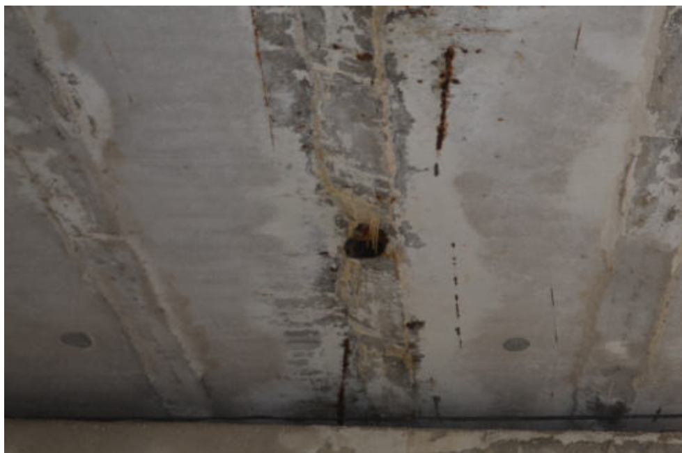
Obr.F78-31 Detail podélné spáry č.1 a č.2 ve 2. poli. Pohled proti směru staničení a vzhůru
