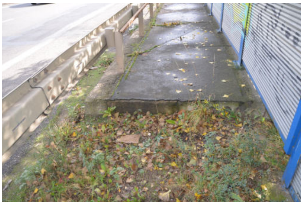
Obr.F78-51 Pravostranný okraj vozovky, chodníku, římsy a protihlukové zábrany na začátku mostu. Pohled ve směru staničení a dolů, - v popředí částečně odhalený římsový prefabrikát, - koroze šroubů svodidel, místy i sloupků v místě kotvení.
