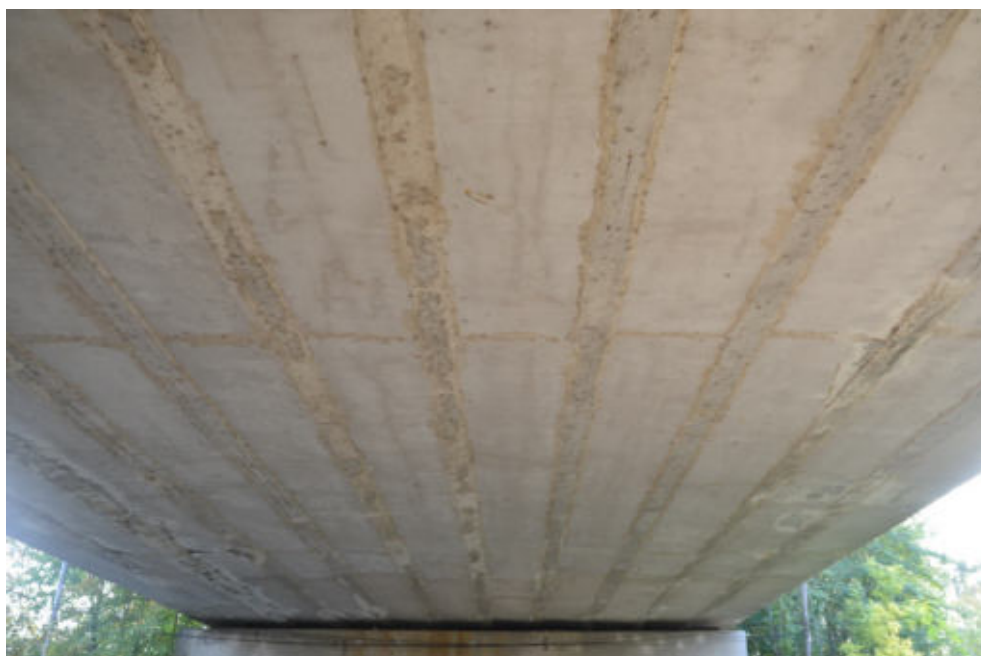
Obr.F78-34 Podhled druhé poloviny NK třetího pole mostu (zcela vlevo nosník č.1). Pohled od 3. mezilehlé podpěry ve směru staničení a vzhůru,
