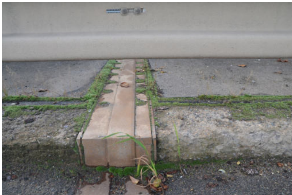
Obr.F78-43 Pravý chodník v místě MZ nad druhou mezilehlou podpěrrou. Pohled zleva doprava a dolů, - okolí MZ znečištěno, místy růst travin, - zanesený těsnicí profil MZ posypovým materiálem a dalšími splaveninami.
