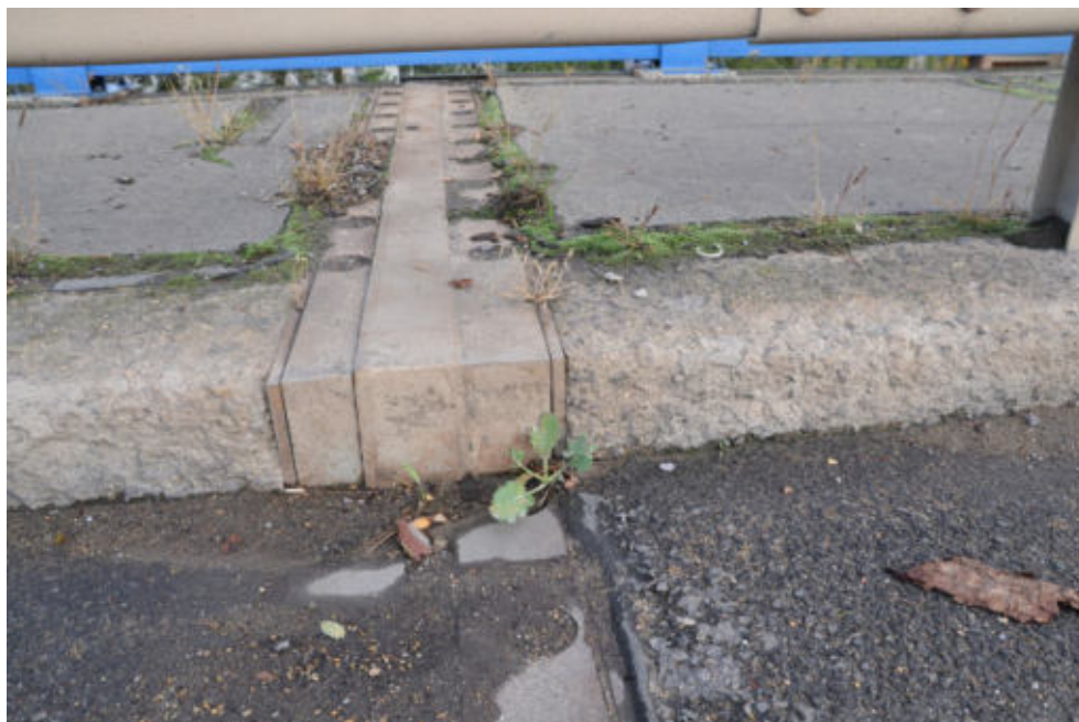
Obr.F78-45 Levý chodník v místě MZ nad třetí mezilehlou podpěrrou. Pohled zprava doleva a dolů, - okolí MZ znečištěno, místy růst travin, - zanesený těsnicí profil MZ posypovým materiálem a dalšími splaveninami.
