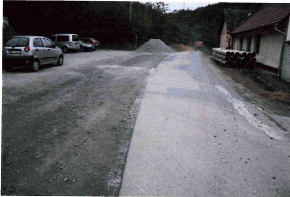
Hlubková koroze, podélné trhliny, vysprávký
