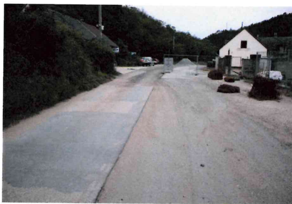
Hlubková koroze, vysprávký
