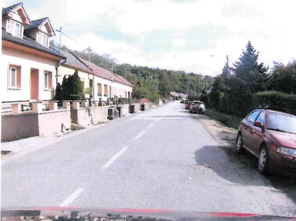
Hl. koroze, podélné, příčné a mozaikové trhliny, vysprávký
