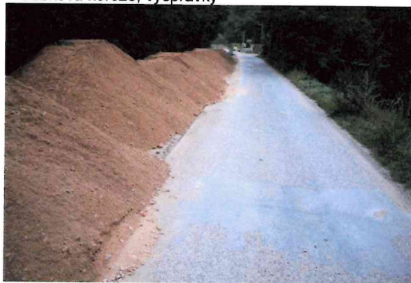
Hlubková koroze, zvýš. nebezpečná krajnice, vysprávký
