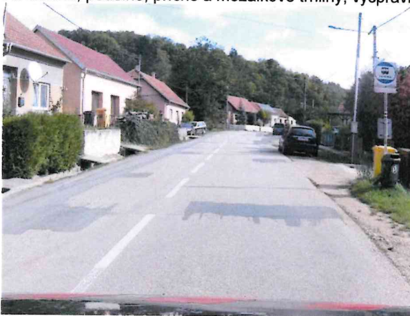
Hlubková koroze, příčné trhliny, vysprávký
