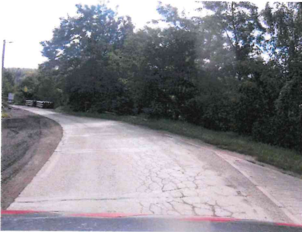
Hloubková koroze, příčné a mozaikové trhliny, vysprávky
