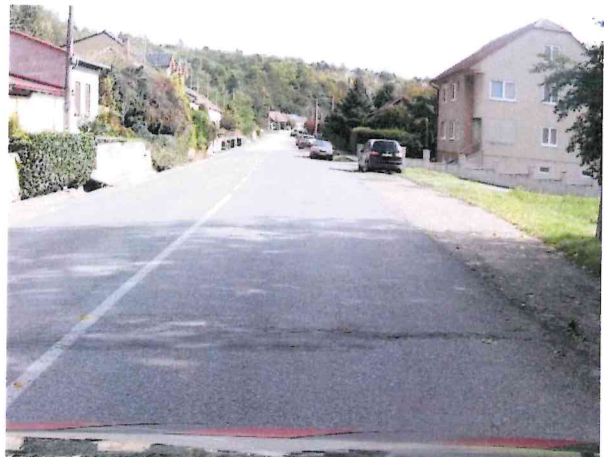
Hlubková koroze, příčné trhliny, vysprávký
