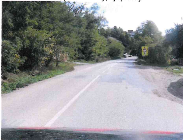
Hlubková koroze, podélné trhliny, vysprávký
