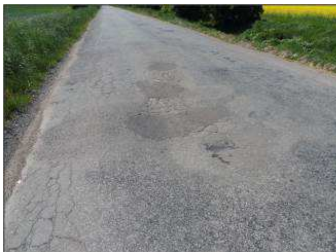
Stav před opravou
