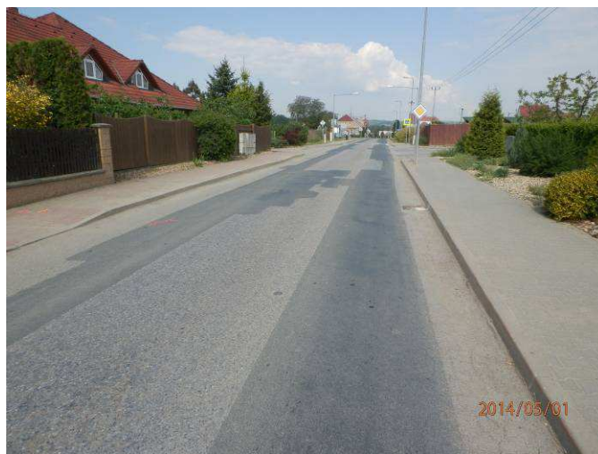
Stav před opravou
