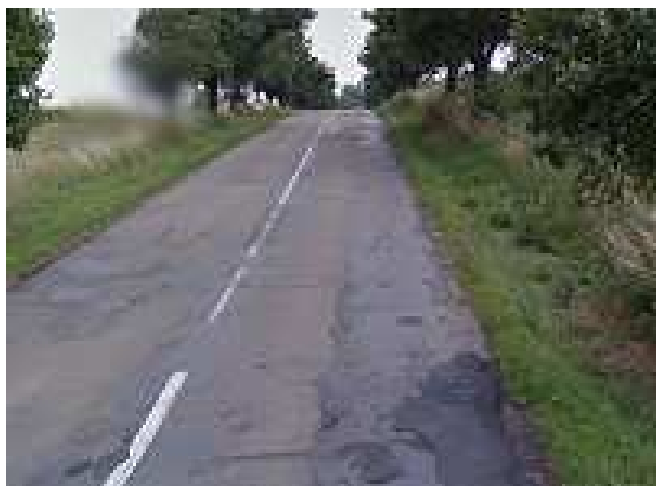
Stav před opravou
