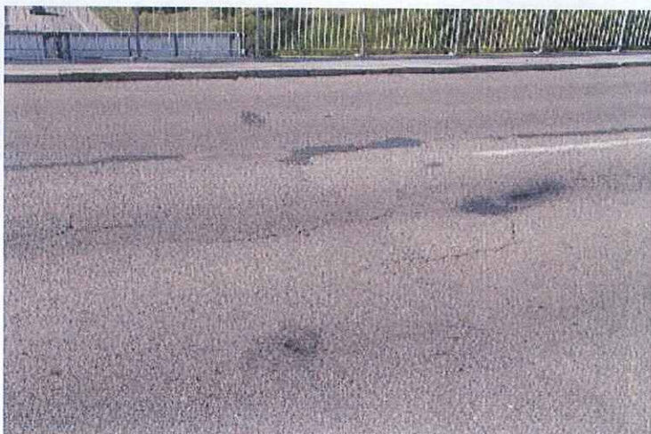
Pohled na vozovku. Příčné trhliny ve vozovce.
