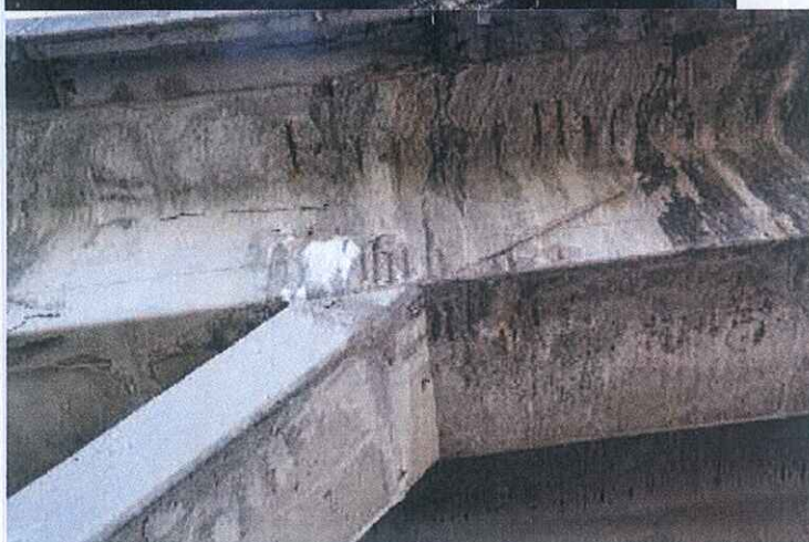
Pohled na styk vzpěry s NK, levá strana PI3.
