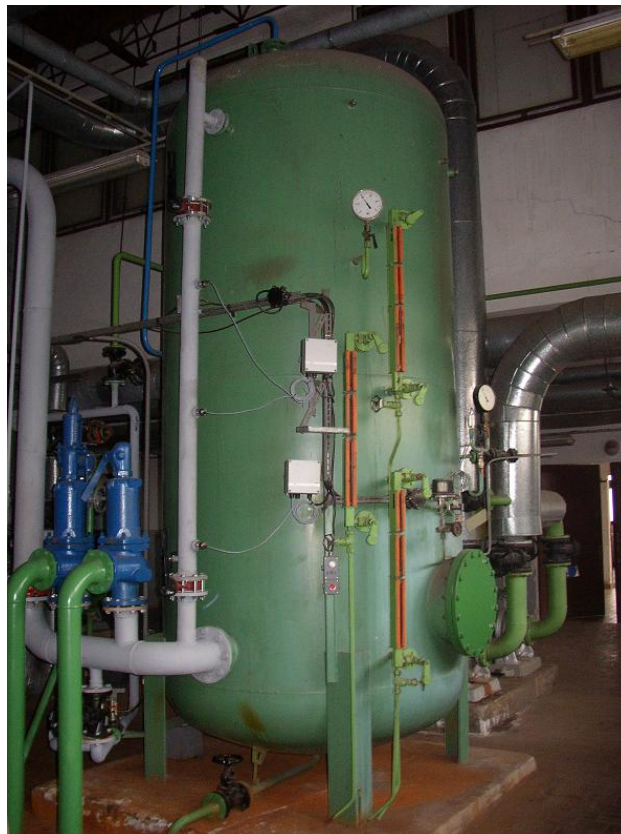
Obrázek č. 6: Stojatá expanzní nádoba v objektu Kotelny
