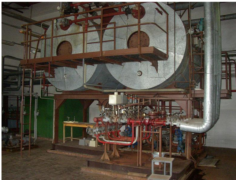
Obrázek č. 4: Napájecí jádra kotlové vody
