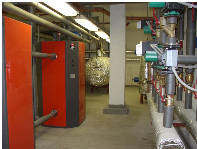
Obrázek č.12: Předávací stanice v objektu Patologie
