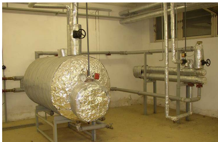
Obrázek č.11: Rychloohřev a zásob. ohřivač vody v objektu Příjmu
