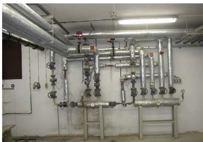
Obrázek č.13: Rozdělovač topných větví v objektu Zásobovací ústředny
