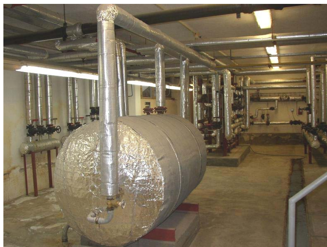
Obrázek č. 8: Předávací stanice v objektu Transfúzní stanice
