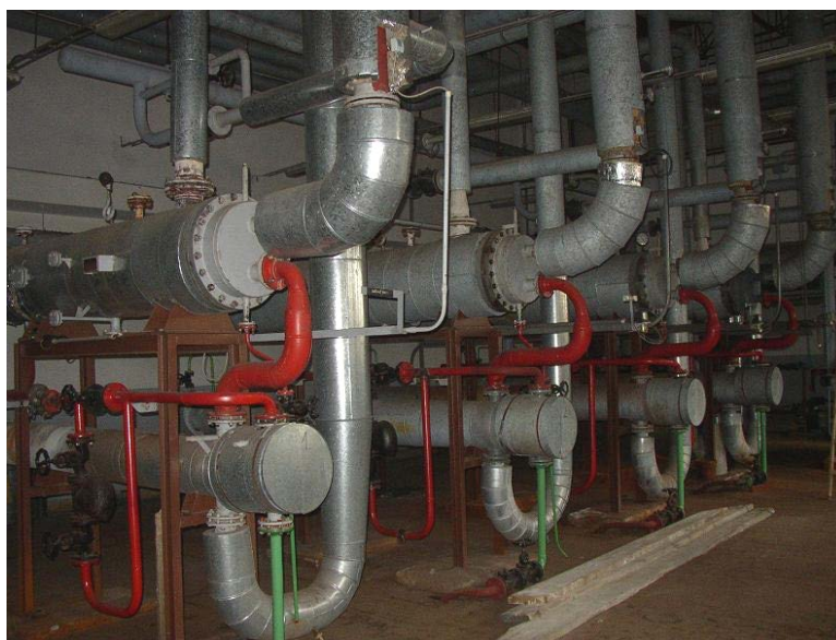
Obrázek č. 5: Výměníky tepla v kotelně
