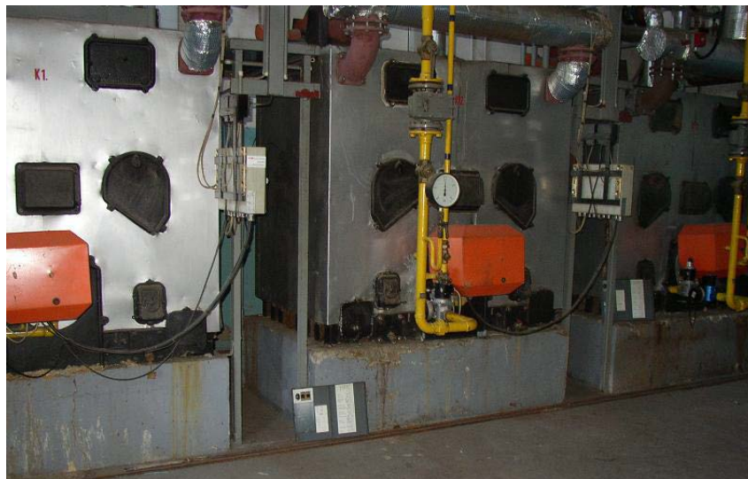
Obrázek č. 2: Kotle VSB - IV na zemní plyn
