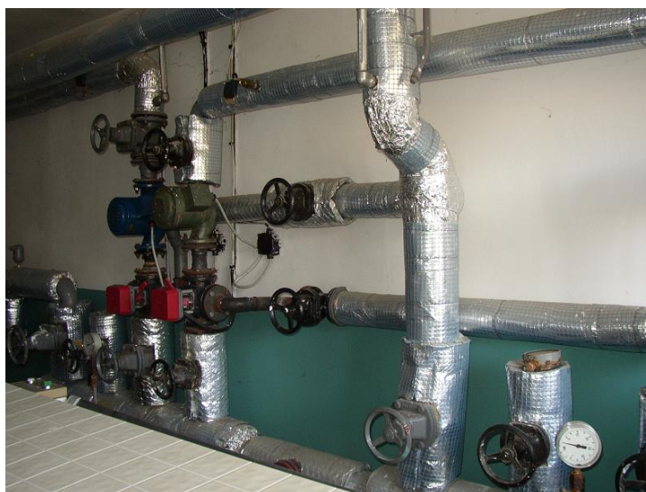
Obrázek č. 3: Rozdělovač topné vody v předávací stanici
