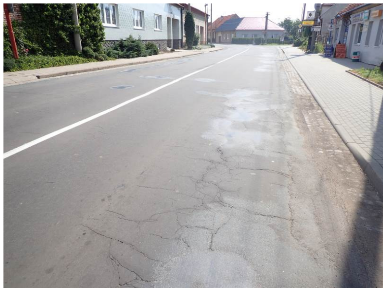
Trhliny, vysprávký (obec Šardice)
