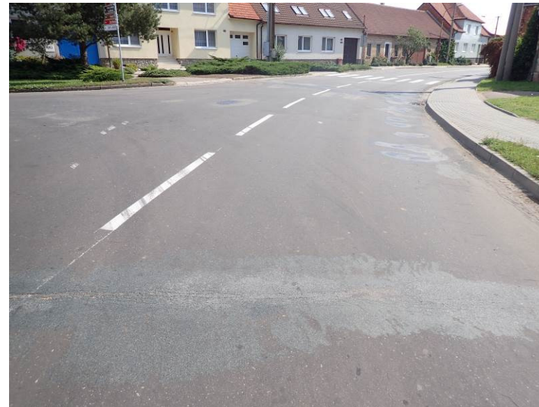
Příčné trhliny, vysprávký (obec Šardice)
