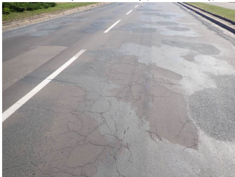
Vysprávkky, vyjeté koleje, trhliny (obec Hovorany)
