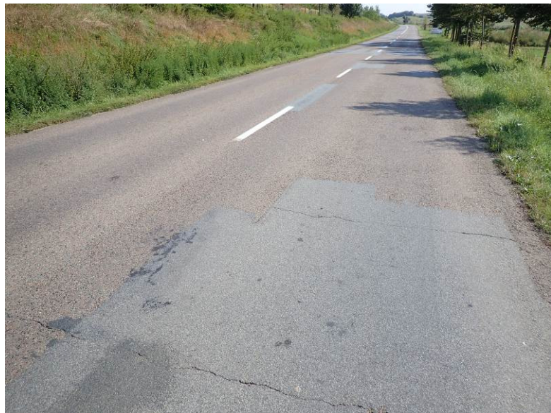
Zanedbané příkopy a krajnice (úsek Šardice – Hovorany)
