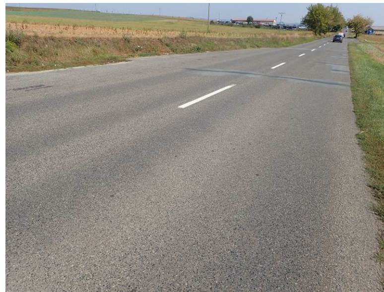
Příčné trhliny (úsek Mistřín – Šardice)
