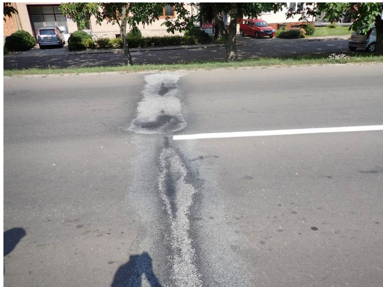
Příčná trhlina s vysprávkou (obec Šardice)
