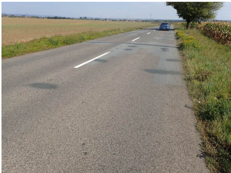
Vysprávkvy, příčná trhlina (úsek Mistřín – Šardice)
