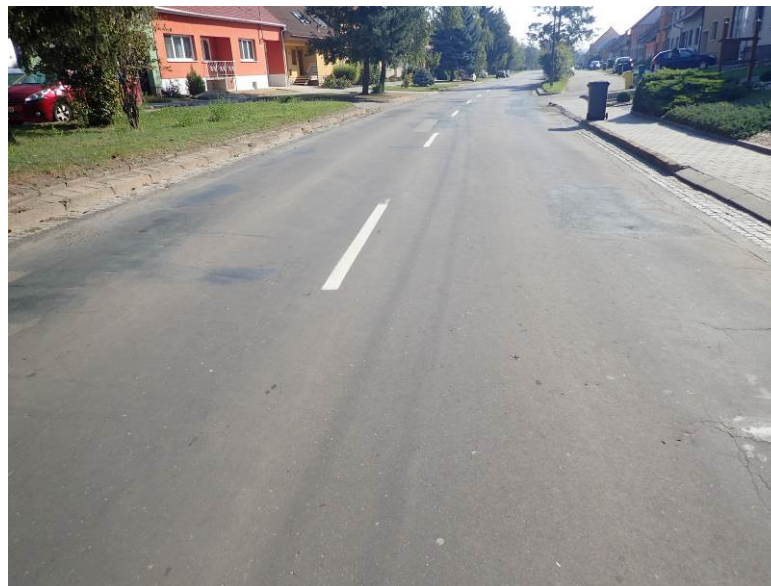
Vysprávkky, vyjeté koleje, trhliny (obec Hovorany)
