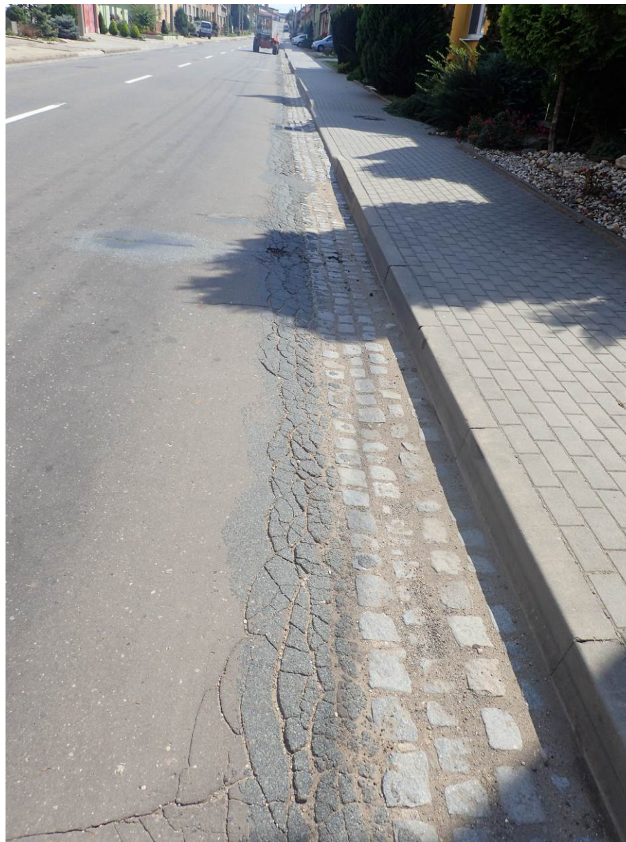
Poškozený okraj vozovky (obec Šardice)
