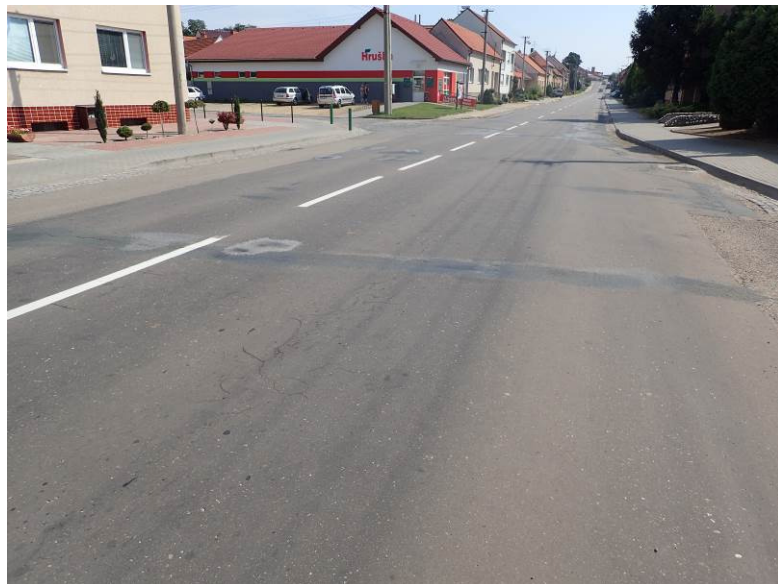
Trhliny, vysprávký (obec Šardice)
