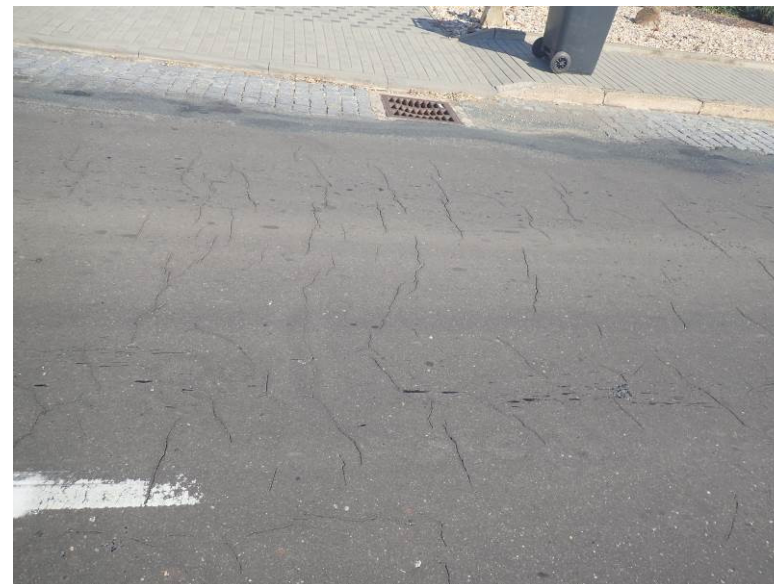
Trhliny v povrchu vozovky (obec Hovorany)
