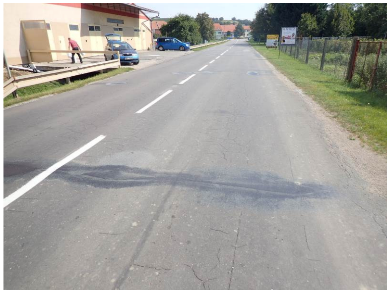
Trhliny v povrchu vozovky (obec Šardice)
