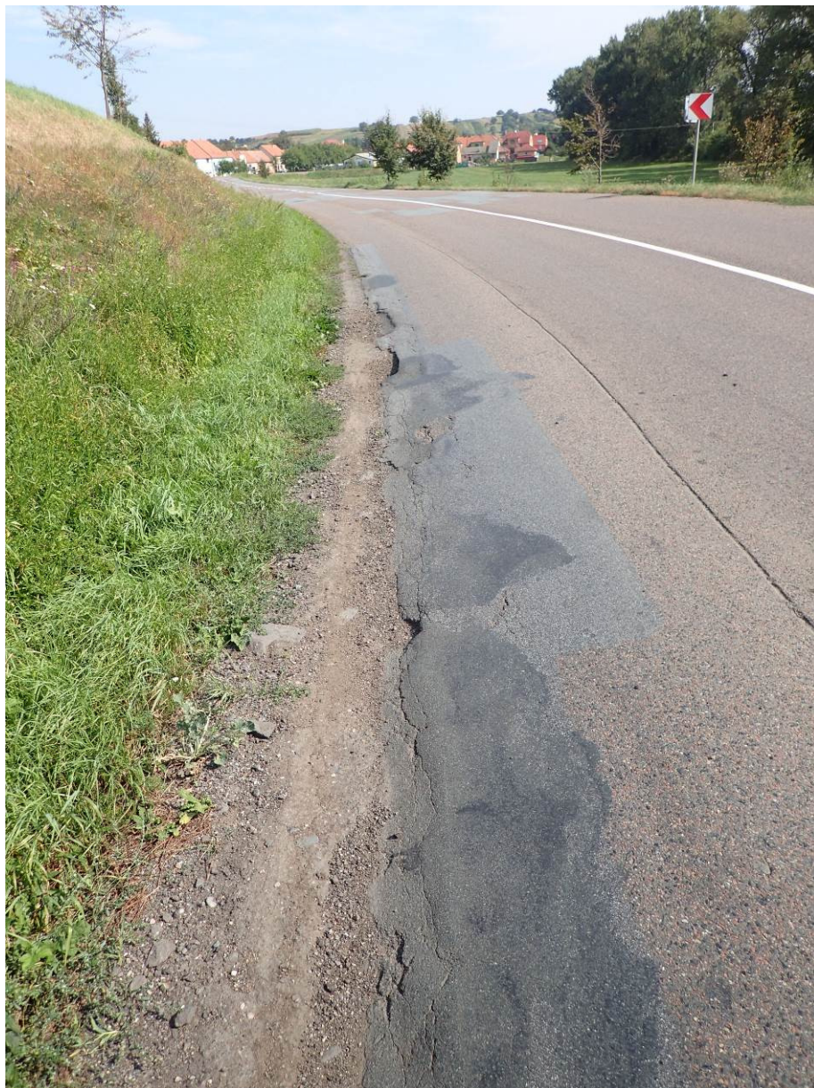
Poškozená krajnice (úsek Šardice – Hovorany)
