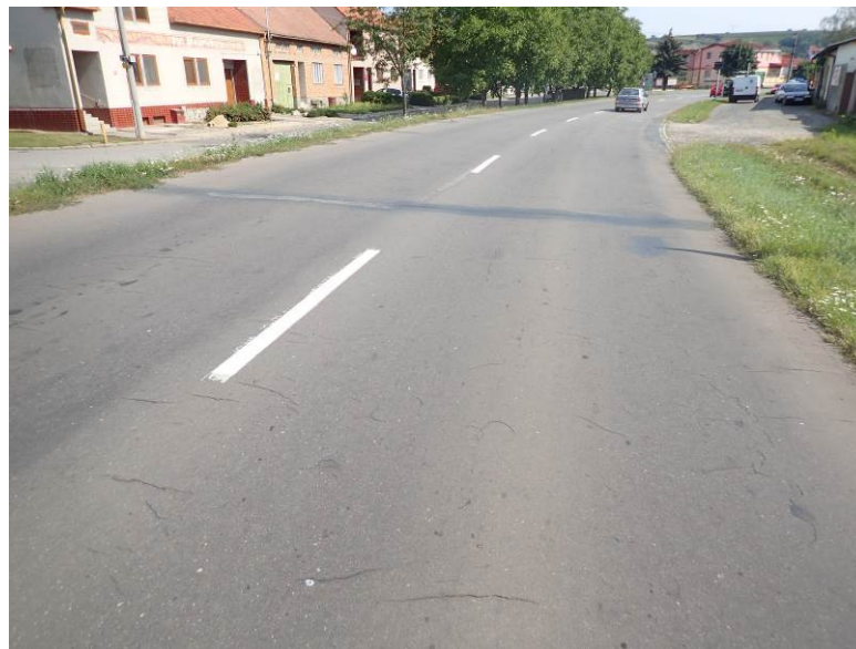
Příčná trhlina (obec Šardice)
