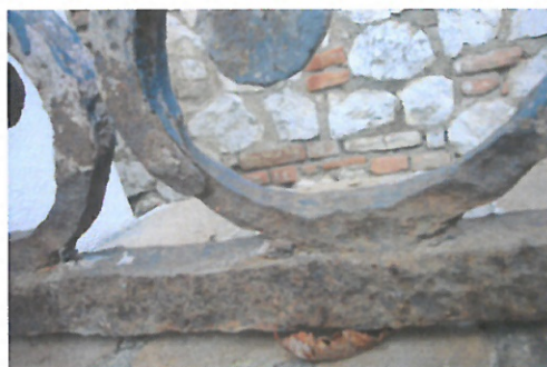
Silná koroze rámu i výplně
