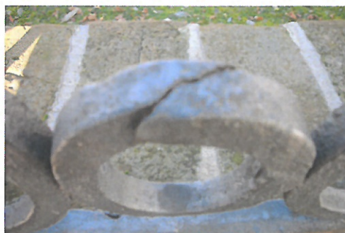
Praskliny ve spojích
