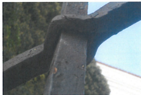
Koroze v průboji
