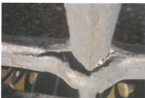
Některé průboje rozprasklé korozí
