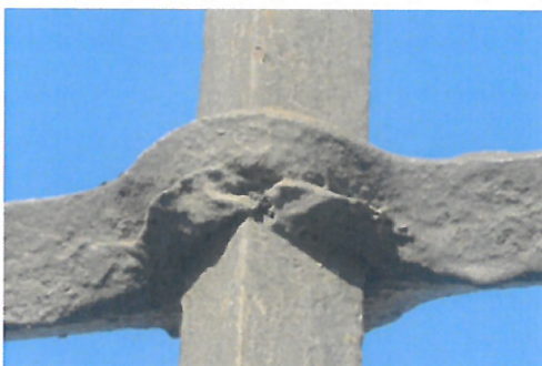
Vnitřní koroze průbojů
