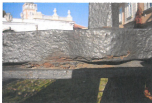
Hlubková koroze ve spojích
