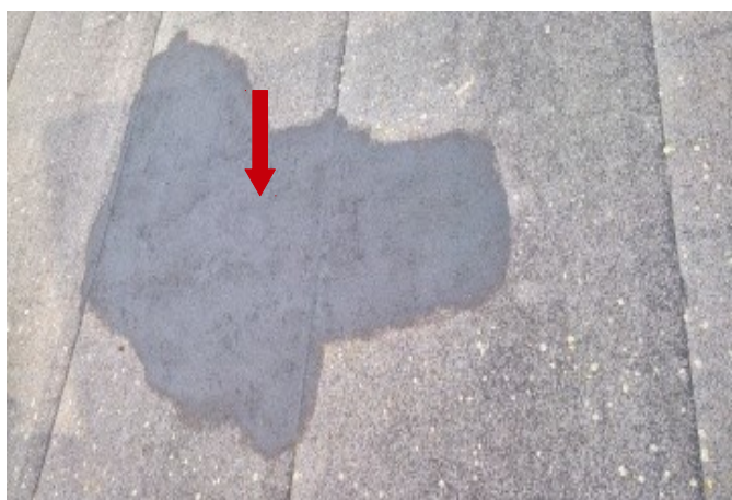
foto/38/ Pohled na poruchu hydroizolační vrstvy
