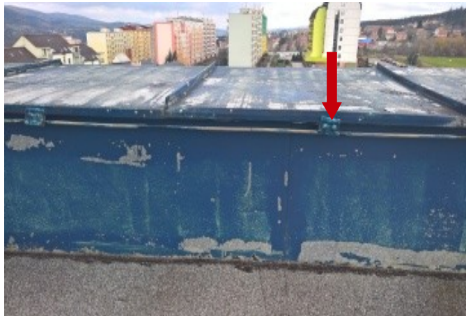
foto/72/ Pohled na uchycení ocelového lana k oplechování atiky
