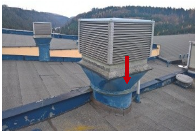
foto/52/ Pohled na napojení na prostup střechou
