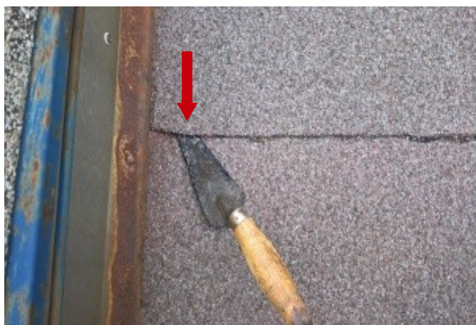
foto/12/ Pohled na netěsnost
