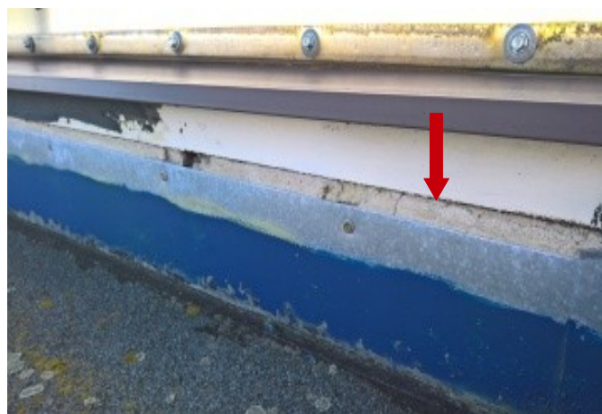
foto/69/ Pohled netěsnosti na lemování oplechování
