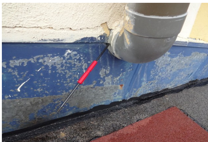
foto/60/ Pohled na netěsnost v místě oplechování větracího komínku kanalizačního potrubí
