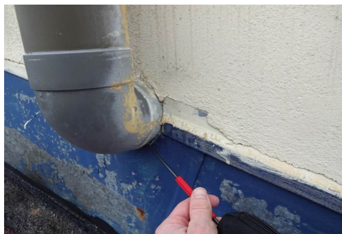
foto/61/ Pohled na netěsnost v místě oplechování větracího komínku kanalizačního potrubí
