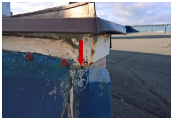
foto/68/ Pohled na netěsnosti lemování oplechování
