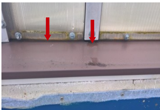
foto/65/ Pohled na napojení oplechování, netěsnost, stojící voda
