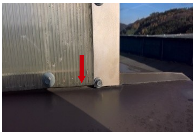
foto/64/ Pohled na napojení světlíku a oplechování, netěsnost
