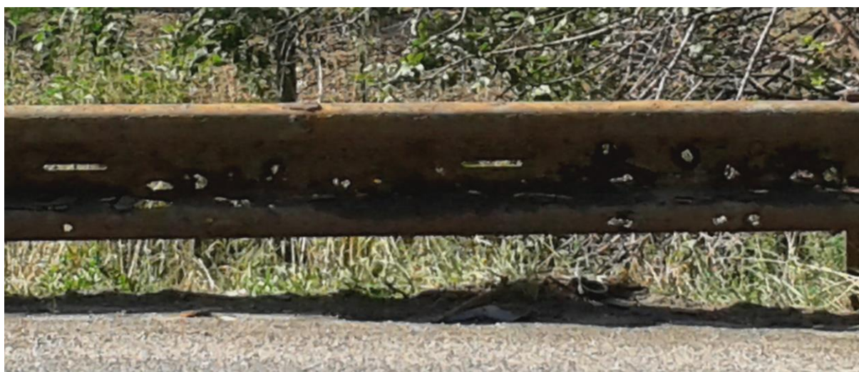
Obrázek 2: Ocelová svodidla – havarijní stav
