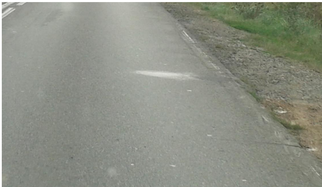
Obrázek 7: Výškový rozdíl mezi zpevněnou a nezpevněnou krajnicí.
