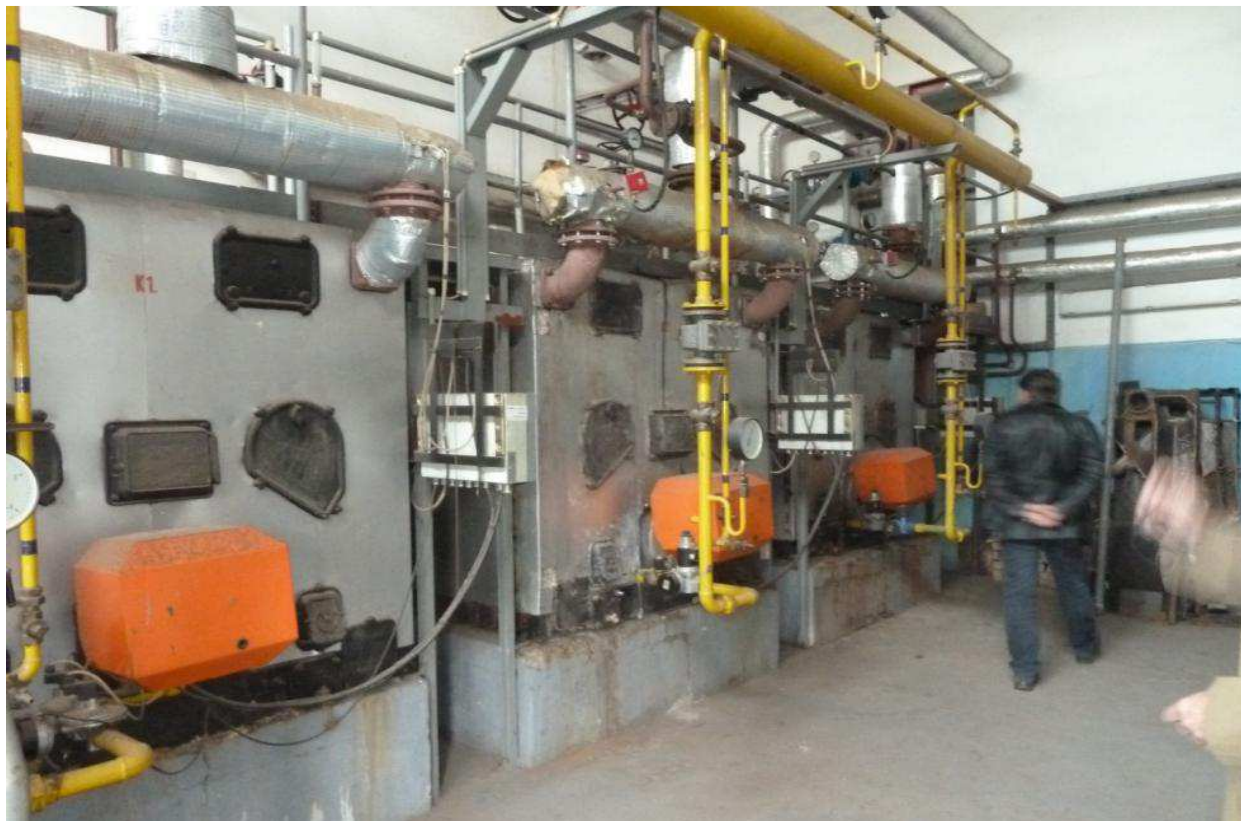
Obrázek 8: Ubytovna - Kotelna zásobující ubytovnu
