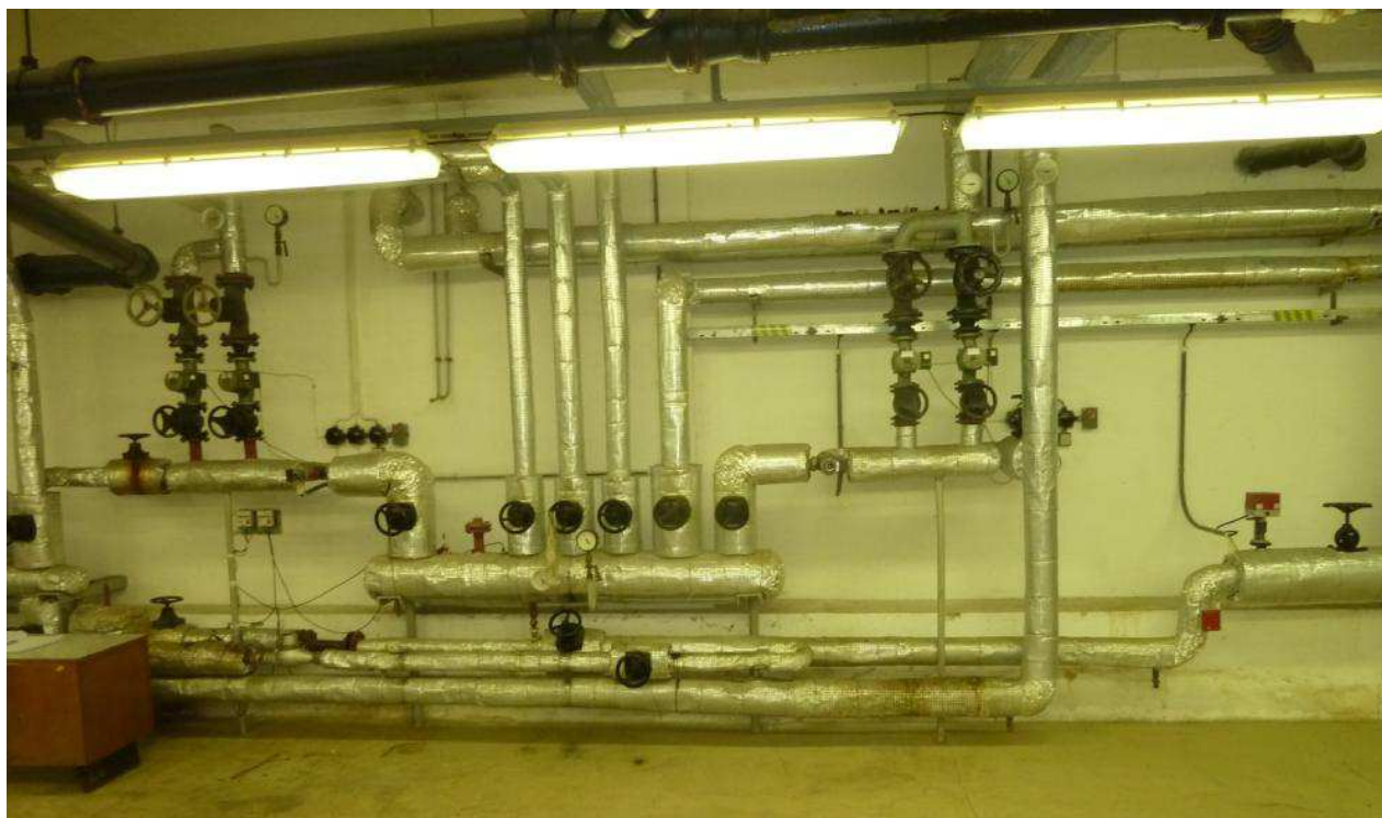
Obrázek 4: Předávací stanice pavilon D – rozdělovač síťové vody
