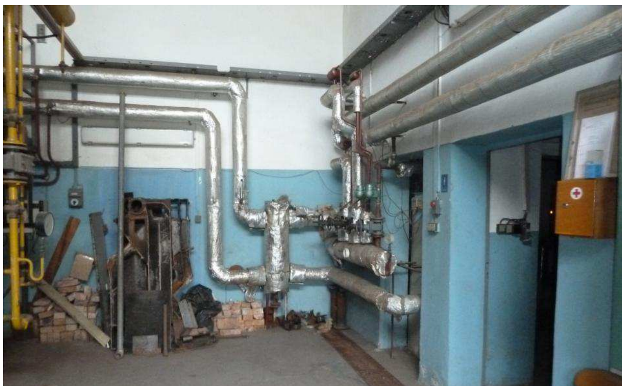
Obrázek 9: Ubytovna - rozdělovač a sběrač topné vody
