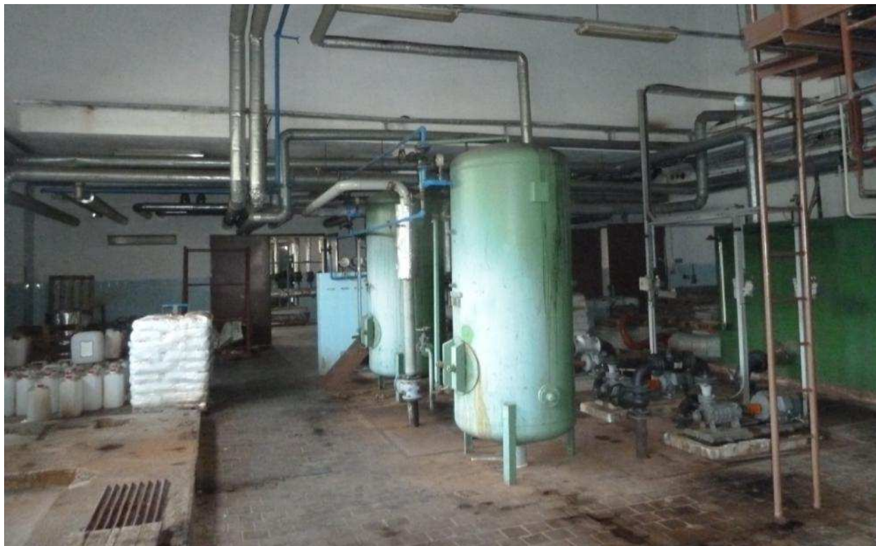
Obrázek 3: Kotelna - Tlakové nádoby změkčené upravené vody pro VZT
