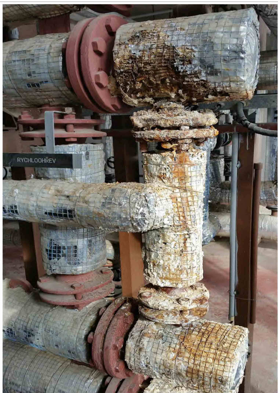
Obrázek 7: Předávací stanice pavilon C – současný stav rychloohřevů
