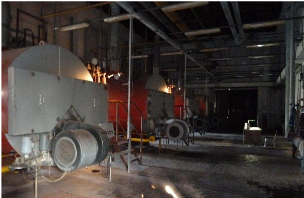
Obrázek 1: Kotelna pro areál nemocnice
