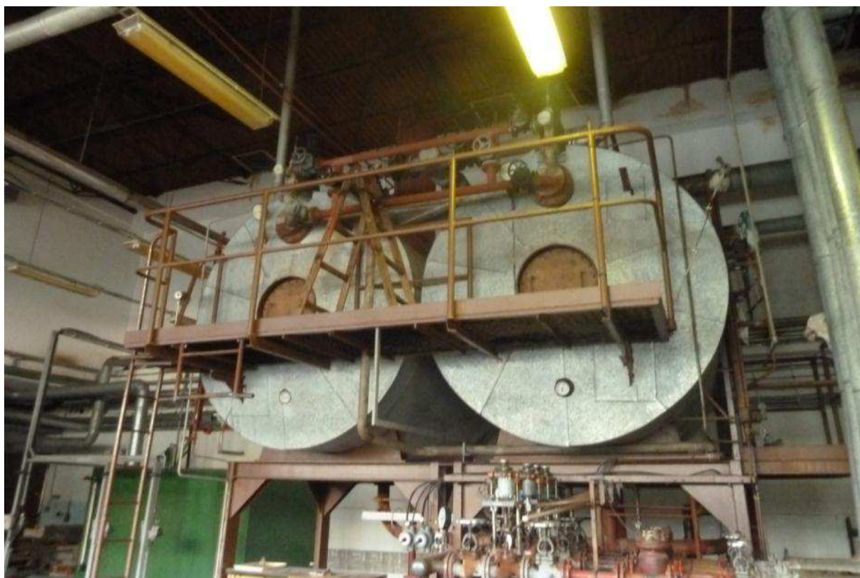
Obrázek 2: Kotelna – Napájecí jádra kotlové vody
