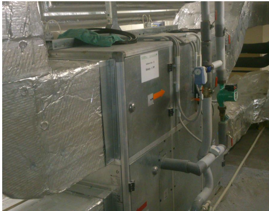
Foto č.4 VZT jednotka s izolací rozvodů vzduchu
