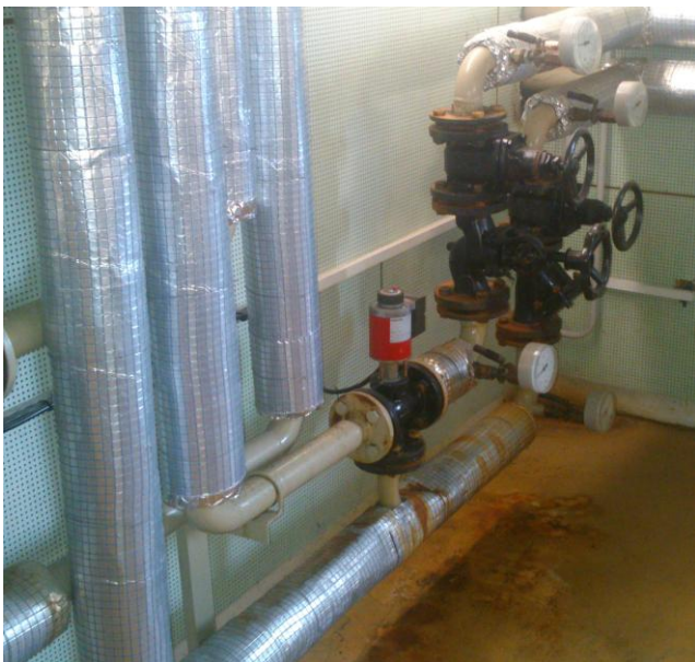
Foto č.4 Rozvody chladu u VZT jednotek
