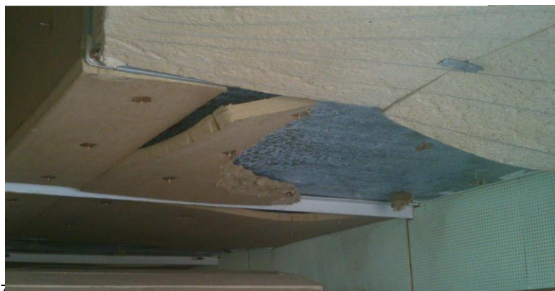
Foto č.4 Rozvody VZT- poškozená a nedostatečná tep.izolace, vliv kondenzace
