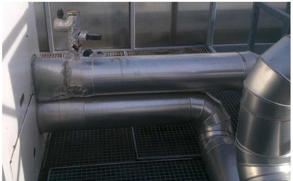
Foto č.2 Venkovní rozvody chladu s vyhovující tepelnou izolací
