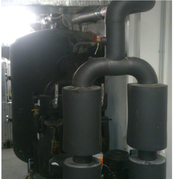
Foto č.3 Rozvody chladu s akumulací nádobou
