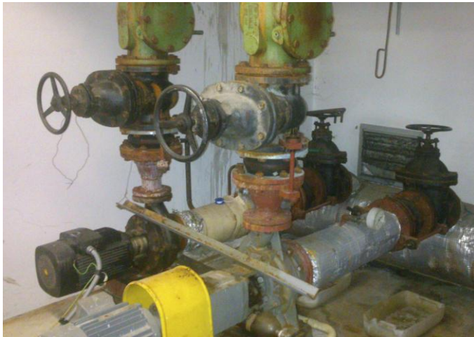
Foto č.5 Čerpadla chladicího média, armatury bez tepelné izolace
