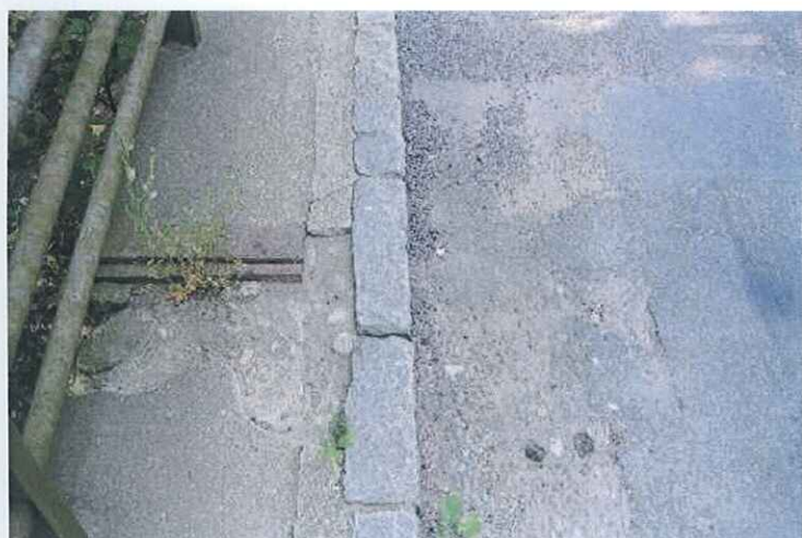
rozpad betonu v okolí dilatace vpravo
