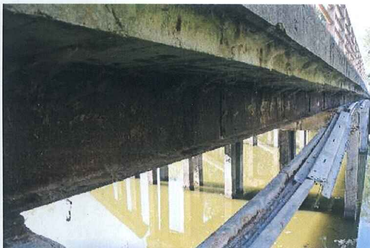
šupinová koroze krajního ocelového nosníku vlevo
