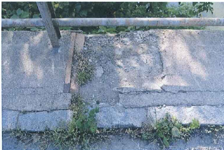
chodník vpravo v okolí DZ - rozpad betonu
