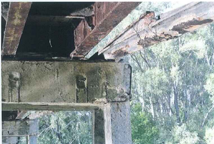
obnažená výztuž a eroze betonu úložného prahu podpěry VI vlevo
