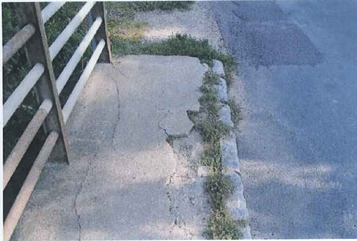
rozpad betonu chodníku vpravo nad opěrou I
