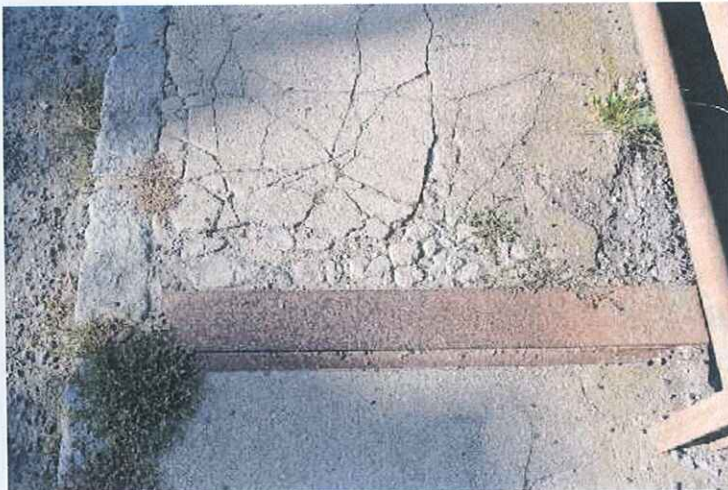
popraskaný a rozpadající se beton v okolí chodníkové dilatace
