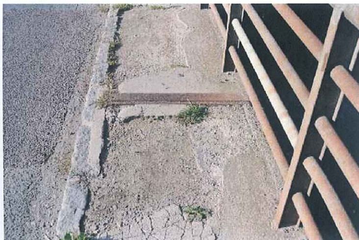
rozpad povrchu chodníku vlevo
