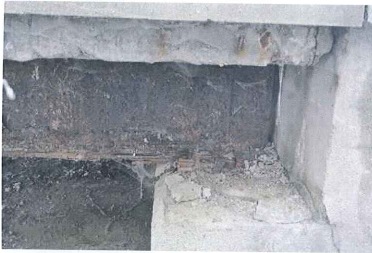
opěra I vlevo - silná šupinová koroz krajního ocelového nosníku
