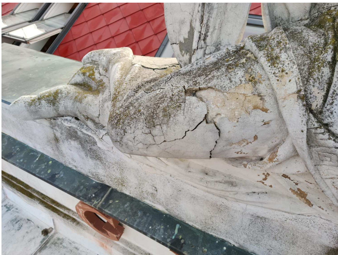
Detail poškození a prasklin levé sochy.
