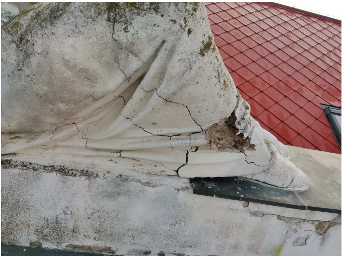
Detail poškození a prasklin na pravé soše.
