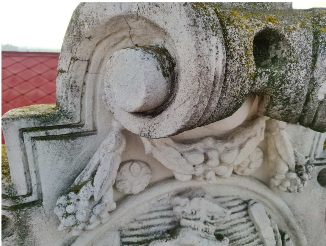
Detail poškození a nevhodného tmelu, horní část erbu.
