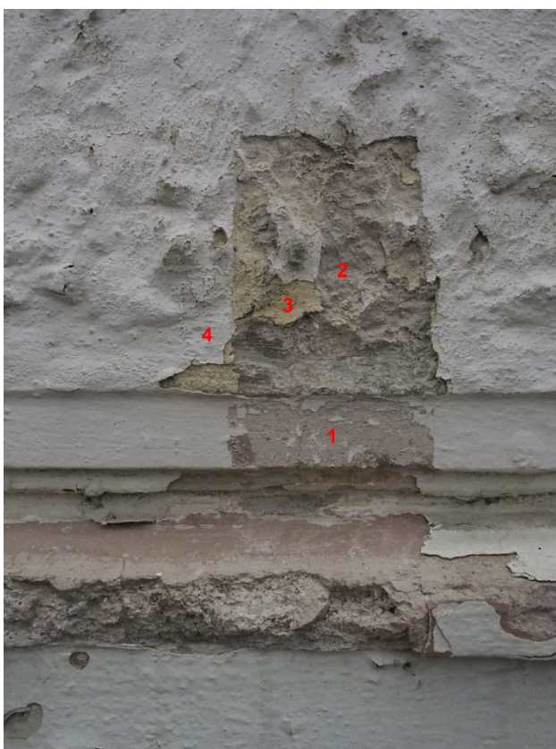
Fasáda severozápadního průčelí. 1, 2 – vrchní omítková vrstva, 3 – nejstarší barevný nátěr, 4 – současný barevný nátěr.
