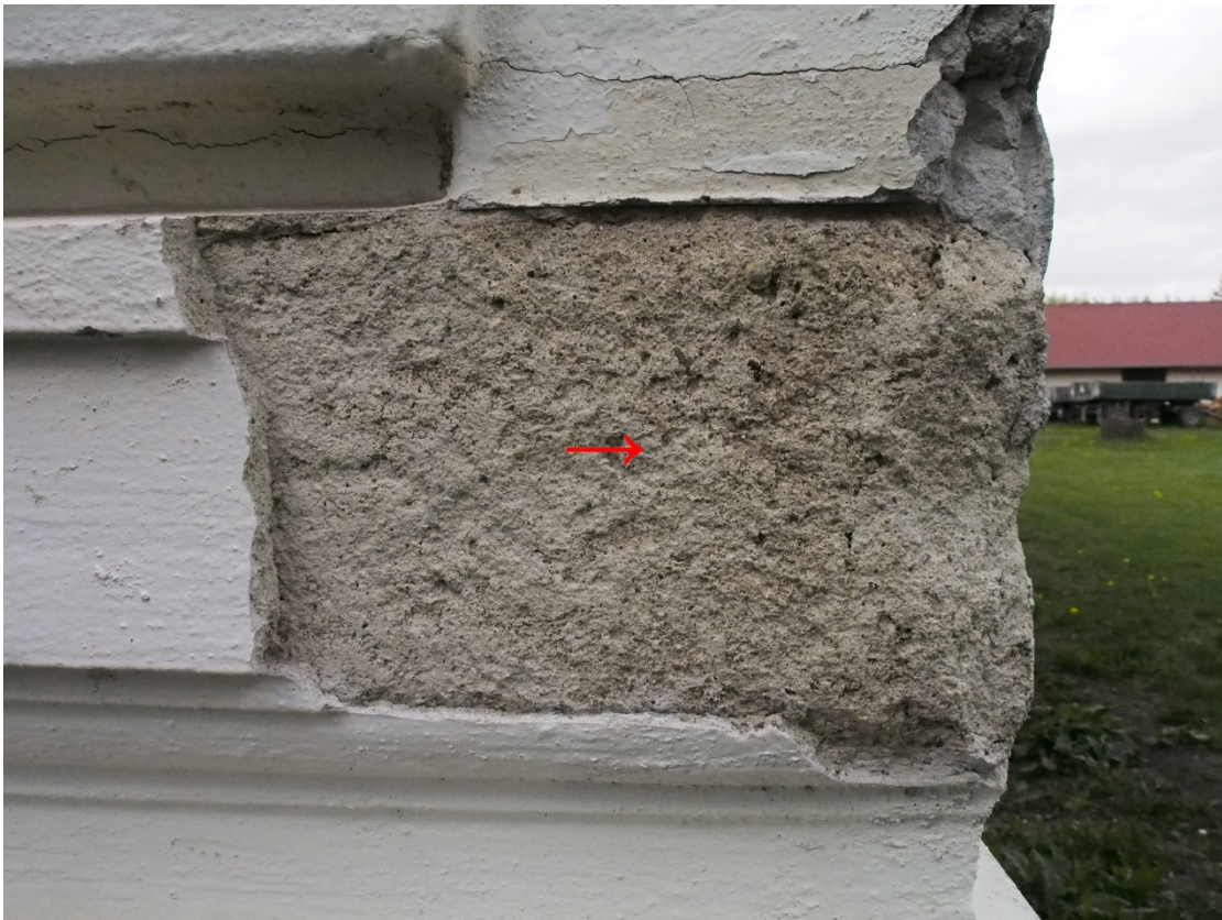
Fasáda jihovýchodního průčelí. Šipka ukazuje jádrovou omítkovou vrstvu.
