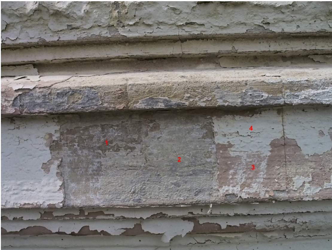
Fasáda jihovýchodního průčelí. 1 – štuková omítková vrstva, 2 – nejstarší barevný nátěr, 3 – mladší barevný nátěr, 4 – mladší barevný nátěr.
