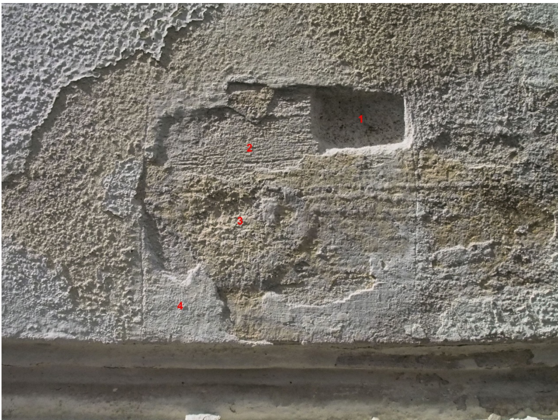
Fasáda jihovýchodního průčelí. 1 – jádrová omítková vrstva, 2 – vrchní omítková vrstva, 3 – nejstarší barevný nátěr, 4 – současný barevný nátěr.
