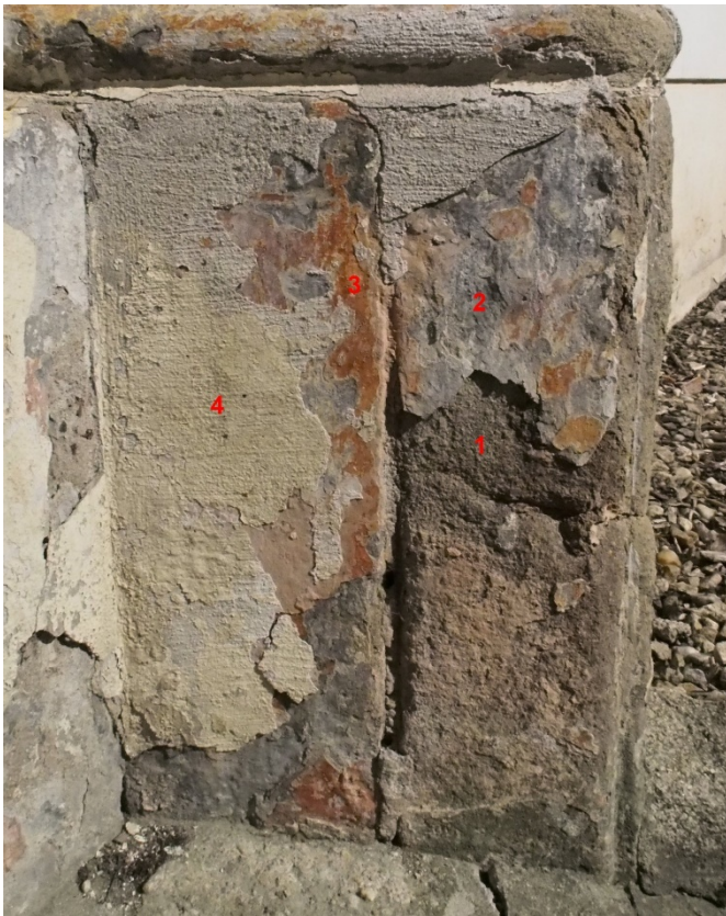
Fasáda jihozápadního průčelí. 1 – kámen, 2 – štuková omítková vrstva, 3 – nejstarší barevný nátěr, 4 – současný barevný nátěr.
