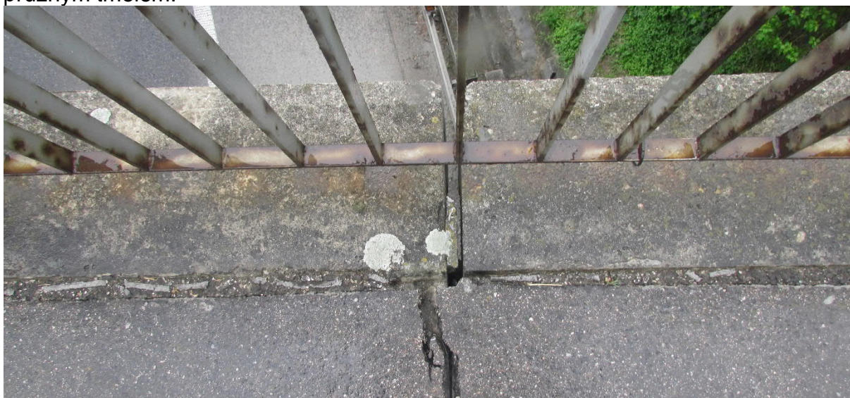
Obr. 6 – Spára mezi římsovými prefabrikáty na pravé straně mostu
