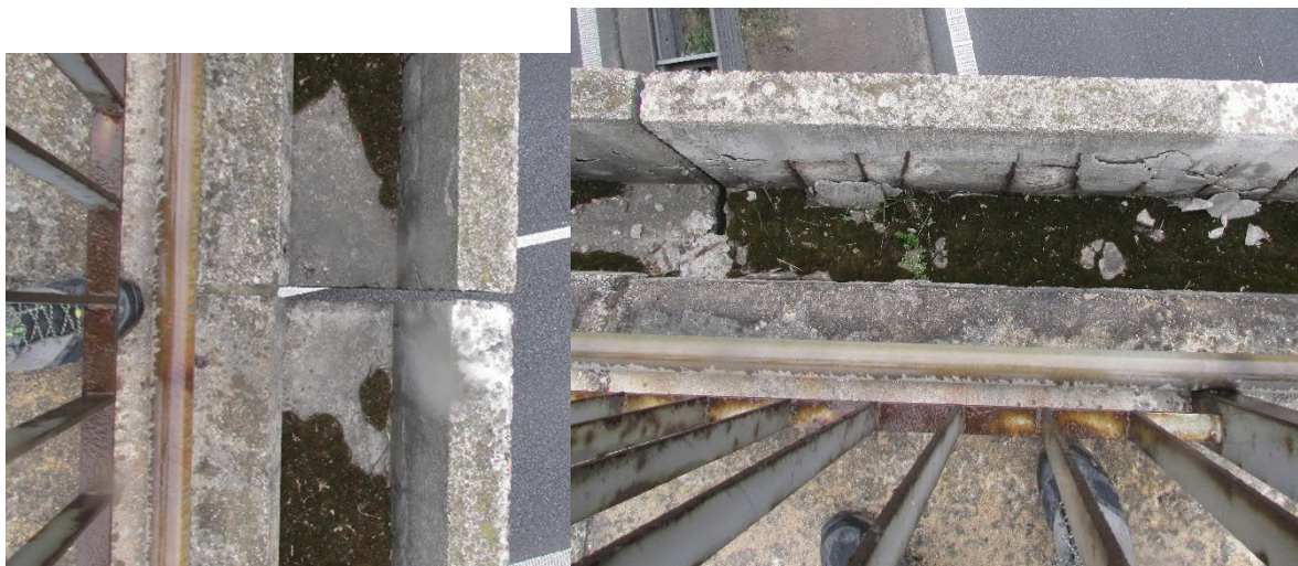
Obr. 4 a 5 – Spáry mezi prefabrikáty římsy a žlabu, zanesený žlab
