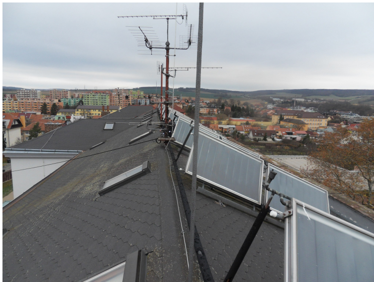
Střešní plocha, solární termické panely
