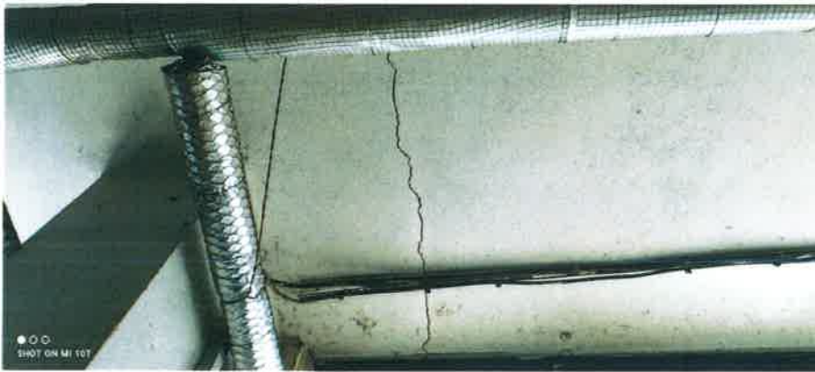
Obr. 12 – ve stropní konstrukci se rozevírají styčné spáry mezi stropními panely a průvlakem ŽB skeletu
