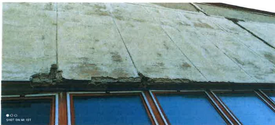
Obr. 7 – pohled na západní fasádu kotelny – detail poruch na obvodových konstrukcích
