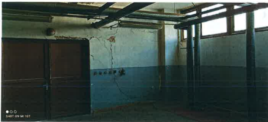
Obr. 14 – trhliny ve vnitřních stěnách v 1. NP
