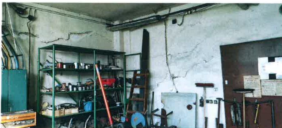
Obr. 15 – trhliny ve vnitřních stěnách v 1. NP
