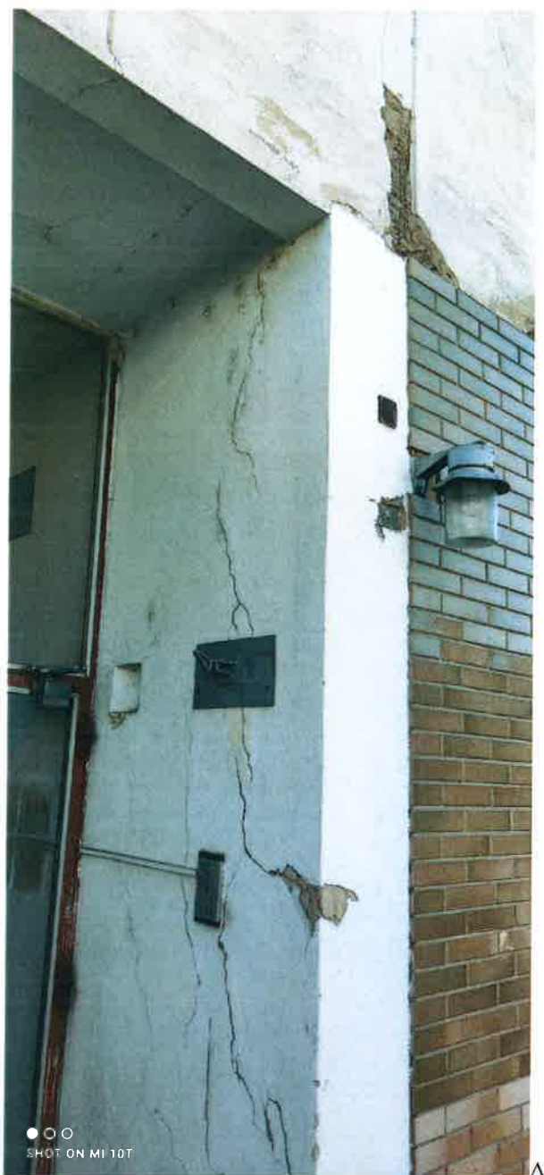
Obr. 17 – trhliny ve stěnách u vstupu do objektu
