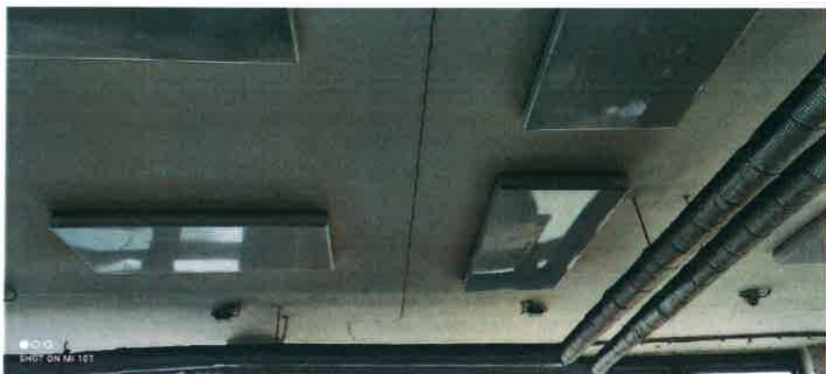
Obr. 11 –ve stropní konstrukci se rozevírají styčné spáry mezi stropními panely ŽB skeletu
