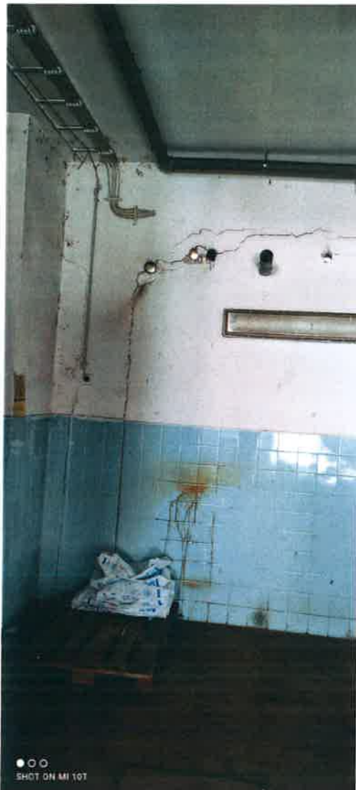
Obr. 13 – trhliny ve vnitřních stěnách v 1. NP
