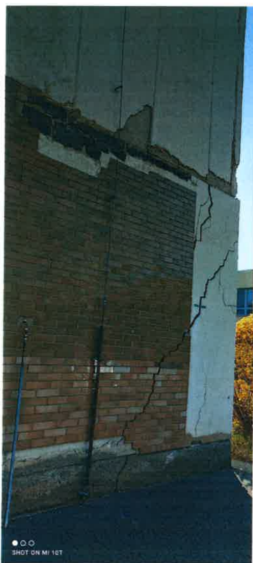
Obr. 8 – pohled na západní fasádu kotelny – detail poruch na obvodových konstrukcích
