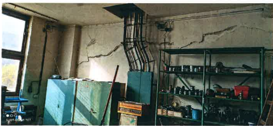
Obr. 10 – poruchy na trhliny ve stěnách v 1. NP vlivem nerovnoměrného sedání
