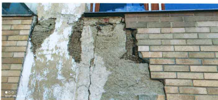
Obr. 6 – pohled na západní fasádu kotelny – detail poruch na obvodových konstrukcích
