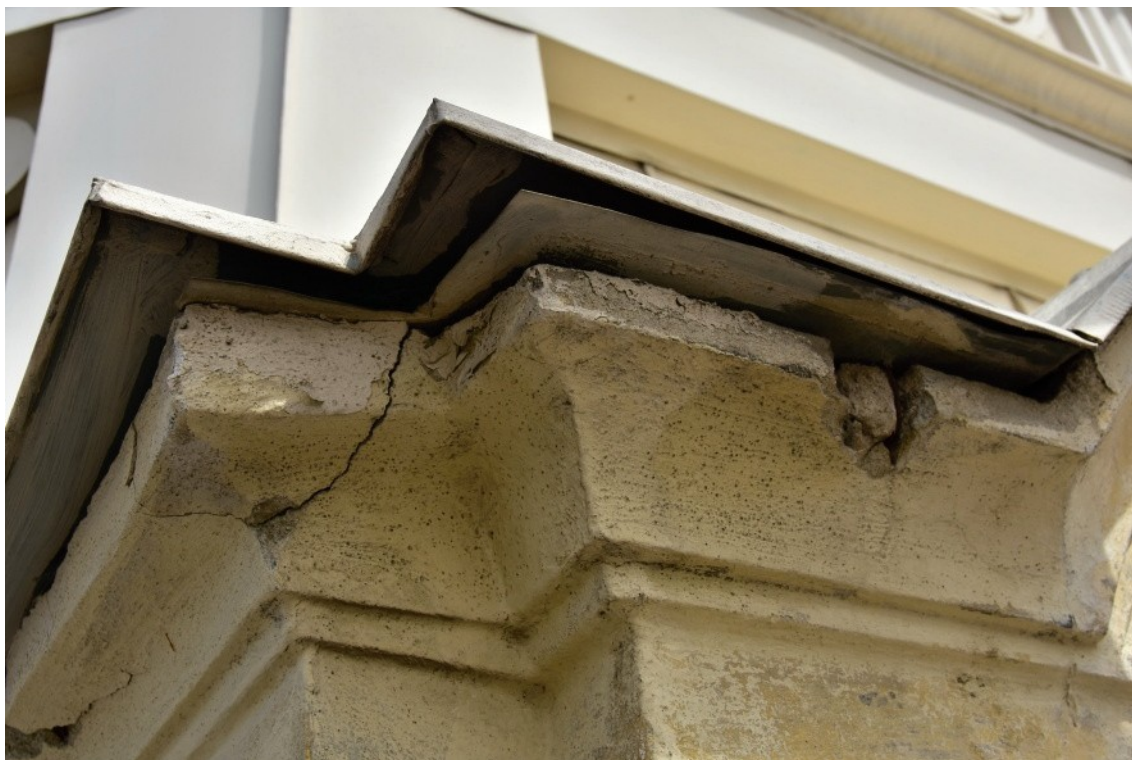
levý horní roh římse – detail poškození
