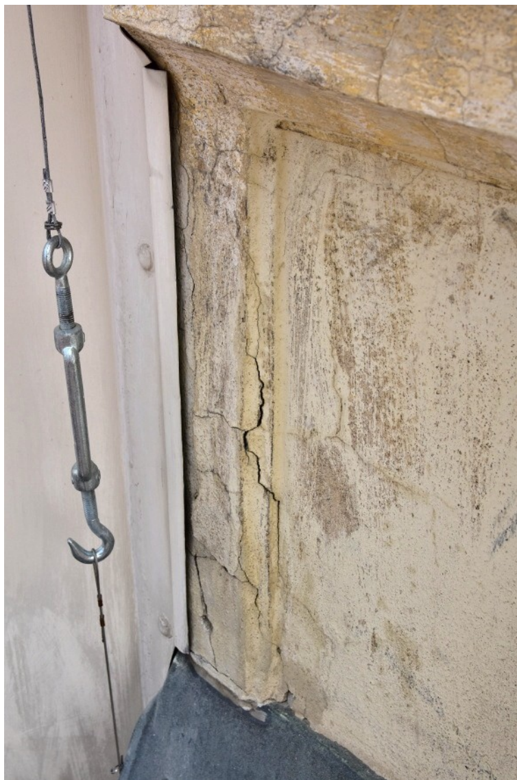
degradace a praskliny – levá spodní část architektury přiléhající k oplechování věže
