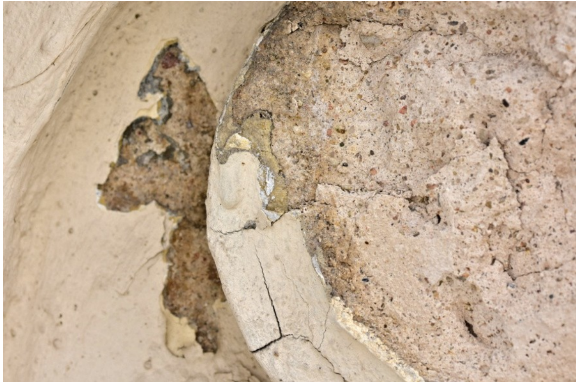
detail poškození voluty pod korunou
