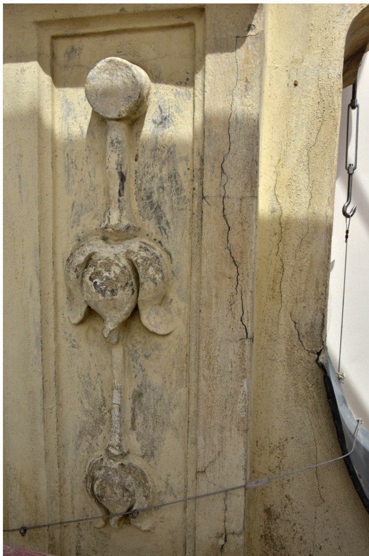
detail pravého pilastru – praskliny
