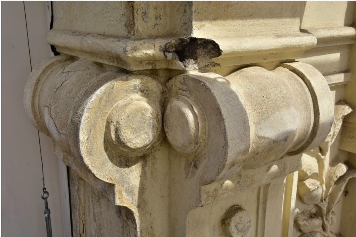
levý horní roh s volutami – mechanická poškození, praskliny, sekundární opravy
