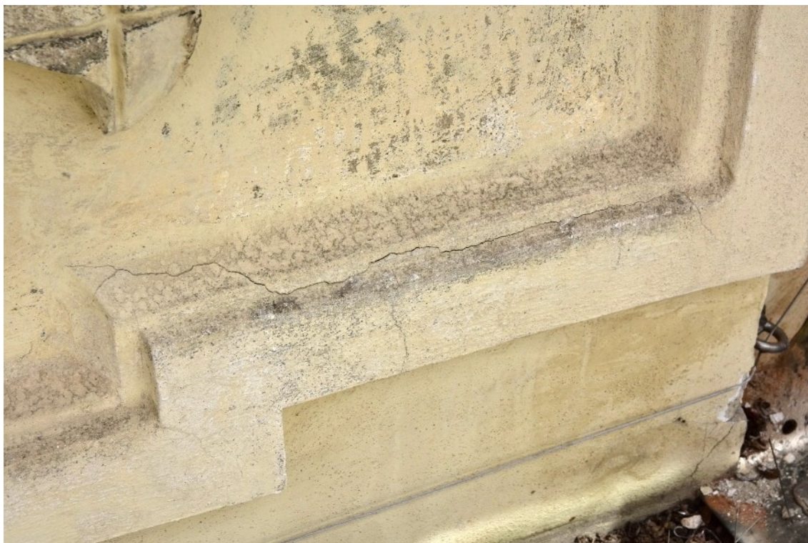
prasklina – pravý dolní roh rámu kartuše
