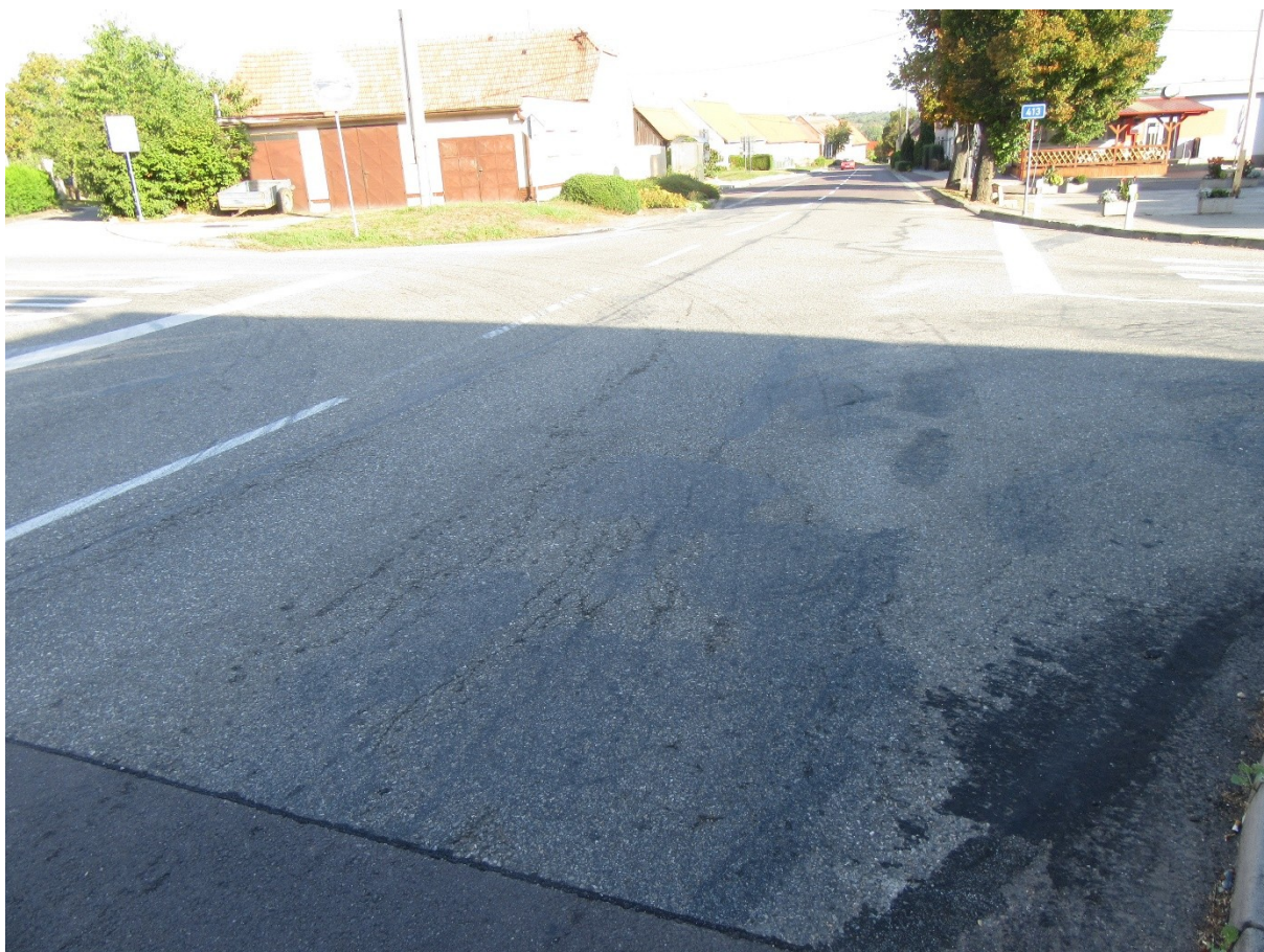
Foto 08 Podélné a nepravidelné rozvětvené trhliny, místy ošetřené zálivkou či tryskovými vysprávkami, ztráta asfaltového tmelu, hloubková koroze, vysprávkky.
