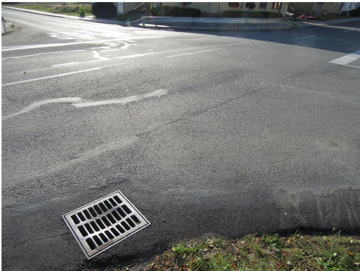
Foto 04 Podélné a nepravidelné rozvětvené trhliny, místy ošetřené zálivkou, ztráta asfaltového tmelu, hloubková koroze, vysprávkky.
